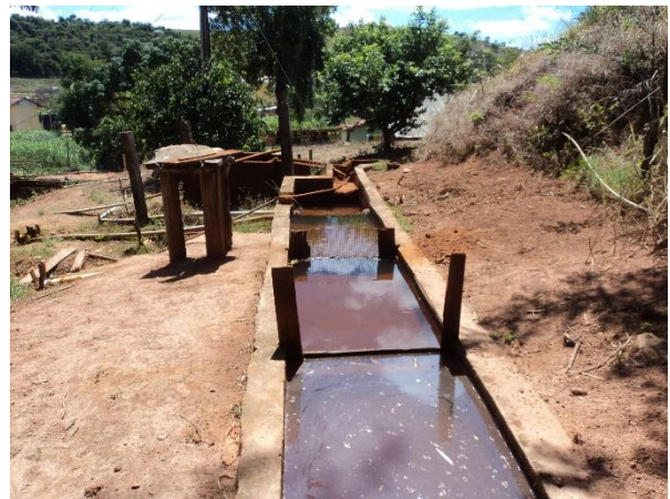
FIGURA 5 – CAPTAÇÃO SUPERFICIAL CÓRREGO DO MAMÃO (VISTA 2) (FONTE: ACERVO DO AUTOR, 2014)
