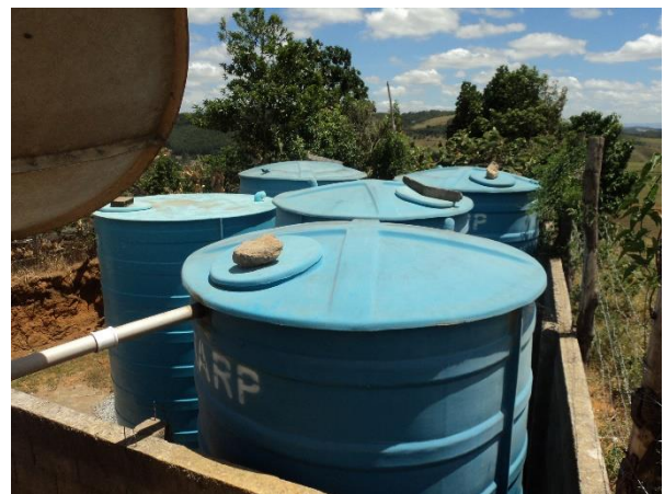
FIGURA 18 – RESERVATÓRIOS DE FIBRA DE VIDRO (FONTE: ACERVO DO AUTOR, 2014)
