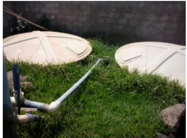
FIGURA 15 – RESERVAÇÃO R1 E R2 (FONTE: ACERVO DO AUTOR, 2014)
