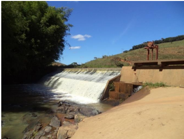
FIGURA 5 - CAPTAÇÃO (VISTA 1) (FONTE: ACERVO DO AUTOR, 2014)
