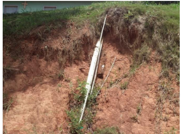
FIGURA 49 - LANÇAMENTO DE ESGOTO NA LOCALIDADE DE APARECIDA (VISTA 2) (FONTE: ACERVO DO AUTOR, 2014)
