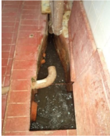
FIGURA 7 - CALHA PARSHALL (FONTE: ACERVO DO AUTOR, 2014)
