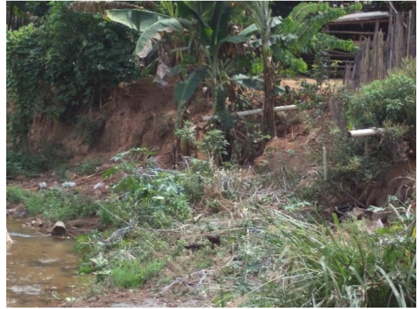
FIGURA 47 - LANÇAMENTO DE ESGOTO NA LOCALIDADE DE BARROSO (FONTE: ACERVO DO AUTOR, 2014)
