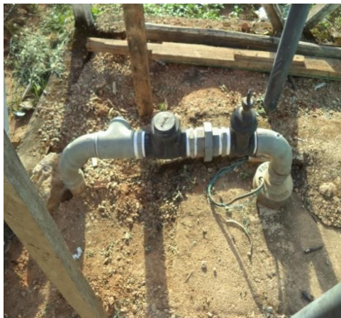
FIGURA 25 - POÇO 1 DA LOCALIDADE DE GRANADA (FONTE: ACERVO DO AUTOR, 2014)
