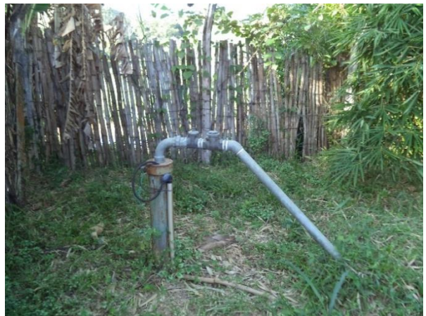
FIGURA 26 - POÇO 2 DA LOCALIDADE DE GRANADA (FONTE: ACERVO DO AUTOR, 2014)
