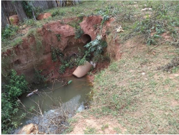
FIGURA 46 - LANÇAMENTO DE ESGOTO NA LOCALIDADE DE BARROSO (FONTE: ACERVO DO AUTOR, 2014)
