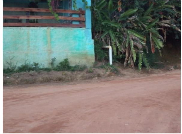
FIGURA 45 - TUBULAÇÃO EXPOSTA DE ESGOTO NA LOCALIDADE DE SANTA EFIGÊNIA (FONTE: ACERVO DO AUTOR, 2014)
