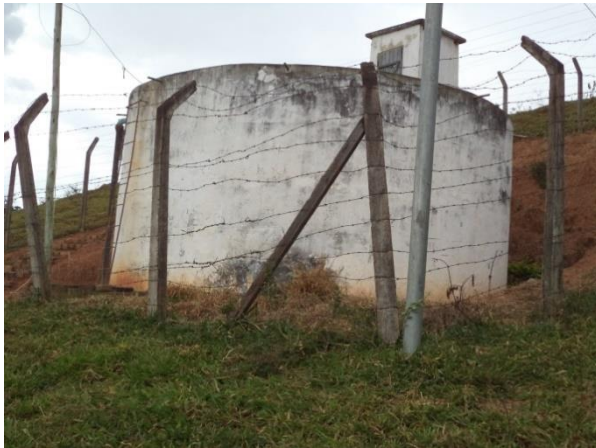
FIGURA 36 - SISTEMA DE TRATAMENTO E RESERVAÇÃO BICUÍBA (VISTA 1) (FONTE: ACERVO DO AUTOR, 2014)
