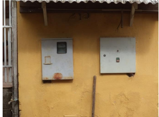
FIGURA 65 - EEE 1 (VISTA 2) (FONTE: ACERVO DO AUTOR, 2014)
