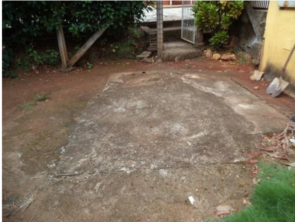
FIGURA 64 - EEE 1 (VISTA 1) (FONTE: ACERVO DO AUTOR, 2014)
