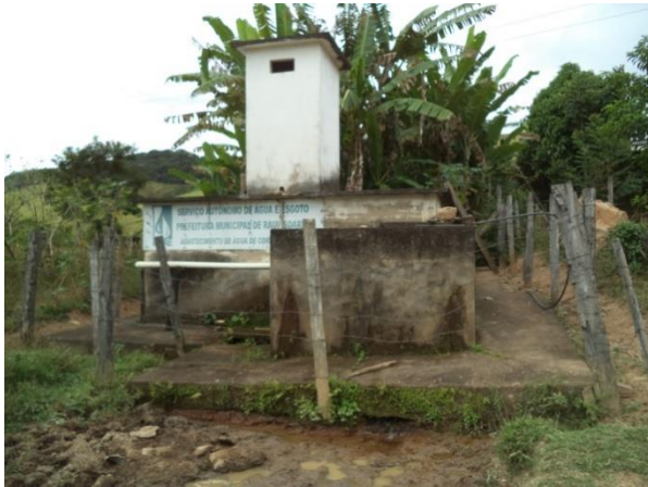
FIGURA 58 - RESERVAÇÃO DE ÁGUA BRUTA CORNÉLIO ALVES (FONTE: ACERVO DO AUTOR, 2014)
