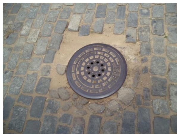
FIGURA 61 - REDE COLETORA (VISTA 2) (FONTE: ACERVO DO AUTOR, 2014)
