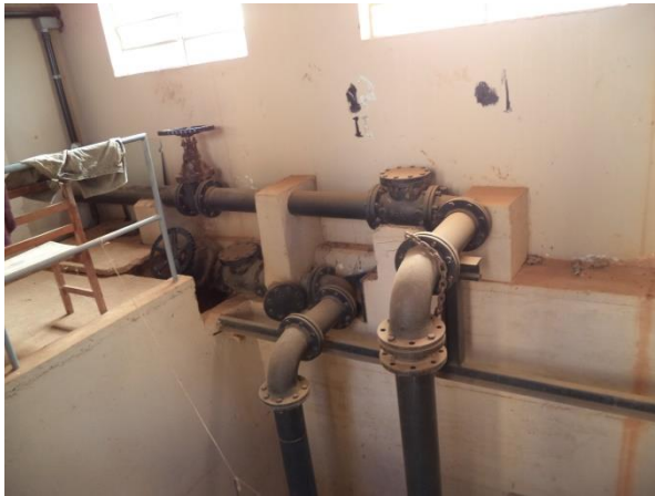
FIGURA 8 - EEAB - ADUTORAS DE ÁGUA BRUTA (FONTE: ACERVO DO AUTOR, 2014)
