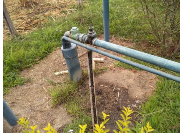
FIGURA 35 - CAPTAÇÃO BICUÍBA (VISTA 2) (FONTE: ACERVO DO AUTOR, 2014)
