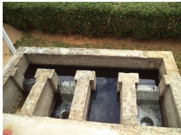
FIGURA 69 - ETE DISTRITO DE BICUÍBA (VISTA 2) (FONTE: ACERVO DO AUTOR, 2014)
