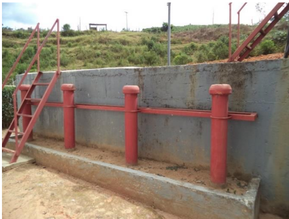
FIGURA 70 - ETE DISTRITO DE BICUÍBA (VISTA 3) (FONTE: ACERVO DO AUTOR, 2014)
