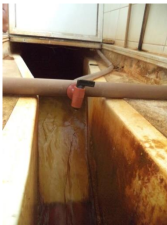
FIGURA 10 - ETA (VISTA 1) (FONTE: ACERVO DO AUTOR, 2014)
