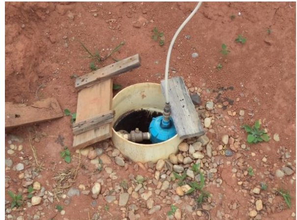
FIGURA 44 - SISTEMA DE TRATAMENTO E RESERVAÇÃO SÃO SEBASTIÃO DO ÓCULO (VISTA 2) (FONTE: ACERVO DO AUTOR, 2014)
