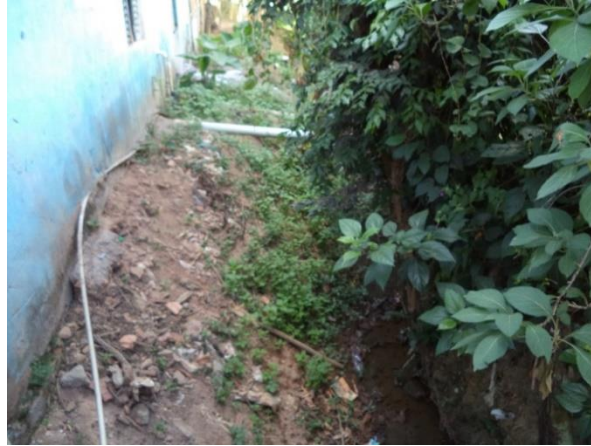
FIGURA 74 - ESGOTO DOMICILIAR - DISTRITO DE SANTANA DO TABULEIRO (FONTE: ACERVO DO AUTOR, 2014)
