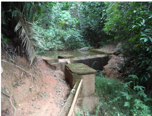
FIGURA 50 - CAPTAÇÃO CÓRREGO MULATO VERMELHO VELHO (VISTA 1) (FONTE: ACERVO DO AUTOR, 2014)
