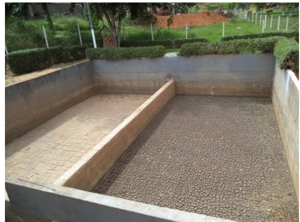
FIGURA 71 - ETE DISTRITO DE BICUÍBA (VISTA 4) (FONTE: ACERVO DO AUTOR, 2014)
