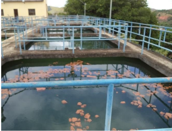
FIGURA 12 - ETA (VISTA 3) (FONTE: ACERVO DO AUTOR, 2014)
