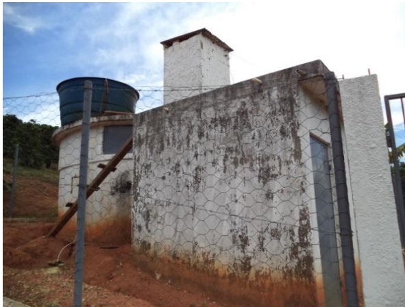
FIGURA 43 - SISTEMA DE TRATAMENTO E RESERVAÇÃO SÃO SEBASTIÃO DO ÓCULO (VISTA 1) (FONTE: ACERVO DO AUTOR, 2014)
