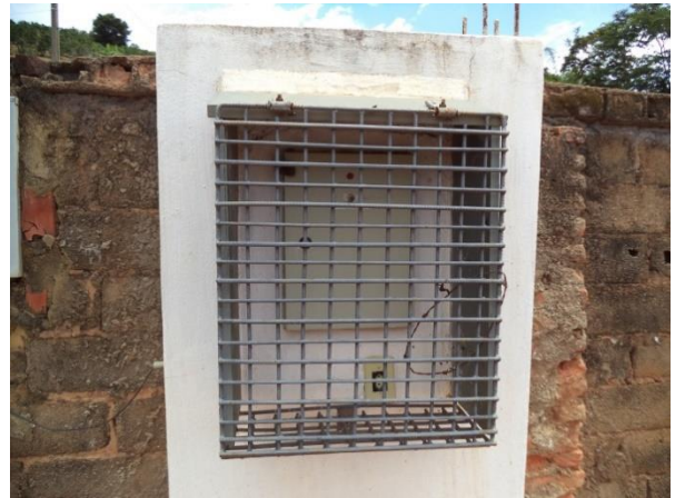
FIGURA 42- CAPTAÇÃO SÃO SEBASTIÃO DO ÓCULO (VISTA 2) (FONTE: ACERVO DO AUTOR, 2014)
