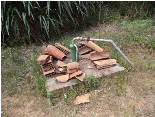
FIGURA 41 - CAPTAÇÃO SÃO SEBASTIÃO DO ÓCULO (VISTA 1) (FONTE: ACERVO DO AUTOR, 2014)
