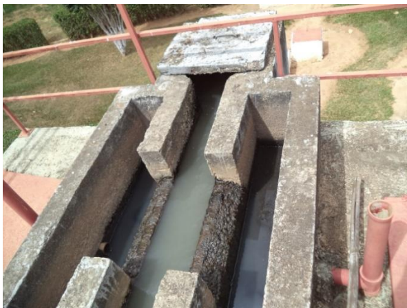
FIGURA 68 - ETE DISTRITO DE BICUÍBA (VISTA 1) (FONTE: ACERVO DO AUTOR, 2014)
