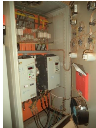
FIGURA 9 - EEAB - PAINEL DE COMANDO (FONTE: ACERVO DO AUTOR, 2014)
