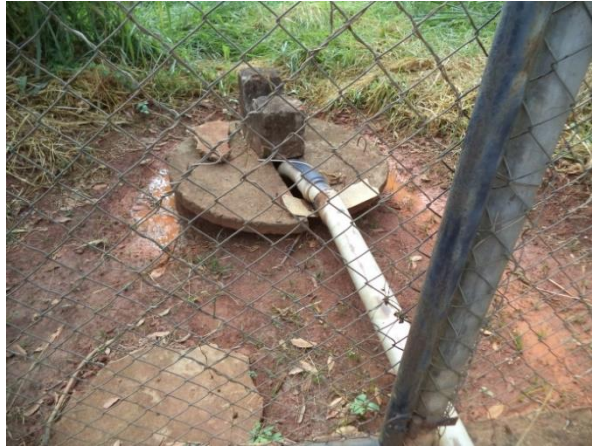
FIGURA 7 - POÇO TUBULAR PROFUNDO (FONTE: ACERVO DO AUTOR, 2014)
