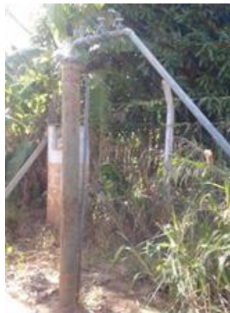
FIGURA 23 - POÇO TUBULAR PROFUNDO ESCOLA ESTADUAL OMAR RESENDE PEREZ (FONTE: ACERVO DO AUTOR, 2014)
