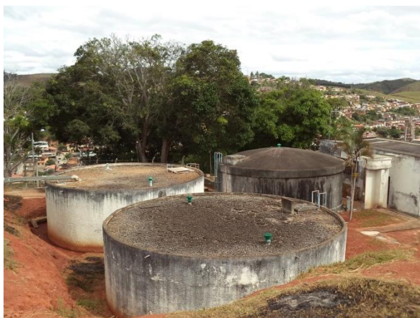
FIGURA 16 - RESERVATÓRIOS R1, R2 E R3 (FONTE: ACERVO DO AUTOR, 2014)
