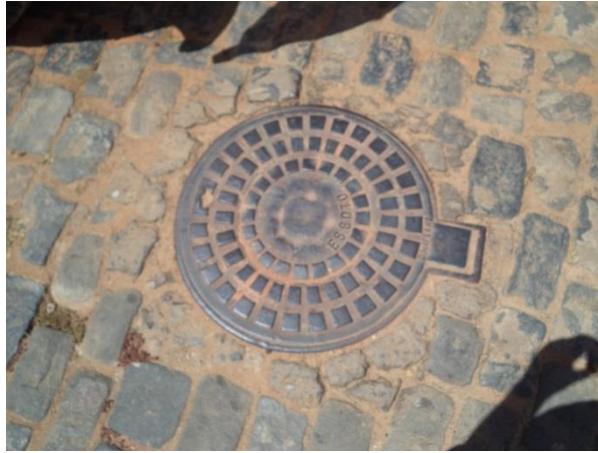
FIGURA 30 - REDE COLETORA (POÇO DE VISITA) (FONTE: ACERVO DO AUTOR, 2014)
