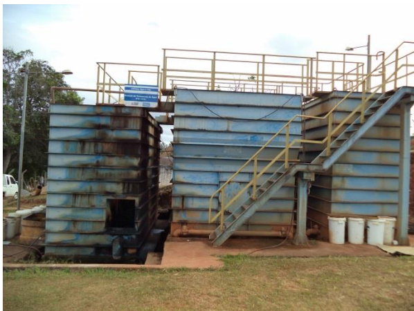
FIGURA 12 - ETA COMPACTA (VISTA 1) (FONTE: ACERVO DO AUTOR, 2014)
