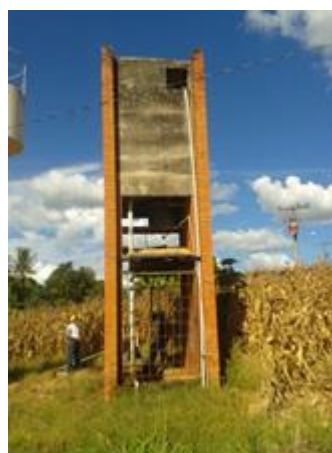
FIGURA 29 - RESERVATÓRIO ESTADO ESCOLA OMAR REZENDE Perez (FONTE: ACERVO DO AUTOR, 2014)
