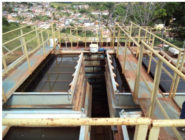
FIGURA 13 - ETA COMPACTA (VISTA 2) (FONTE: ACERVO DO AUTOR, 2014)
