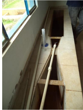
FIGURA 9 - CALHA PARSHALL (FONTE: ACERVO DO AUTOR, 2014)
