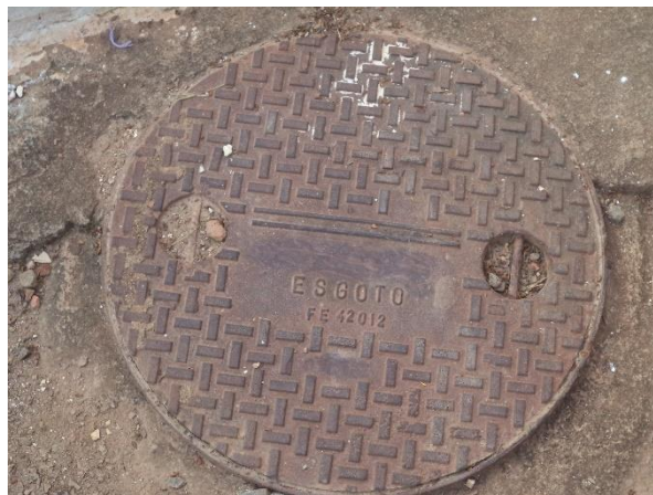
FIGURA 18 - POÇO DE VISITA (FONTE: ACERVO DO AUTOR, 2014)
