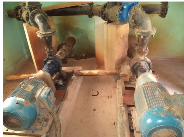
FIGURA 7 - CAPTAÇÃO - BOMBA (FONTE: ACERVO DO AUTOR, 2014)
