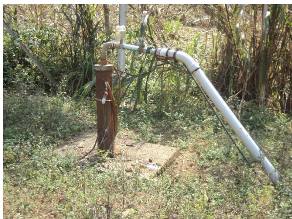
FIGURA 28 – POÇO TUBULAR (VISTA 1) (FONTE: ACERVO DO AUTOR, 2014)
