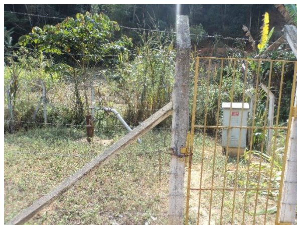
FIGURA 29 – POÇO TUBULAR (VISTA 2) (FONTE: ACERVO DO AUTOR, 2014)
