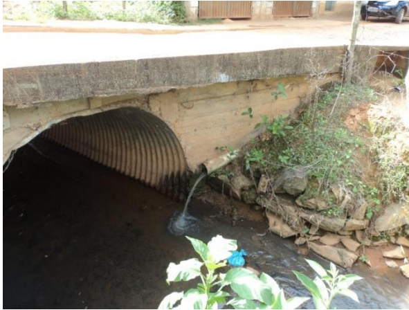
FIGURA 33 – PONTO DE DESPEJO DE ESGOTO IN NATURA NO RIO TENERÉ (FONTE: ACERVO DO AUTOR, 2014)
