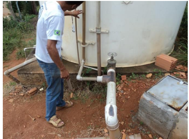
FIGURA 14 – ADUTORA DE ÁGUA BRUTA (FONTE: ACERVO DO AUTOR, 2014)
