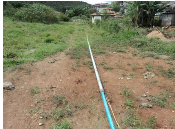
FIGURA 8 – ADUTORA DE ÁGUA BRUTA (FONTE: ACERVO DO AUTOR, 2014)
