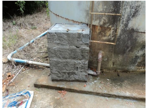
FIGURA 16 – ADUTORAS DE ÁGUA TRATADA E TRATAMENTO (FONTE: ACERVO DO AUTOR, 2014)
