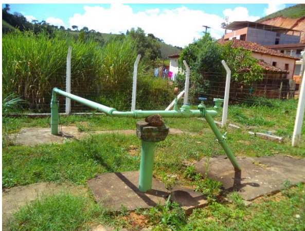
FIGURA 7 - CAPTAÇÃO POÇO C-08 (VISTA 1) (FONTE: ACERVO DO AUTOR, 2014)
