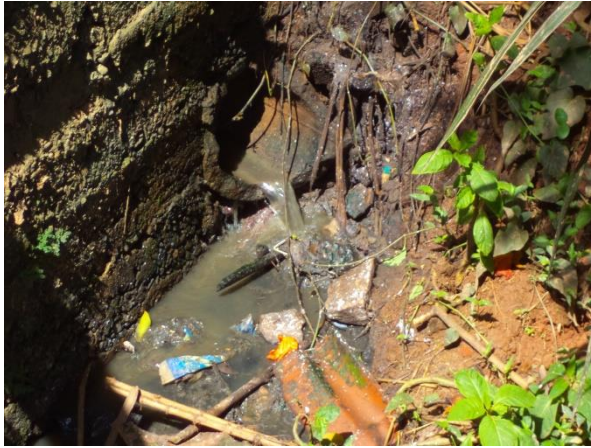
FIGURA 25 - PONTO DE DESPEJO DE ESGOTO (FONTE: ACERVO DO AUTOR, 2014)
