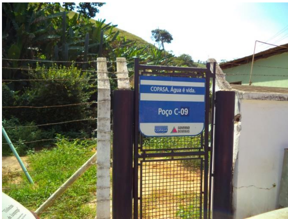
FIGURA 9 - CAPTAÇÃO POÇO C- 09 (VISTA 1) (FONTE: ACERVO DO AUTOR, 2014)
