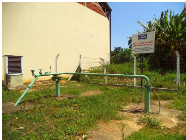
FIGURA 8 - CAPTAÇÃO POÇO C-08 (VISTA 2) (FONTE: ACERVO DO AUTOR, 2014)
