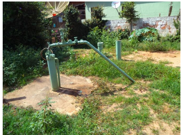
FIGURA 10 - CAPTAÇÃO POÇO C- 09 (VISTA 2) (FONTE: ACERVO DO AUTOR, 2014)
