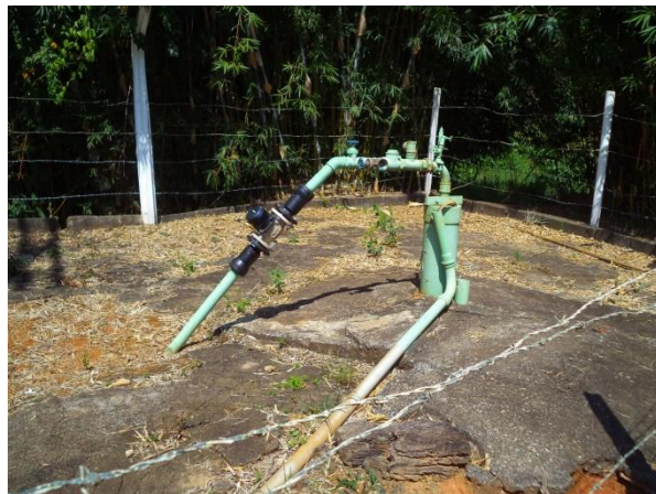
FIGURA 6 - CAPTAÇÃO POÇO C-05 (VISTA 2) (FONTE: ACERVO DO AUTOR, 2014)
