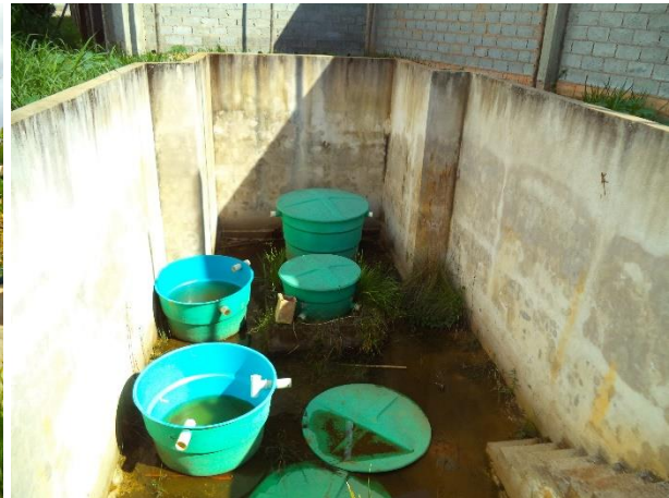
FIGURA 35 - ETE INACABADA (VISTA 2) (FONTE: ACERVO DO AUTOR, 2014)
