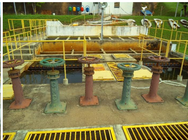
FIGURA 9 - ETA (VISTA 2) (FONTE: ACERVO DO AUTOR, 2014)
