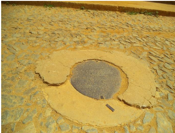
FIGURA 30 - POSTO DE VISITA (FONTE: ACERVO DO AUTOR, 2014)
