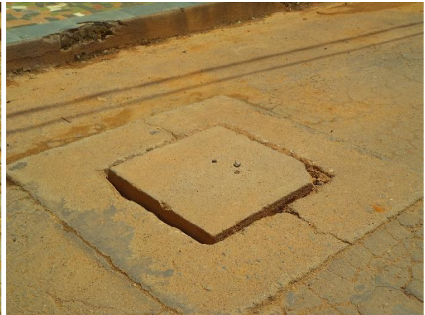
FIGURA 31 - CAIXA COLETORA DE ESGOTO (FONTE: ACERVO DO AUTOR, 2014)
