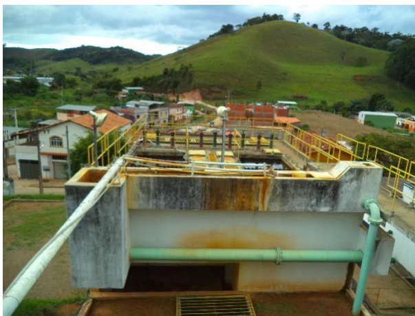
FIGURA 8 - ETA (VISTA 1) (FONTE: ACERVO DO AUTOR, 2014)
