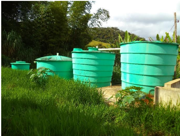
FIGURA 34 - ETE INACABADA (VISTA 1) (FONTE: ACERVO DO AUTOR, 2014)
