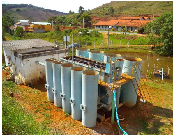
FIGURA 7 – ETA do tipo compacta (Fonte: Acervo do Autor, 2014)
