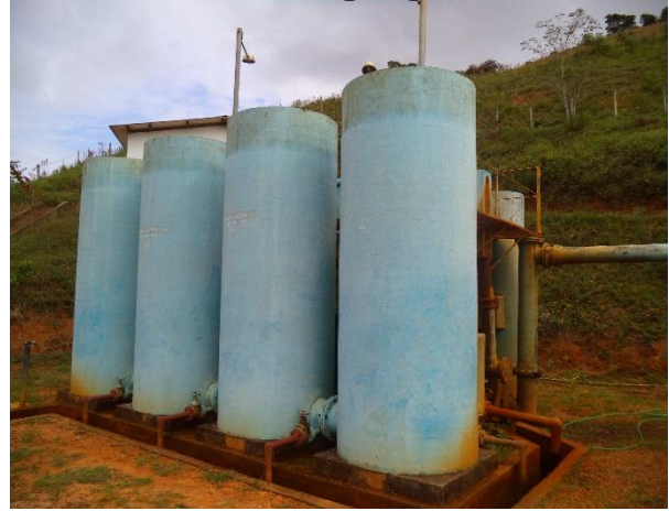
FIGURA 9 – FLOCULADORES (FONTE: ACERVO DO AUTOR, 2014)
