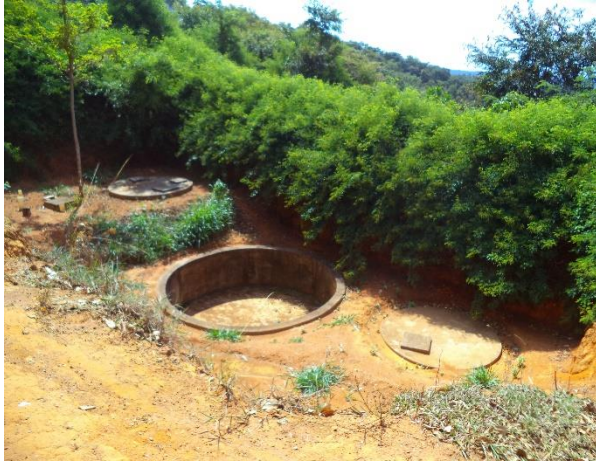
FIGURA 27 – TRATAMENTO DE CHORUME - INATIVO (FONTE: ACERVO DO AUTOR, 2014)
