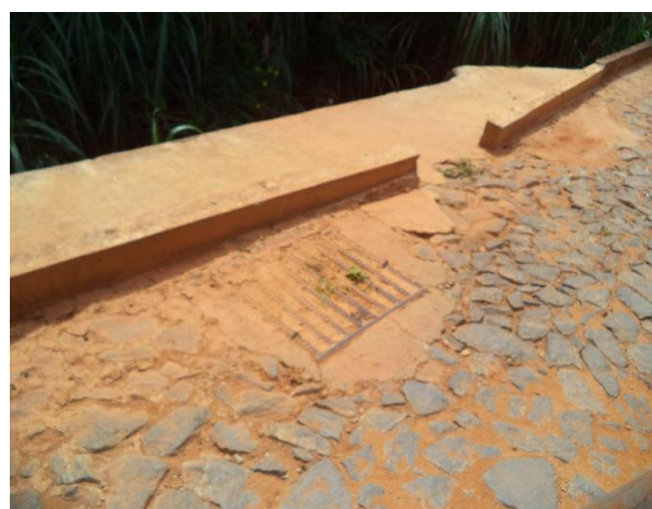
FIGURA 30 – BOCA DE LOBO OBSTRUÍDA (FONTE: ACERVO DO AUTOR, 2014)
