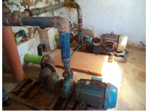
FIGURA 15 – EEAT - BOMBA (FONTE: ACERVO DO AUTOR, 2014)
