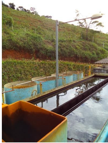
FIGURA 8 – CALHA PARSHALL (FONTE: ACERVO DO AUTOR, 2014)
