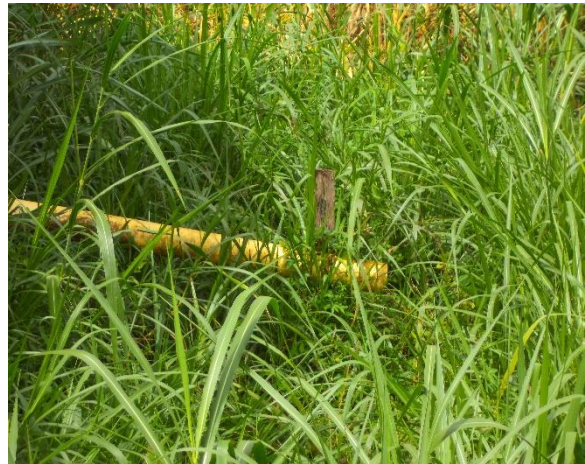
FIGURA 21 – LANÇAMENTO DE ESGOTO DOS DOMICÍLIOS 2 (FONTE: ACERVO DO AUTOR, 2014)
