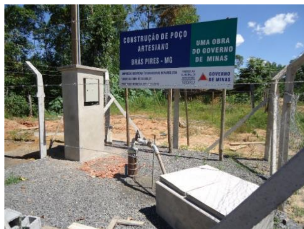
Foto 5.6 – Poço artesiano P2 Fonte: Elaboração ENGEORPS, 2014.
