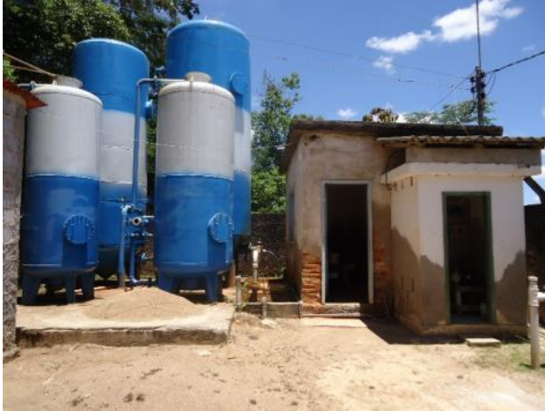
Foto 5.12 – ETA Compacta de Brás Pires Fonte: Elaboração ENGECORPS, 2014.
