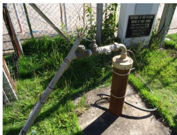
Foto 5.24 – Poço Artesiano Rib. Santo Antônio
