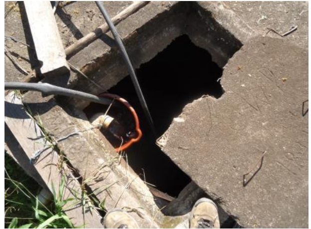
Foto 5.26 – Reservatório 2 (Capt. Nasc. Faísca)
