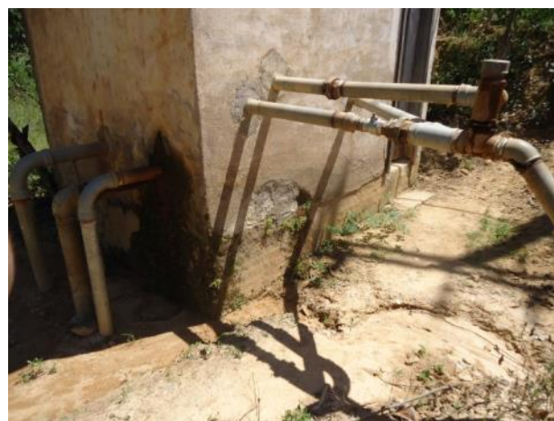
Foto 5.10 – Adutoras de entrada e saída da EEAB
