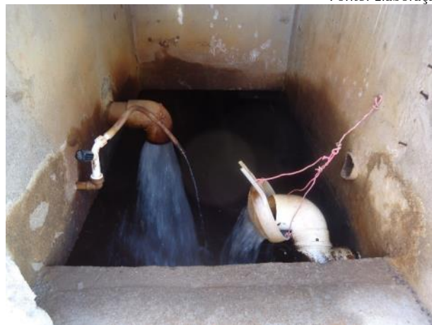
Foto 5.16 – Chegada de água tratada – esquerda (Córrego Água Quente) e água bruta - direita (Córrego Rancho) no reservatório R1 Fonte: Elaboração ENGECORPS, 2014.
