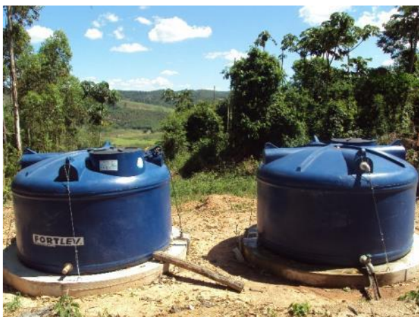
Foto 5.19 – Reservatórios R3 e R4
