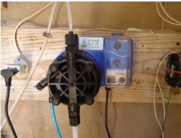
Foto 5.14 – Controle de Dosagem da Desinfecção Fonte: Elaboração ENGECORPS, 2014.
