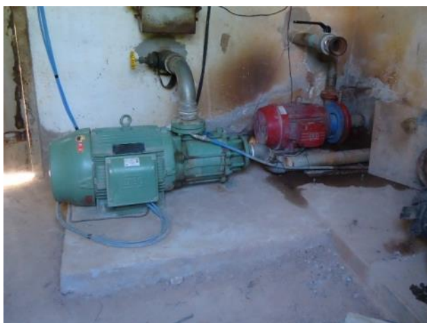
Foto 5.9 – EEAB – Conjuntos Motobomba (1+1)
