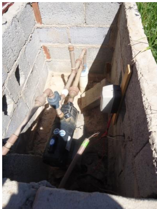
Foto 5.8 – Poço semiartesiano P3
