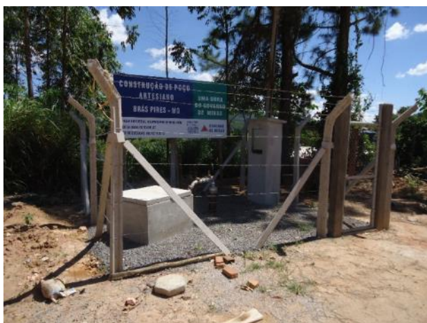
Foto 5.5 – Poço artesiano P1 Fonte: Elaboração ENGEORPS, 2014.
