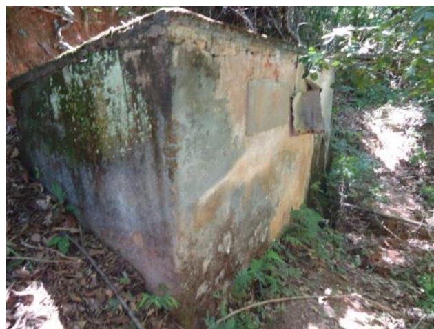
Foto 5.2 – Captação Córrego Rancho (Nasc. Mãe d'Água) – Caixa de Passagem de Concreto
