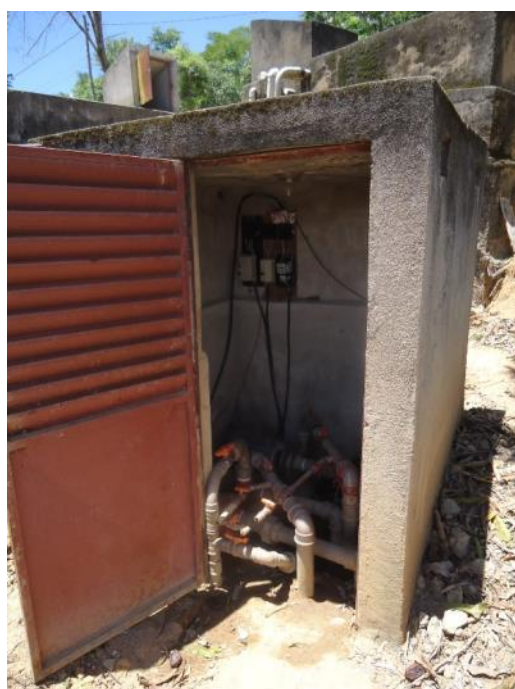
Foto 5.21 – Abrigo dos Boosters (ETA)
