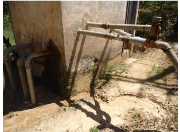
Foto 5.10 – Adutoras de entrada e saída da EEAB
