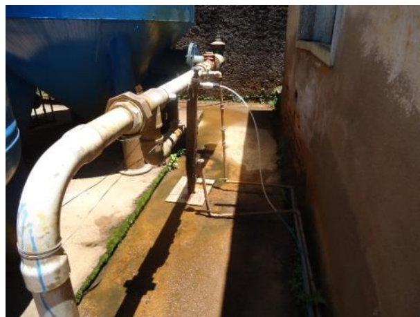
Foto 5.13 – Desinfecção da Captação do Córrego da Água Quente Fonte: Elaboração ENGECORPS, 2014.
