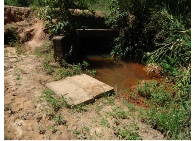
Foto 5.4 – Captação Córrego Água Quente – Tomada d'água (atrás da EEAB)
