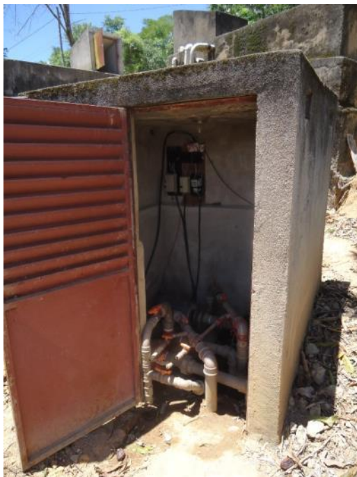
Foto 5.21 – Abrigo dos Boosters (ETA)
