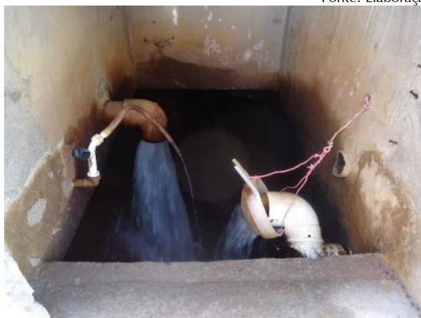
Foto 5.16 – Chegada de água tratada – esquerda (Córrego Água Quente) e água bruta - direita (Córrego Rancho) no reservatório R1 Fonte: Elaboração ENGECORPS, 2014.
