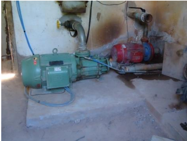
Foto 5.9 – EEAB – Conjuntos Motobomba (1+1)
