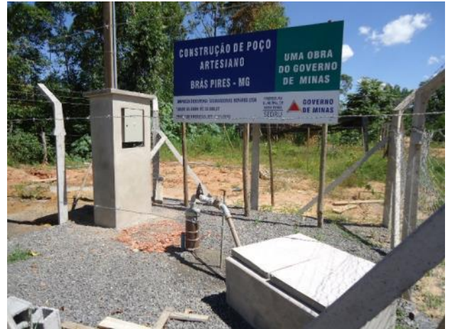
Foto 5.6 – Poço artesiano P2 Fonte: Elaboração ENGEORPS, 2014.
