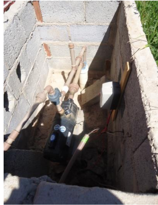
Foto 5.8 – Poço semiartesiano P3 Fonte: Elaboração ENGEORPS, 2014.
