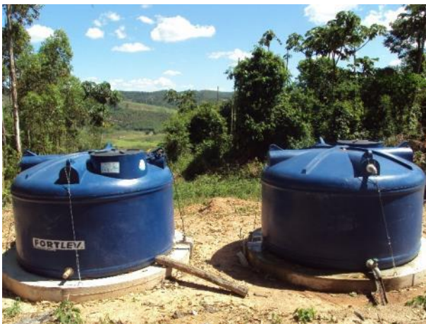
Foto 5.19 – Reservatórios R3 e R4
