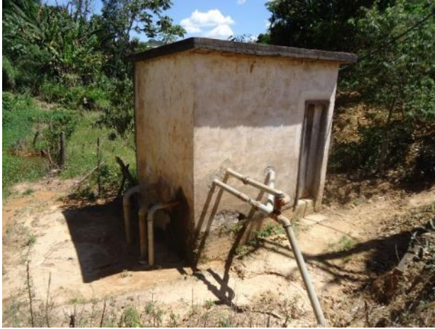
Foto 5.3 – Captação Córrego Água Quente – EEAB
