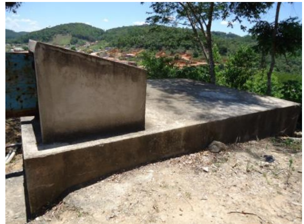
Foto 5.18 – Reservatório R2 (ETA)
