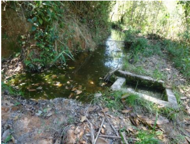
Foto 5.1 – Captação Córrego Rancho (Nasc. Mãe d'Água) – Caixa de Captação
