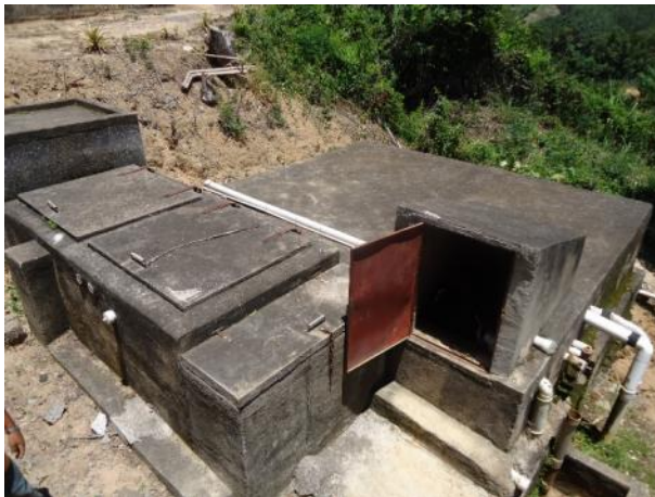
Foto 5.17 – Reservatório R1 (ETA)
