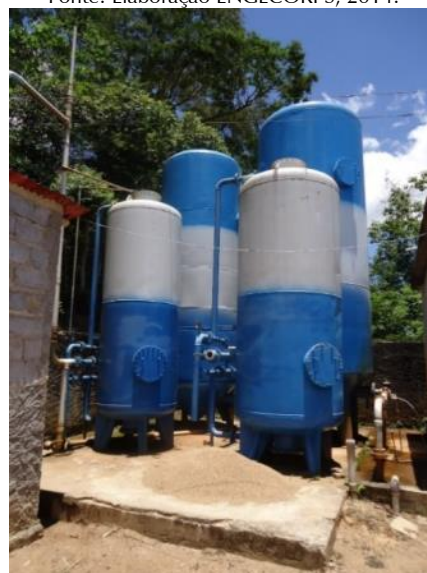
Foto 5.15 – 2 Decantadores (tanques maiores) e 2 Filtros (tanques menores) Fonte: Elaboração ENGECORPS, 2014.
