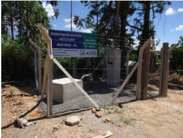
Foto 5.5 – Poço artesiano P1 Fonte: Elaboração ENGEORPS, 2014.
