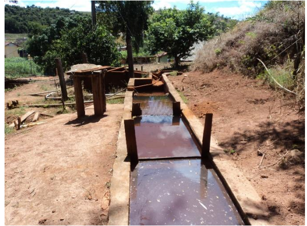
FIGURA 17 – CAPTAÇÃO SUPERFICIAL CÓRREGO DO MAMÃO (VISTA 2) (FONTE: VALLENGE, 2014)
