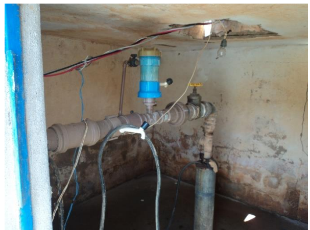
FIGURA 21 – POÇO DE CAPTAÇÃO 4 (FONTE: VALLENGE, 2014)
