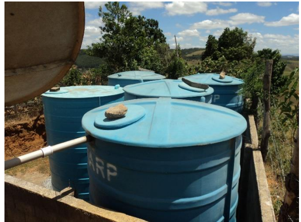
FIGURA 32 – RESERVATÓRIOS DE FIBRA DE VIDRO (FONTE: VALLENGE, 2014)
