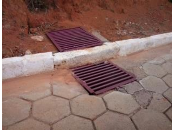
FIGURA 43 – BOCAS-DE-LOBO (FONTE: VALLENGE, 2014)
