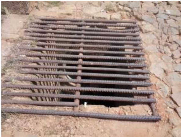
FIGURA 41 – BOCAS-DE-LOBO (FONTE: VALLENGE, 2014)
