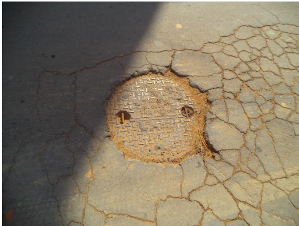
Figura 35 – POÇO DE VISITA 1 (FONTE: VALLENGE, 2014)
