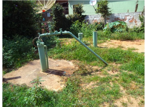
FIGURA 22 – CAPTAÇÃO POÇO C-09 (VISTA 2) (FONTE: VALLENGE, 2014)
