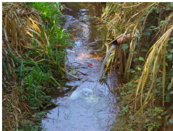
FIGURA 38 – LANÇAMENTO DIRETO DE EFLUENTES NO CORPO RECEPTOR (FONTE: VALLENGE, 2014)
