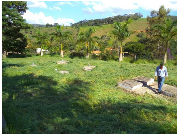
FIGURA 50 – SISTEMA DE TRATAMENTO DO CHORUME (FONTE: VALLENGE, 2014)
