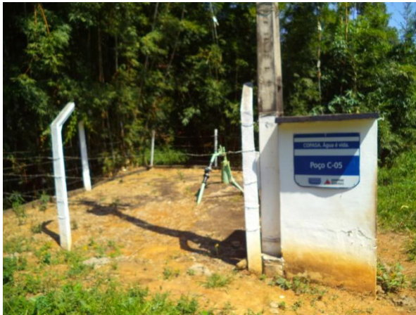
FIGURA 17 – CAPTAÇÃO POÇO C-05 (VISTA 1) (FONTE: VALLENGE, 2014)
