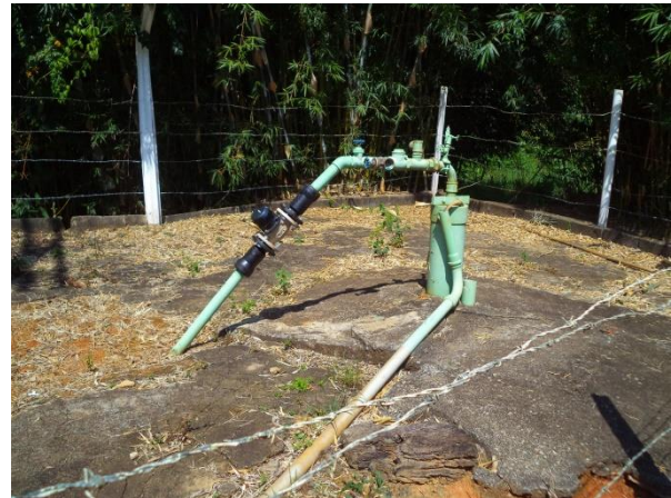
FIGURA 18 – CAPTAÇÃO POÇO C-05 (VISTA 2) (FONTE: VALLENGE, 2014)
