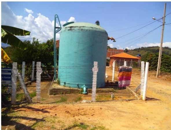
FIGURA 33 – RESERVATÓRIO ITAMAR (VISTA 1) (FONTE: VALLENGE, 2014)
