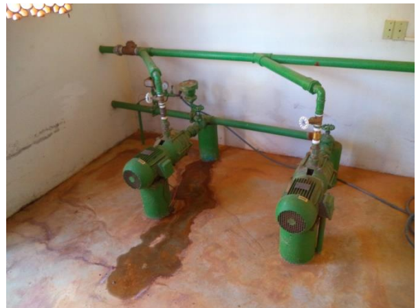
FIGURA 28 – BOOSTER NOVO HORIZONTE (FONTE: VALLENGE, 2014)
