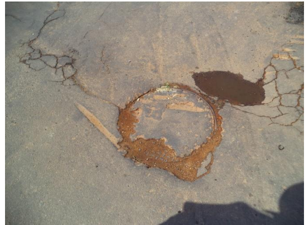
FIGURA 36 – POÇO DE VISITA 2 (FONTE: VALLENGE, 2014)
