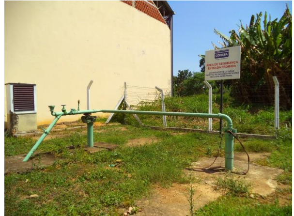
FIGURA 20 – CAPTAÇÃO POÇO C-08 (VISTA 2) (FONTE: VALLENGE, 2014)
