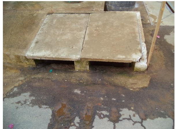
FIGURA 53 – BOCAS-DE-LOBO (FONTE: VALLENGE, 2014)
