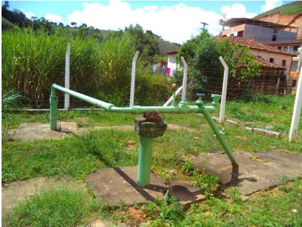
FIGURA 19 – CAPTAÇÃO POÇO C-08 (VISTA 1) (FONTE: VALLENGE, 2014)
