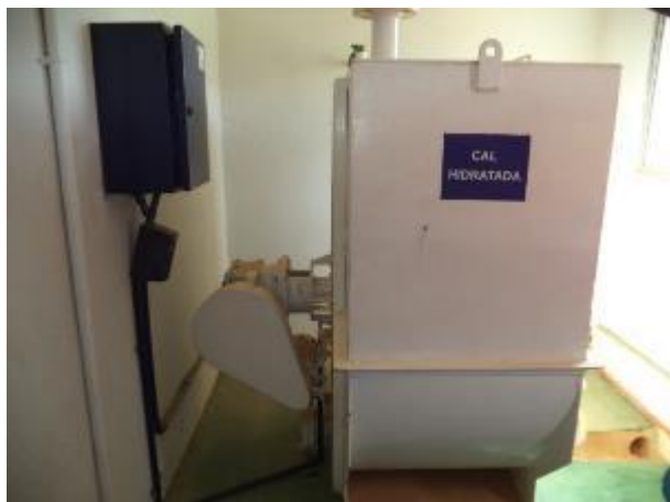
FIGURA 98 – DOSAGEM DE PRODUTOS QUÍMICOS (VISTA 1) (FONTE: VALLENGE, 2014)
