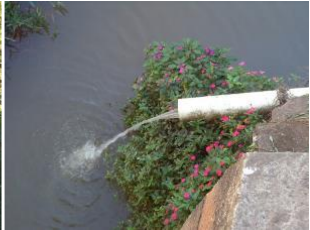
FIGURA 151 – LANÇAMENTO IN NATURA DE ESGOTO (VISTA 2) (FONTE: VALLENGE, 2014)
