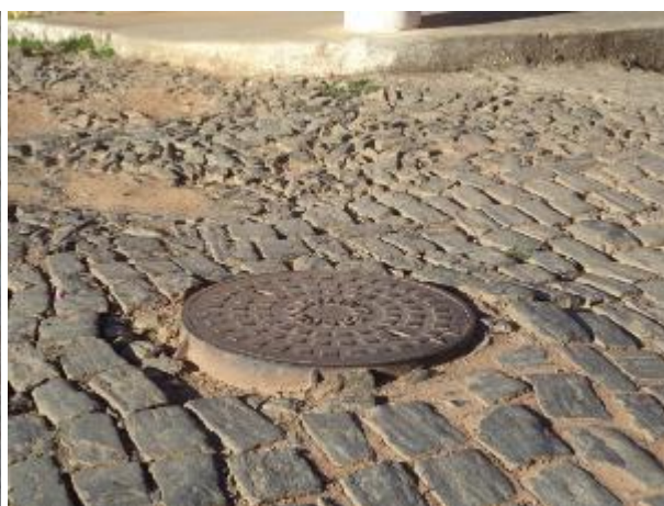
FIGURA 149 – POÇO DE VISITA (VISTA 2) (FONTE: VALLENGE, 2014)
