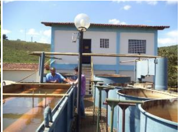
FIGURA 95 – ESTAÇÃO DE TRATAMENTO DE ÁGUA (VISTA 4) (FONTE: VALLENGE, 2014)
