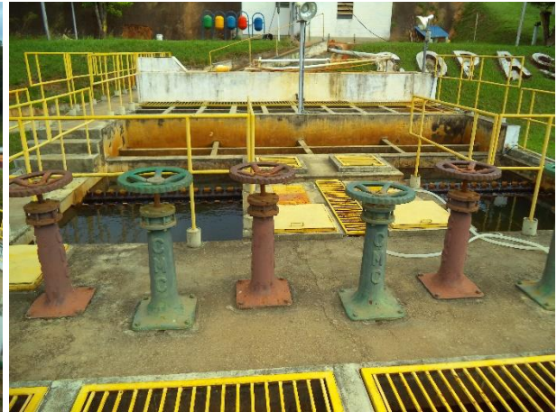
FIGURA 21 – ETA (VISTA 2) (FONTE: VALLENGE, 2014)
