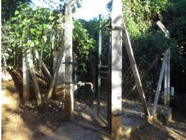
FIGURA 140 – POÇO TUBULAR P1 – POVOADO DE BARROS (VISTA 1) (FONTE: VALLENGE, 2014)
