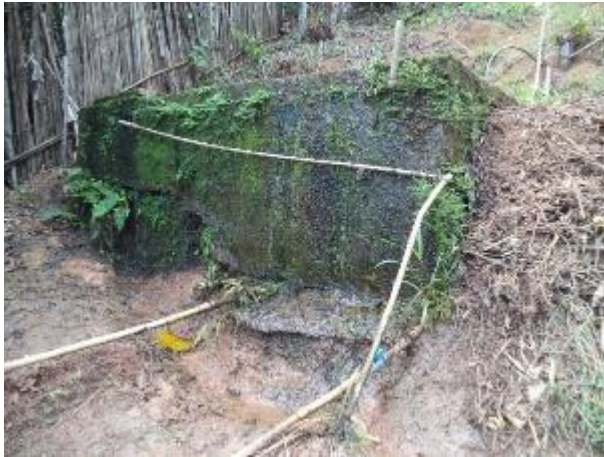
FIGURA 126 – RESERVATÓRIO-R1 – POVOADO DE FONSECA (VISTA 1) (FONTE: VALLENGE, 2014)
