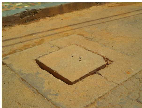
FIGURA 43 – CAIXA COLETORA DE ESGOTO (FONTE: VALLENGE, 2014)
