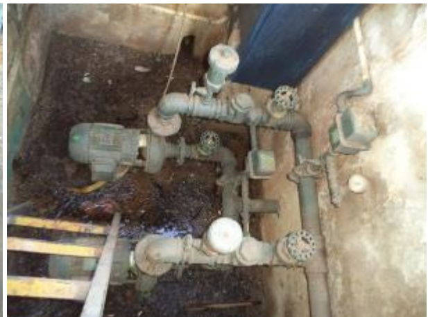
FIGURA 111 – BOOSTER-1 – BOMBAS (FONTE: VALLENGE, 2014)
