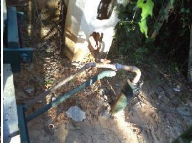
FIGURA 141 – POÇO TUBULAR P1 – POVOADO DE BARROS (VISTA 2) (FONTE: VALLENGE, 2014)
