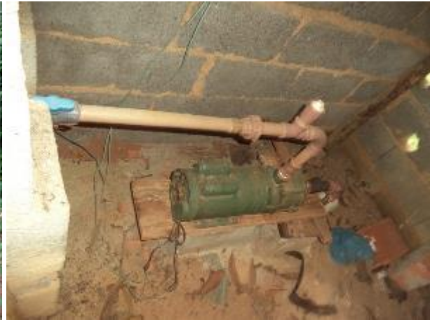
FIGURA 121 – POÇO TUBULAR – POVOADO DE GARAPA (VISTA 2) (FONTE: VALLENGE, 2014)
