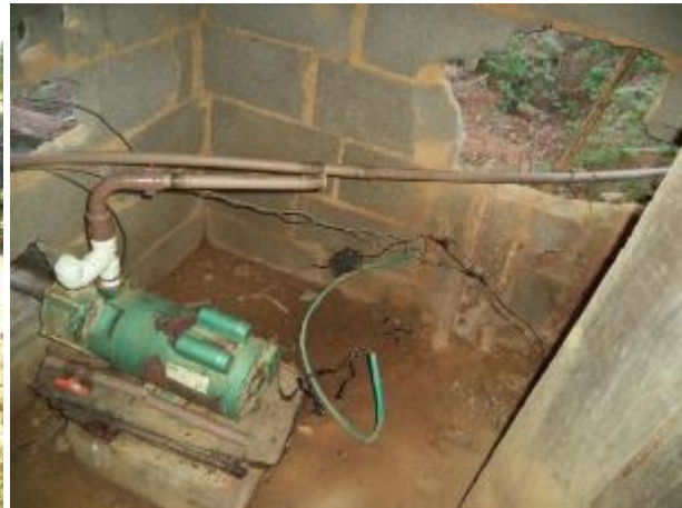
FIGURA 145 – POÇO TUBULAR P3 – POVOADO DE BARROS (VISTA 2) (FONTE: VALLENGE, 2014)
