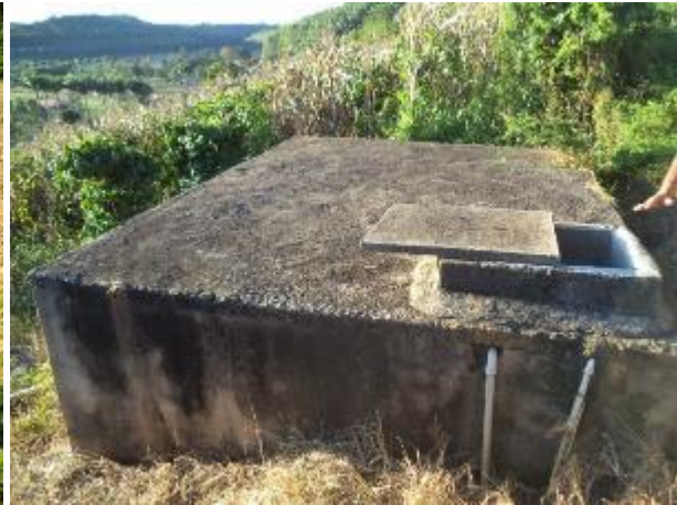
FIGURA 147 – RESERVATÓRIO R1 – POVOADO DE BARROSO (VISTA 2) (FONTE: VALLENGE, 2014)
