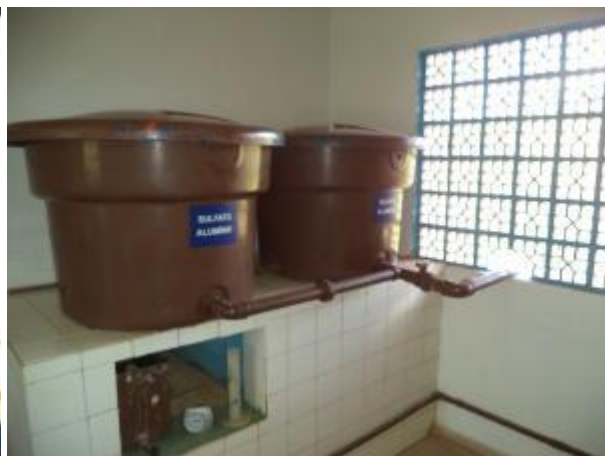
FIGURA 99 – DOSAGEM DE PRODUTOS QUÍMICOS (VISTA 2) (FONTE: VALLENGE, 2014)
