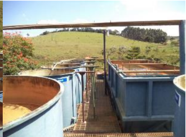
FIGURA 93 – ESTAÇÃO DE TRATAMENTO DE ÁGUA (VISTA 2)
