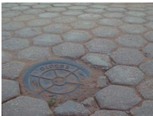
FIGURA 148 – POÇO DE VISITA (VISTA 1) (FONTE: VALLENGE, 2014)
