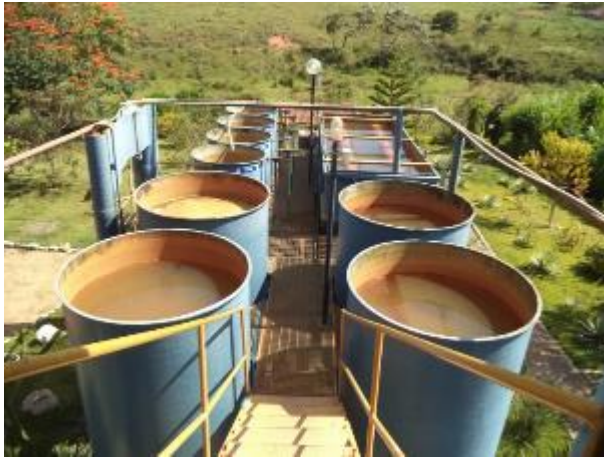
FIGURA 94 – ESTAÇÃO DE TRATAMENTO DE ÁGUA (VISTA 3) (FONTE: VALLENGE, 2014)
