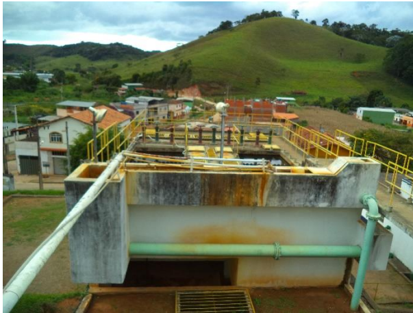
FIGURA 20 – ETA (VISTA 1) (FONTE: VALLENGE, 2014)
