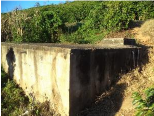
FIGURA 146 – RESERVATÓRIO R1 – POVOADO DE BARROSO (VISTA 1) (FONTE: VALLENGE, 2014)
