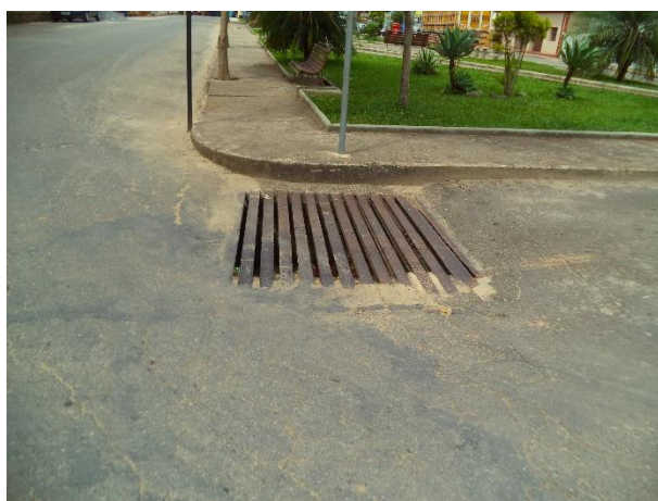
FIGURA 63 – BOCA-DE-LOBO (FONTE: VALLENGE, 2014)
