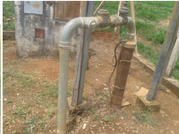
FIGURA 54 – POÇO CACHOEIRA DO LIVRAMENTO (VISTA 2) (FONTE: VALLENGE, 2014)
