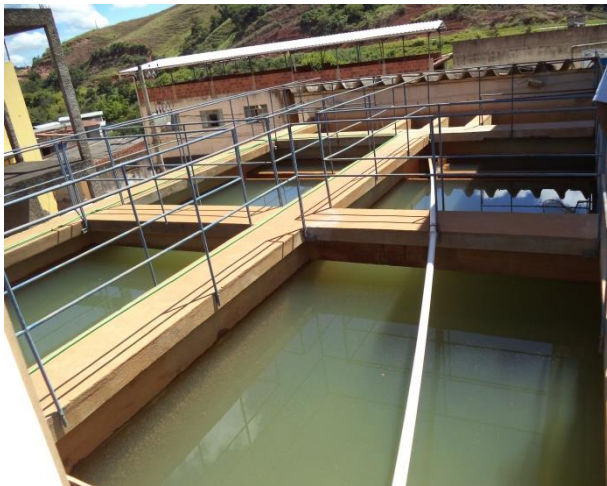
FIGURA 21 – ETA CONVENCIONAL (VISTA 1) (FONTE: VALLENGE, 2014)
