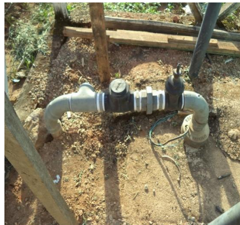
FIGURA 40 – POÇO 1 GRANADA (VISTA 2) (FONTE: VALLENGE, 2014)
