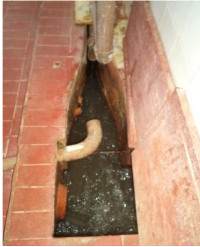
FIGURA 19 – CALHA PARSHALL (VISTA 1) (FONTE: VALLENGE, 2014)
