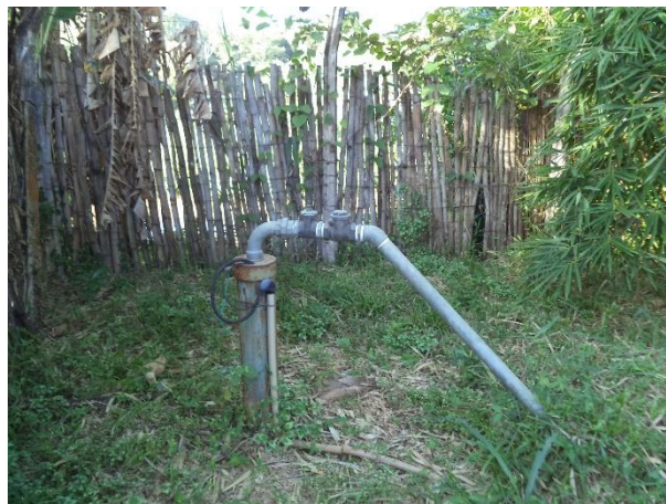
FIGURA 42 – POÇO 2 GRANADA (VISTA 2) (FONTE: VALLENGE, 2014)
