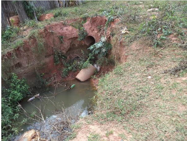
FIGURA 63 – LANÇAMENTO DE ESGOTO BARROSO (FONTE: VALLENGE, 2014)
