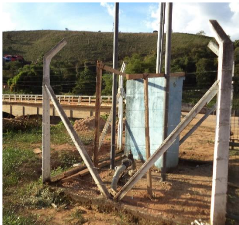
FIGURA 39 – POÇO 1 GRANADA 1 (VISTA 1) (FONTE: VALLENGE, 2014)
