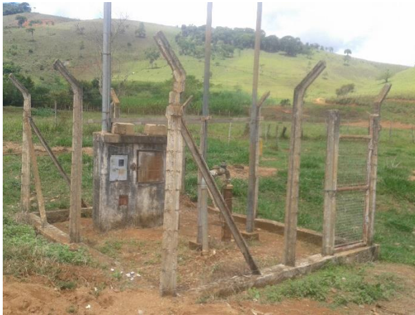
FIGURA 53 – POÇO CACHOEIRA DO LIVRAMENTO (VISTA 1) (FONTE: VALLENGE, 2014)
