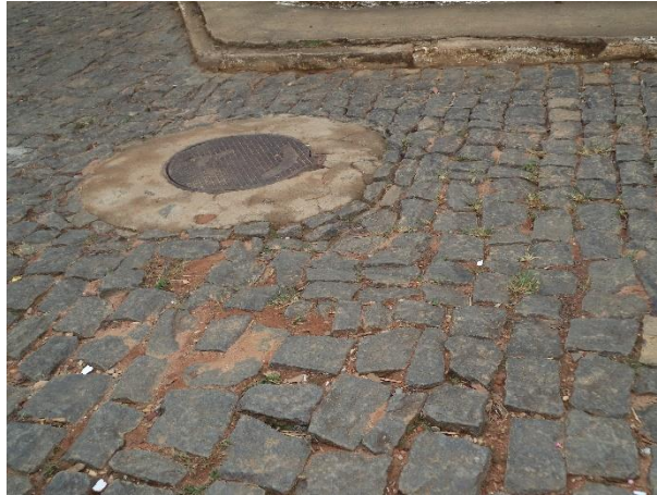
FIGURA 67 – POÇO DE VISITA (FONTE: VALLENGE, 2014)
