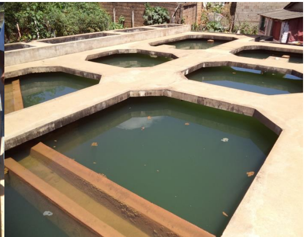
FIGURA 22 – ETA CONVENCIONAL (VISTA 2) (FONTE: VALLENGE, 2014)
