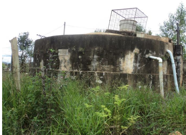
FIGURA 31 – RESERVATÓRIO R6 DESATIVADO (FONTE: VALLENGE, 2014)
