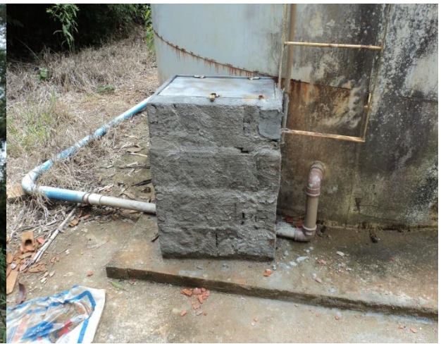
FIGURA 27 – ADUTORAS DE ÁGUA TRATADA E TRATAMENTO (FONTE: VALLENGE, 2014)
