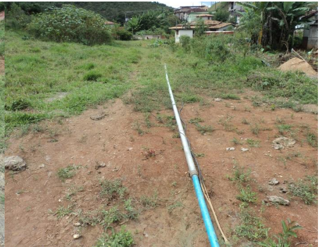
FIGURA 19 – ADUTORA DE ÁGUA BRUTA (FONTE: VALLENGE, 2014)
