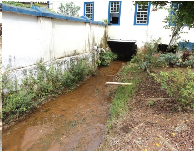
FIGURA 45 – PONTO DE DESPEJO DE ESGOTO IN NATURA RIBEIRÃO LAVAPÉS (FONTE: VALLENGE, 2014)
