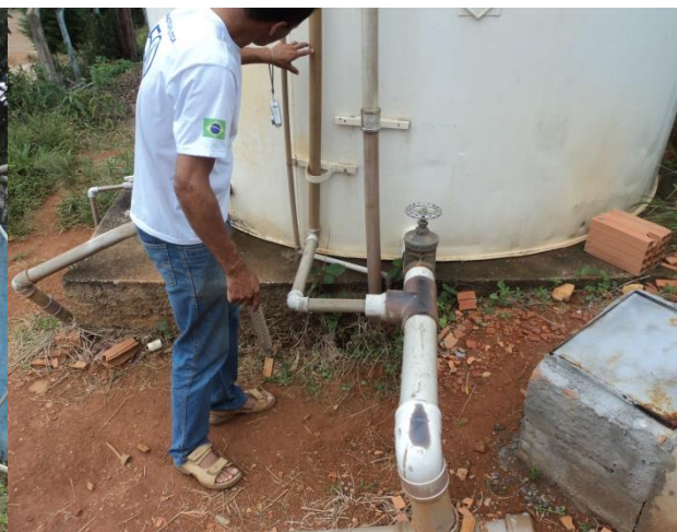
FIGURA 25 – ADUTORA DE ÁGUA BRUTA (FONTE: VALLENGE, 2014)
