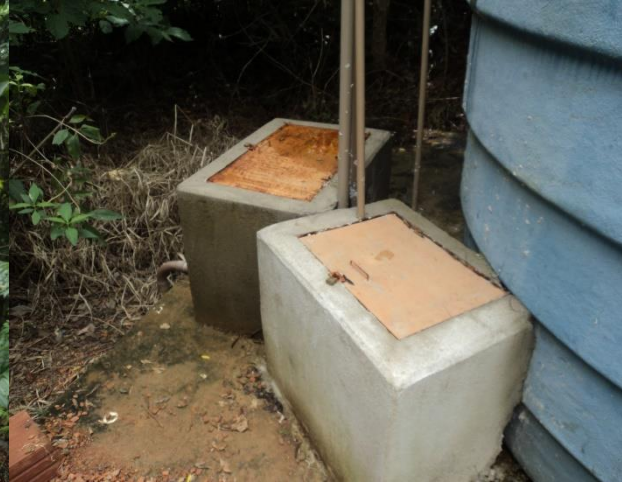
FIGURA 29 – ADUTORAS DE ÁGUA TRATADA E TRATAMENTO (FONTE: VALLENGE, 2014)
