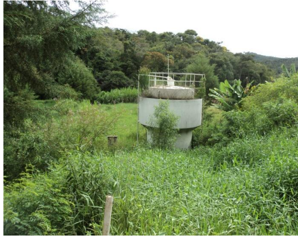
FIGURA 42 – ESTAÇÃO DE TRATAMENTO DE ESGOTO (FONTE: VALLENGE, 2014)
