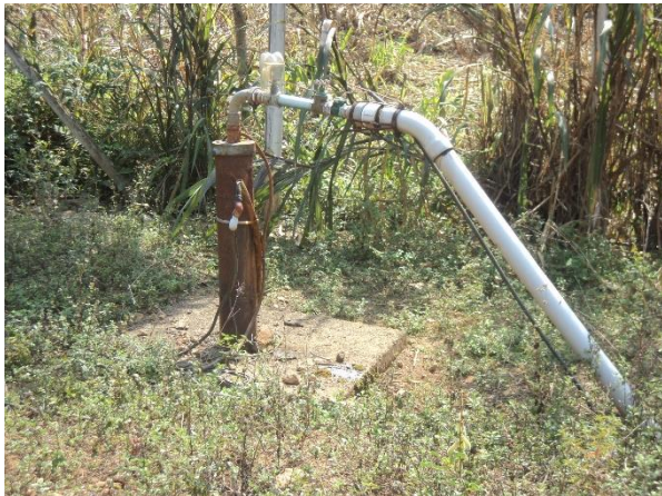
FIGURA 39 – POÇO TUBULAR BOA VISTA (VISTA 1) (FONTE: VALLENGE, 2014)
