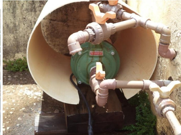
Figura 25 – Estação de tratamento de água (vista 4) (Fonte: Vallenge, 2014)
