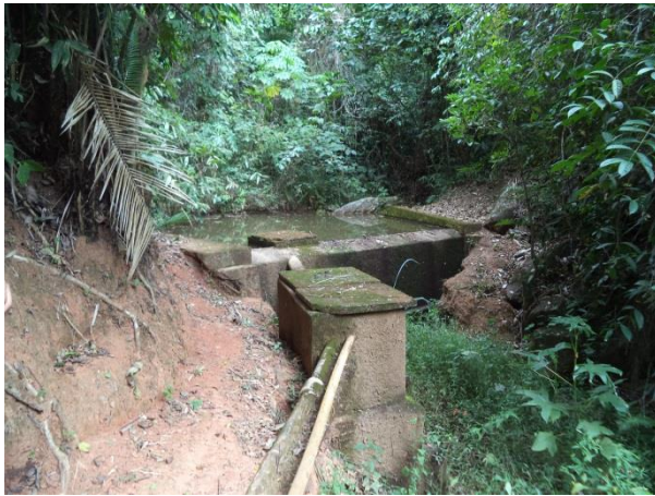
Figura 62 – Captação córrego Mulato Vermelho Velho (vista 1) (Fonte: Vallenge, 2014)
