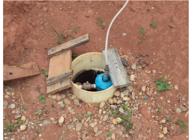
Figura 56 – Sistema de tratamento e reservação São Sebastião do Óculo (vista 2) (Fonte: Vallenge, 2014)
