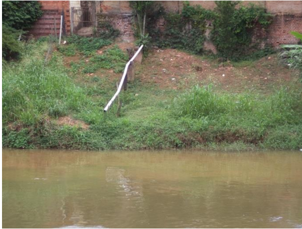
Figura 74 – Ponto de despejo de esgoto (Vista 1) (Fonte: Vallenge, 2014)
