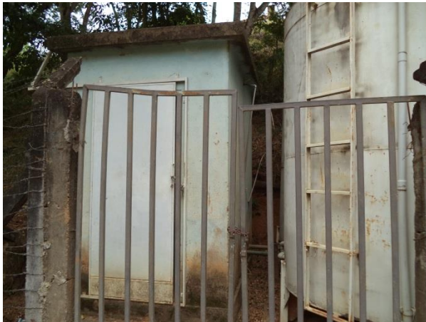
Figura 39 – EEAT 1 (vista 1) (Fonte: Vallenge, 2014)
