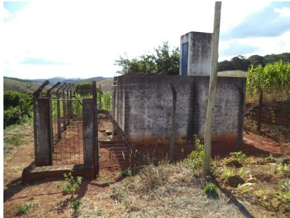
Figura 52 – Sistema de tratamento e reservação Santana do Tabuleiro(Fonte: Vallenge, 2014)
