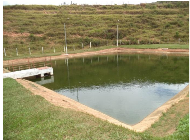
Figura 85 – ETE Distrito de Bicuíba (vista 6) (Fonte: Vallenge, 2014)
