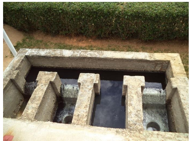
Figura 81 – ETE Distrito de Bicuíba (vista 2) (Fonte: Vallenge, 2014)
