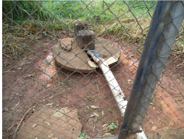
Figura 19 – Poço Tubular Profundo (Fonte: Vallenge, 2014)
