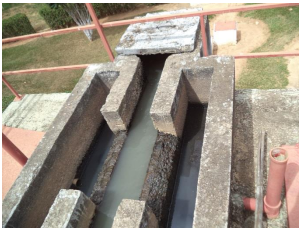
Figura 80 – ETE Distrito de Bicuíba (vista 1) (Fonte: Vallenge, 2014)
