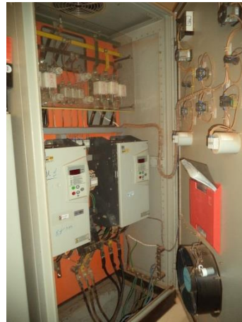
Figura 21 – Estação elevatória de água bruta – Painel de comando (Fonte: Vallenge, 2014)
