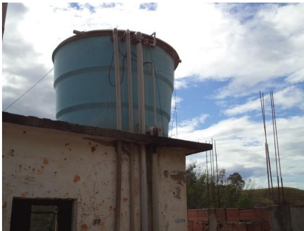
Figura 44 – EEAT 4 (vista 1) (Fonte: Vallenge, 2014)
