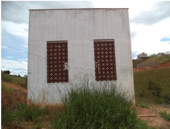
Figura 42 – EEAT 3 (vista 1) (Fonte: Vallenge, 2014)
