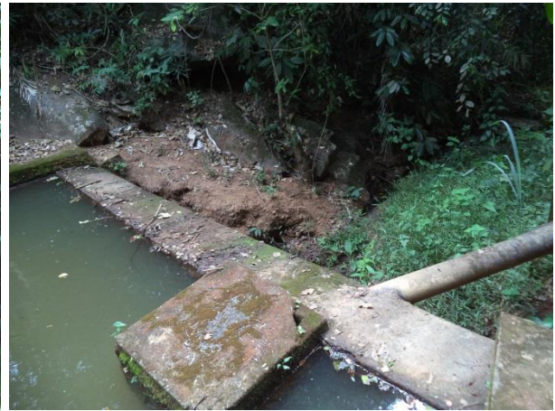
Figura 63 – Captação córrego Mulato Vermelho Velho (vista 2) (Fonte: Vallenge, 2014)
