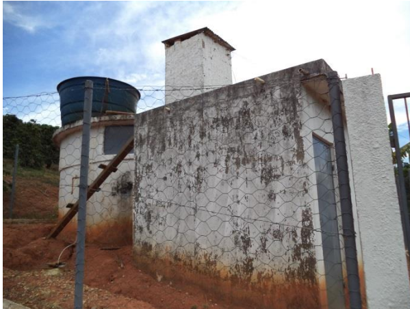
Figura 55 – Sistema de tratamento e reservação São Sebastião do Óculo (vista 1) (Fonte: Vallenge, 2014)
