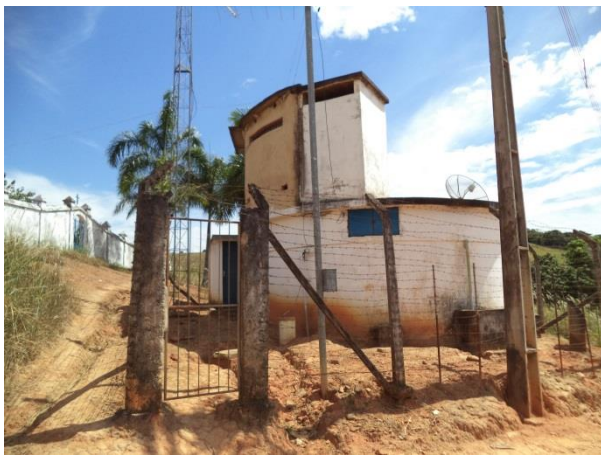
Figura 59 – Sistema de tratamento e reservação São Vicente da Estrela (vista 1) (Fonte: Vallenge, 2014)
