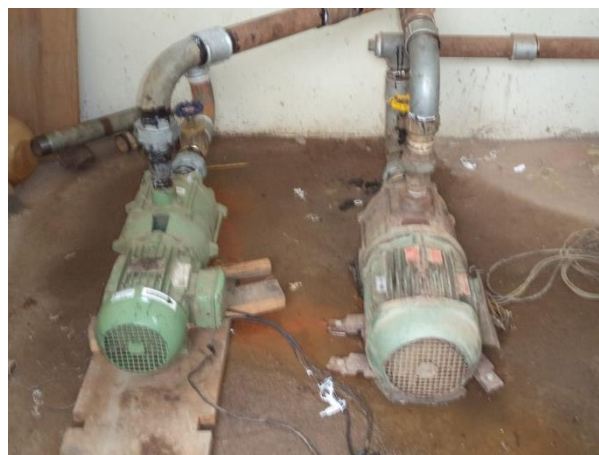
Figura 41 – EEAT 2 (Vista 1) (Fonte: Vallenge, 2014)
