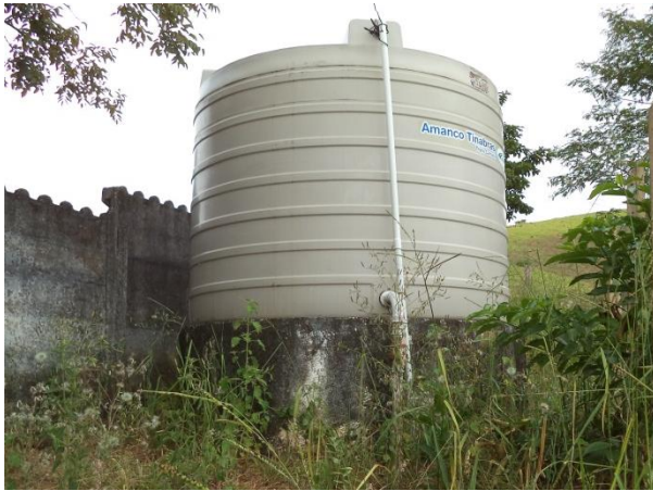
Figura 66 – Reservatório R2 Vermelho Velho (Fonte: Vallenge, 2014)
