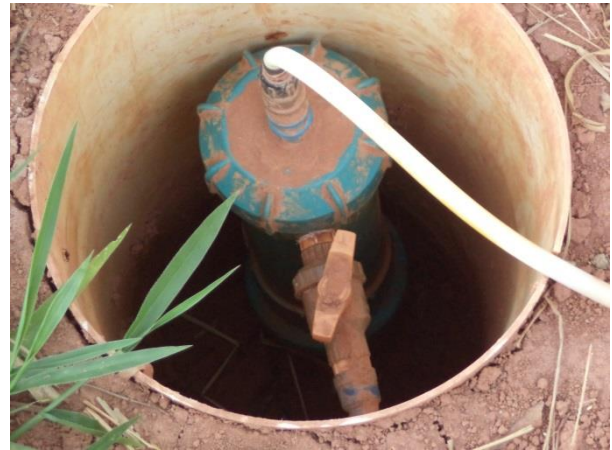
Figura 49 – Sistema de tratamento e reservação Bicuíba (vista 2) (Fonte: Vallenge, 2014)
