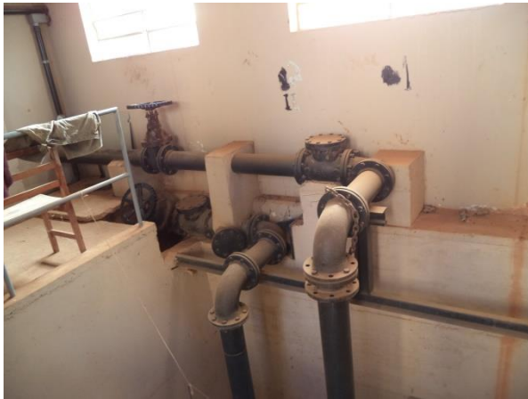
Figura 20 – Estação elevatória de água bruta – Adutoras de água bruta (Fonte: Vallenge, 2014)
