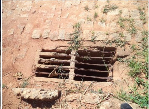
Figura 104 – Microdrenagem – sede (vista 2) (Fonte: Vallenge, 2014)
