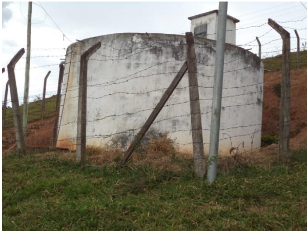
Figura 48 – Sistema de tratamento e reservação Bicuíba (vista 1) (Fonte: Vallenge, 2014)
