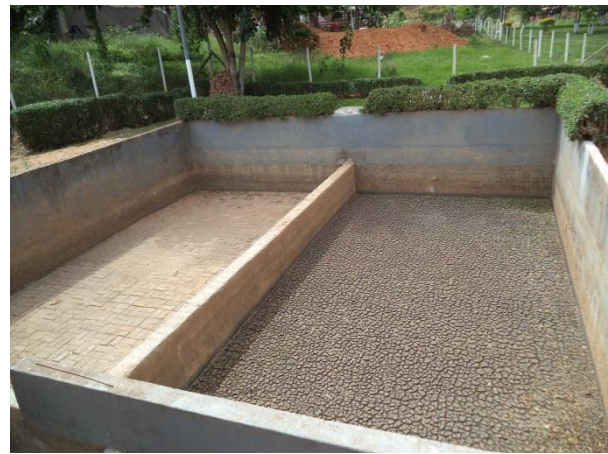
Figura 83 – ETE Distrito de Bicuíba (vista 4) (Fonte: Vallenge, 2014)
