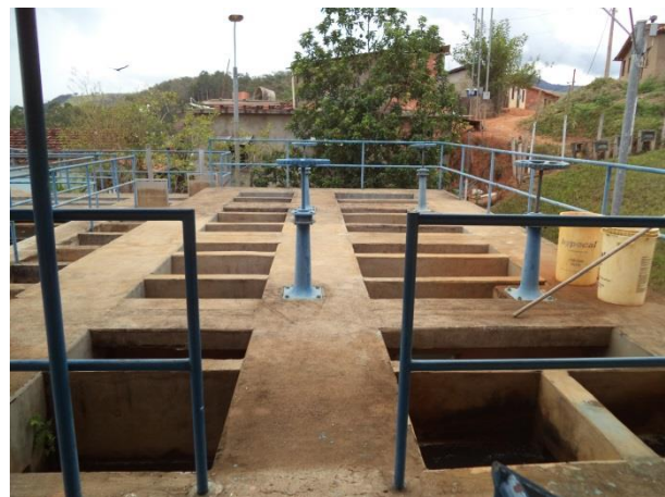
Figura 23 – Estação de tratamento de água (vista 1) (Fonte: Vallenge, 2014)
