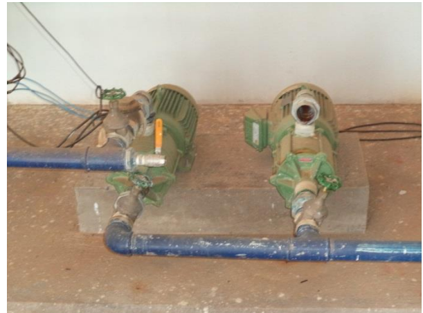
Figura 43 – EEAT 1 (vista 2) (Fonte: Vallenge, 2014)
