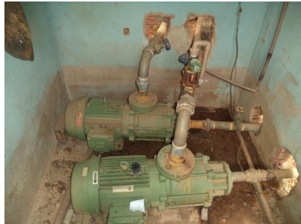
Figura 40 – EEAT 1 (vista 2) (Fonte: Vallenge, 2014)
