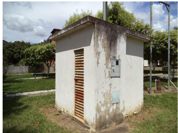
Figura 58 – Captação São Vicente da Estrela (vista 2) (Fonte: Vallenge, 2014)
