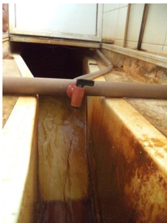
Figura 22 – Estação de tratamento de água (vista 1) (Fonte: Vallenge, 2014)
