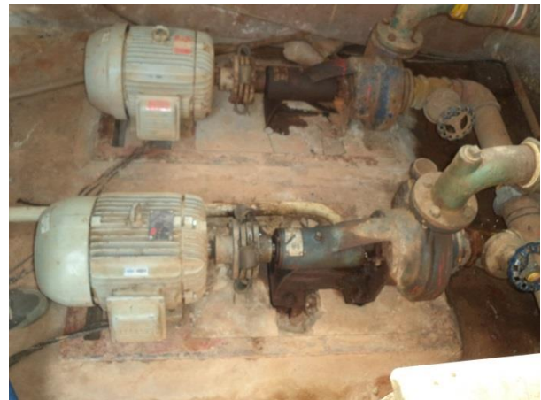
Figura 45 – EEAT 4 (vista 2) (Fonte: Vallenge, 2014)
