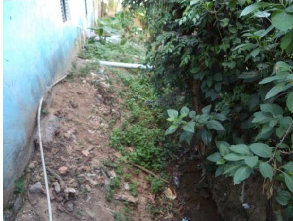
Figura 86 – Esgoto domiciliar – distrito de Santana do Tabuleiro (Fonte: Vallenge, 2014)
