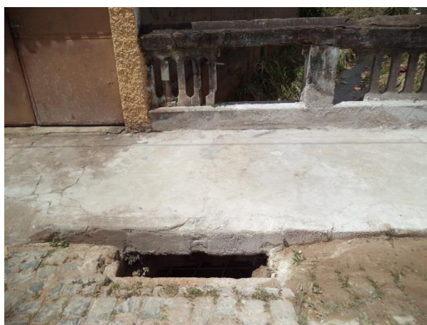
FIGURA 61 – DISPOSITIVOS DE MICRODRENAGEM (VISTA 1) (FONTE: VALLENGE, 2014)
