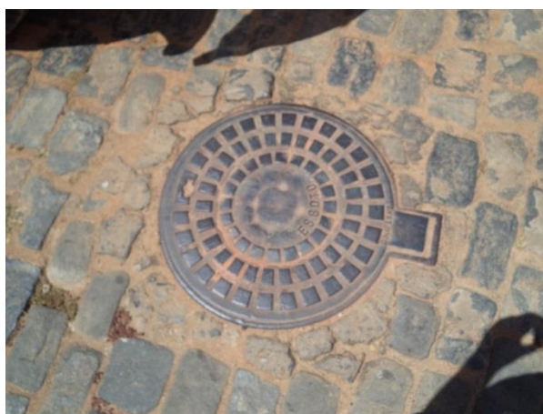
FIGURA 42 – REDE COLETORA (POÇO DE VISITA) (FONTE: VALLENGE, 2014)
