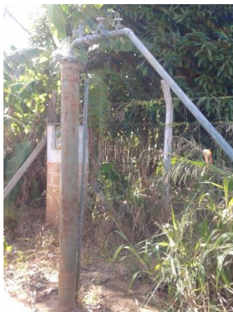
FIGURA 35 – POÇO TUBULAR PROFUNDO ESCOLA ESTADUAL OMAR RESENDE PEREZ (FONTE: VALLENGE, 2014)
