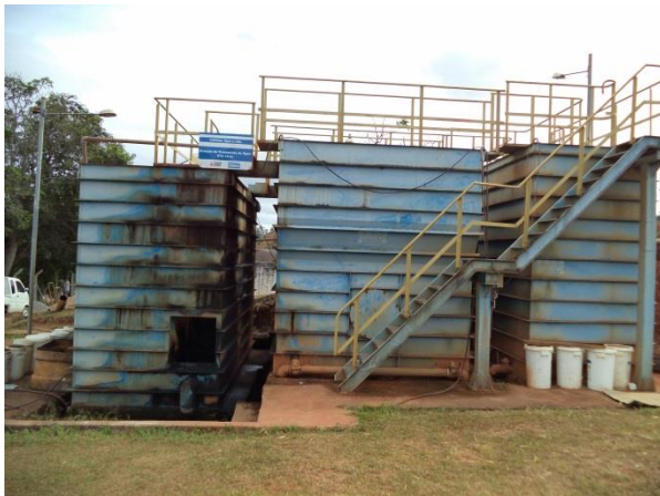
FIGURA 24 – ETA COMPACTA (VISTA 1) (FONTE: VALLENGE, 2014)
