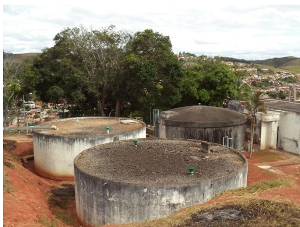
FIGURA 28 – RESERVATÓRIOS R1, R2 E R3 (FONTE: VALLENGE, 2014)
