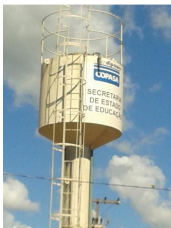
FIGURA 40 – RESERVATÓRIO COPASA ESCOLA OMAR REZENDE PEREZ (FONTE: VALLENGE, 2014)
