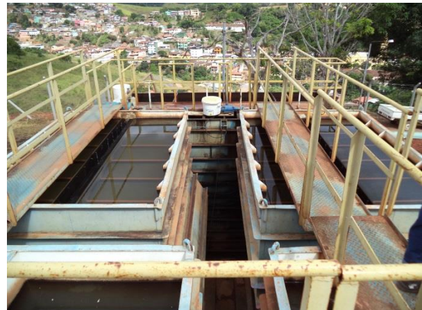
FIGURA 25 – ETA COMPACTA (VISTA 2) (FONTE: VALLENGE, 2014)
