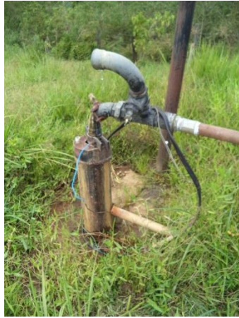
FIGURA 20 – POÇO 2 (FONTE: VALLENGE, 2014)
