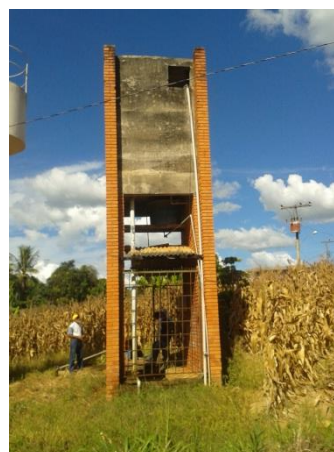
FIGURA 41 – RESERVATÓRIO ESTADO ESCOLA OMAR REZENDE PEREZ (FONTE: VALLENGE, 2014)
