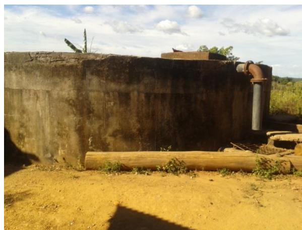
FIGURA 39 – RESERVATÓRIO DESATIVADO ÁGUAS FÉRREAS (CAIXA DE PASSAGEM) (FONTE: VALLENGE, 2014)
