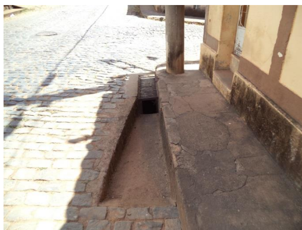
FIGURA 62 – DISPOSITIVOS DE MICRODRENAGEM (VISTA 2) (FONTE: VALLENGE, 2014)
