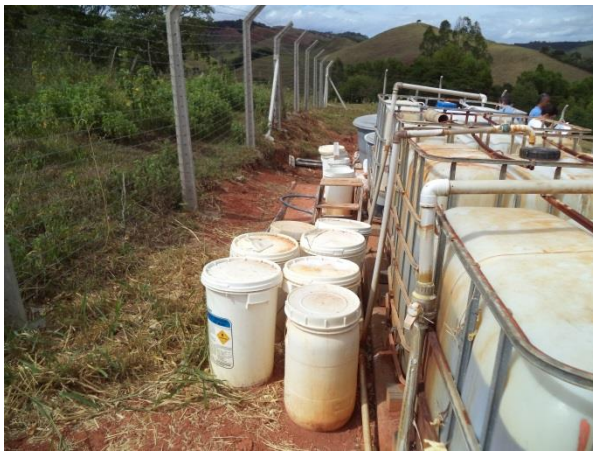
FIGURA 26 – ETA COMPACTA (VISTA 3) (FONTE: VALLENGE, 2014)
