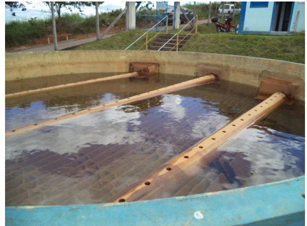
FIGURA 23 – ETA COMPACTA (VISTA 4) (FONTE: VALLENGE, 2014)
