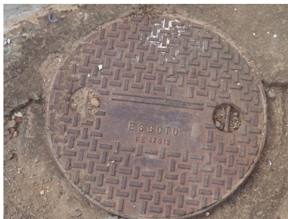
FIGURA 30 – REDE DE ESGOTO – POÇO DE VISITA (FONTE: VALLENGE, 2014)
