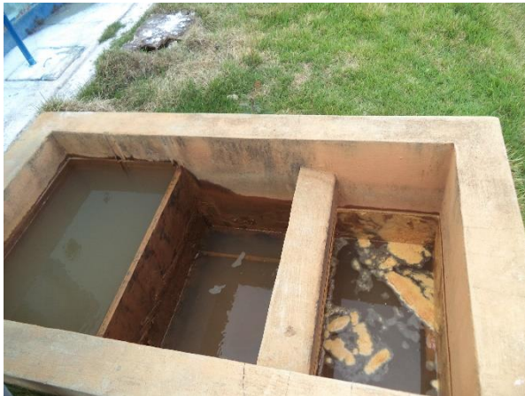
FIGURA 22 – ETA COMPACTA (VISTA 3) (FONTE: VALLENGE, 2014)
