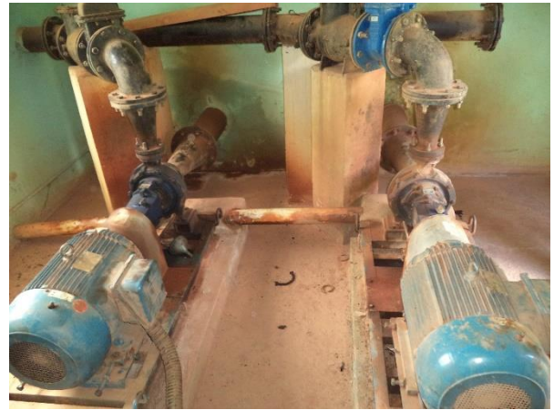
FIGURA 19 – CAPTAÇÃO (VISTA 2) (FONTE: VALLENGE, 2014)
