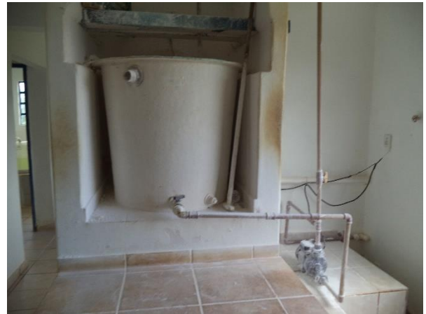
FIGURA 25 – ETA COMPACTA (VISTA 6) (FONTE: VALLENGE, 2014)
