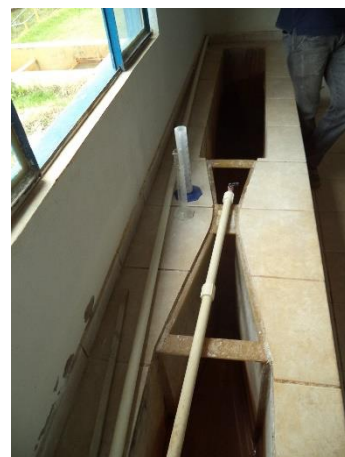
FIGURA 21 – ETA COMPACTA (VISTA 2) (FONTE: VALLENGE, 2014)
