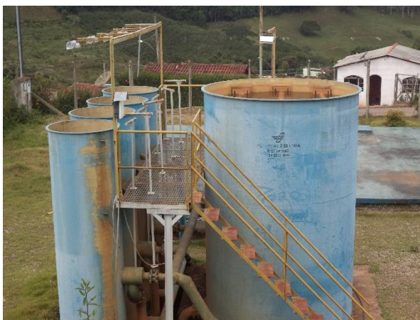
FIGURA 20 – ETA COMPACTA (VISTA 1) (FONTE: VALLENGE, 2014)
