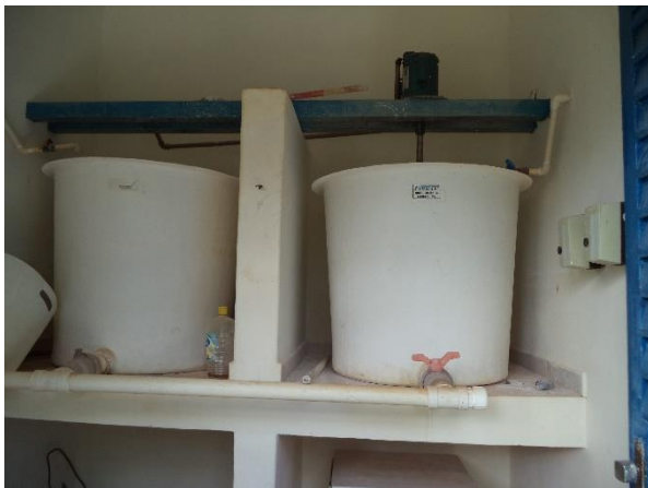
FIGURA 26 – ETA COMPACTA (VISTA 7) (FONTE: VALLENGE, 2014)
