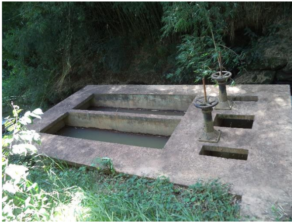
FIGURA 18 – CAPTAÇÃO (VISTA 1) (FONTE: VALLENGE, 2014)
