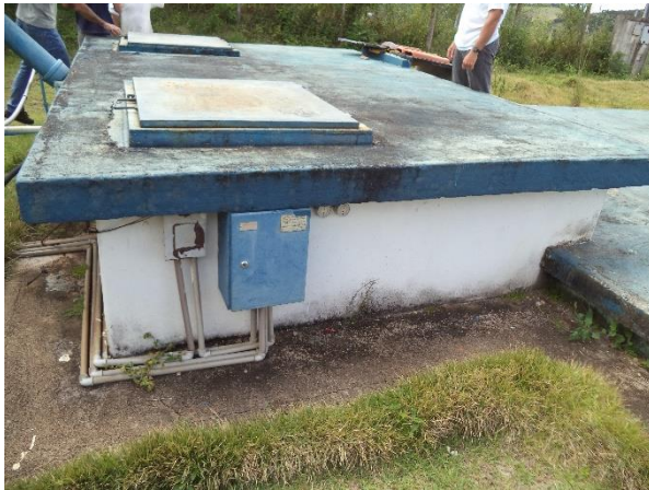
FIGURA 24 – ETA COMPACTA (VISTA 5) (FONTE: VALLENGE, 2014)
