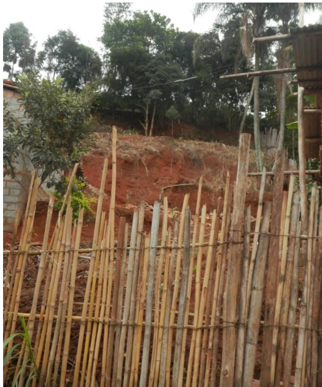
Figura 61 – Erosão em morro de Araponga
