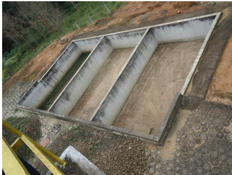
Figura 30 – Leitos de secagem de lodo (ETE)
