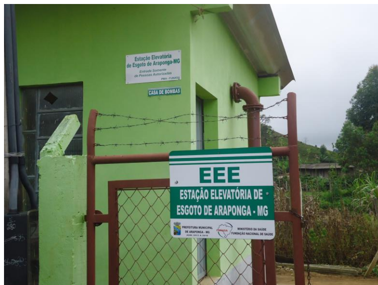
Figura 32 – Estação Elevatória de Esgoto
