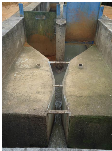
Figura 26 – Calha Parshall (ETE)
