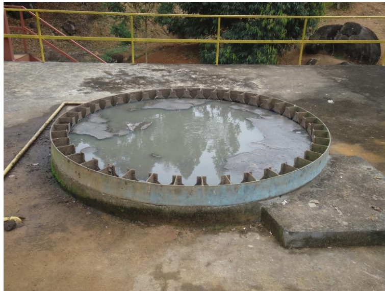
Figura 27 – Reator anaeróbio - vista do topo (ETE)
