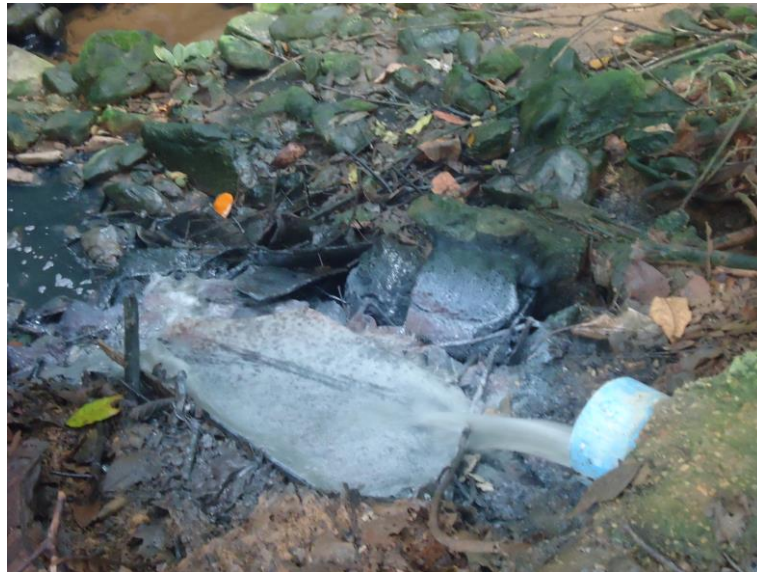
Figura 31 – Emissário final (ETE)
