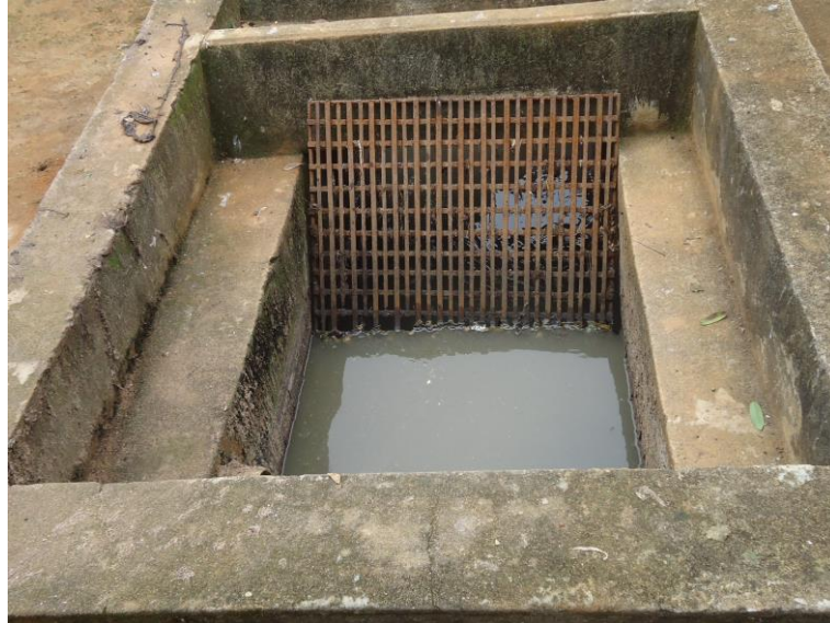
Figura 25 – Grade para retenção de sólidos grosseiros (ETE)
