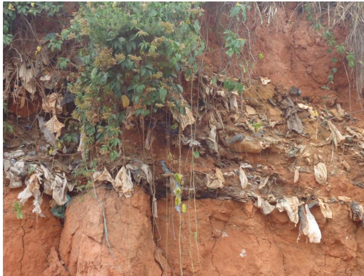
Figura 73 – Talude expondo depósitos antigos de lixo
