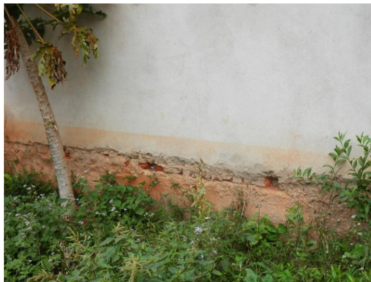
Figura 51 – Marca de inundação de 0,8m.
