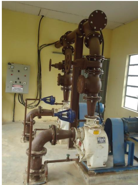
Figura 33 – Bombas para recalque de esgotos (15cv de potência cada)
