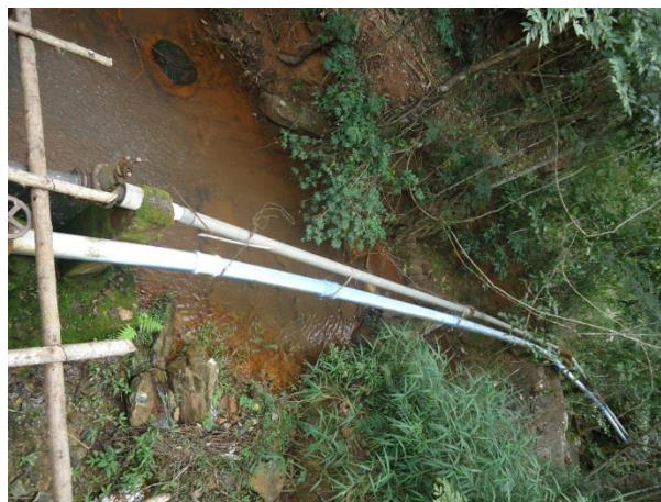
Figura 18 - Adutoras de captação de água
