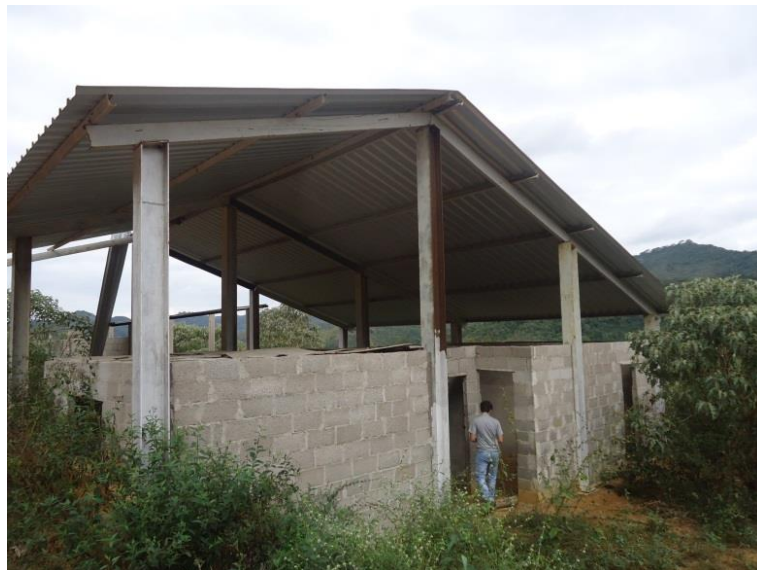
Figura 44 - Usina de Triagem e compostagem de resíduos sólidos
