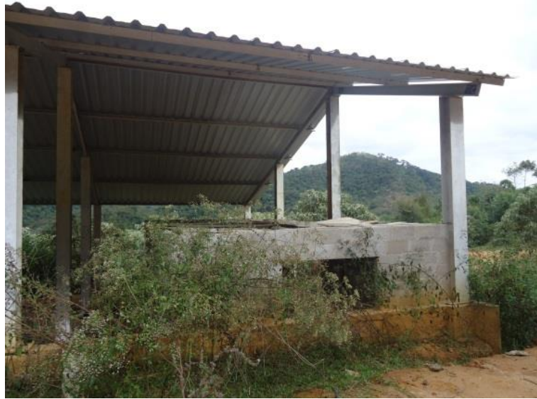
Figura 43 - Usina de triagem e compostagem de resíduos sólidos
