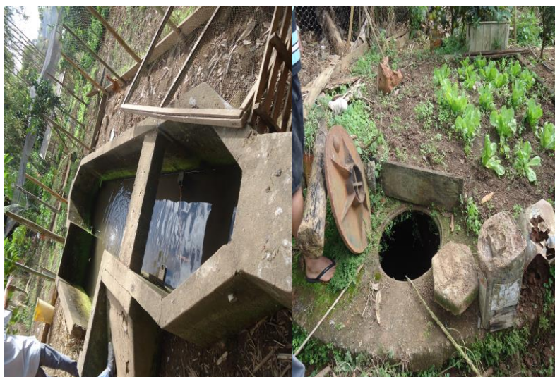
Figura 22 - Local da ETE inoperante (Sede)
