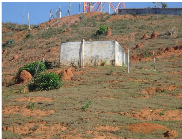
Figura 18 – Reservatório de abastecimento público (capacidade – 30m 3 )
