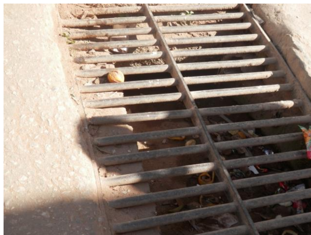
Figura 40 – Detalhe da rede de drenagem
