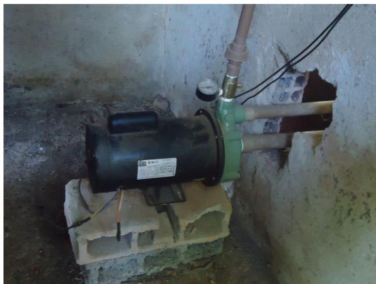
Figura 19 – Conjunto moto-bomba – Captação de água distrito de Padre Felisberto
