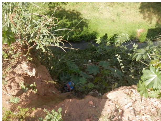
Figura 46 – Margem do ribeirão em processo de erosão
