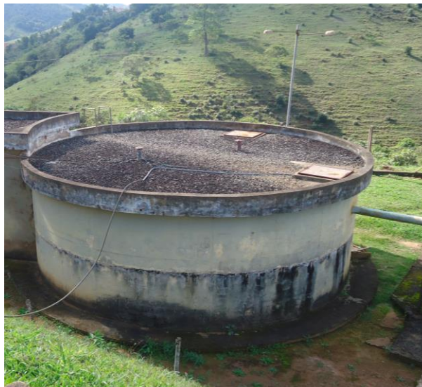
Figura 17 – Reservatório de abastecimento público (capacidade – 100m 3 )
