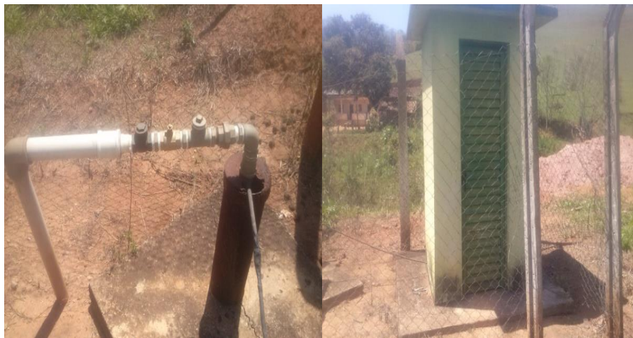
Figura 18 – Poço artesiano (Bela Vista)
