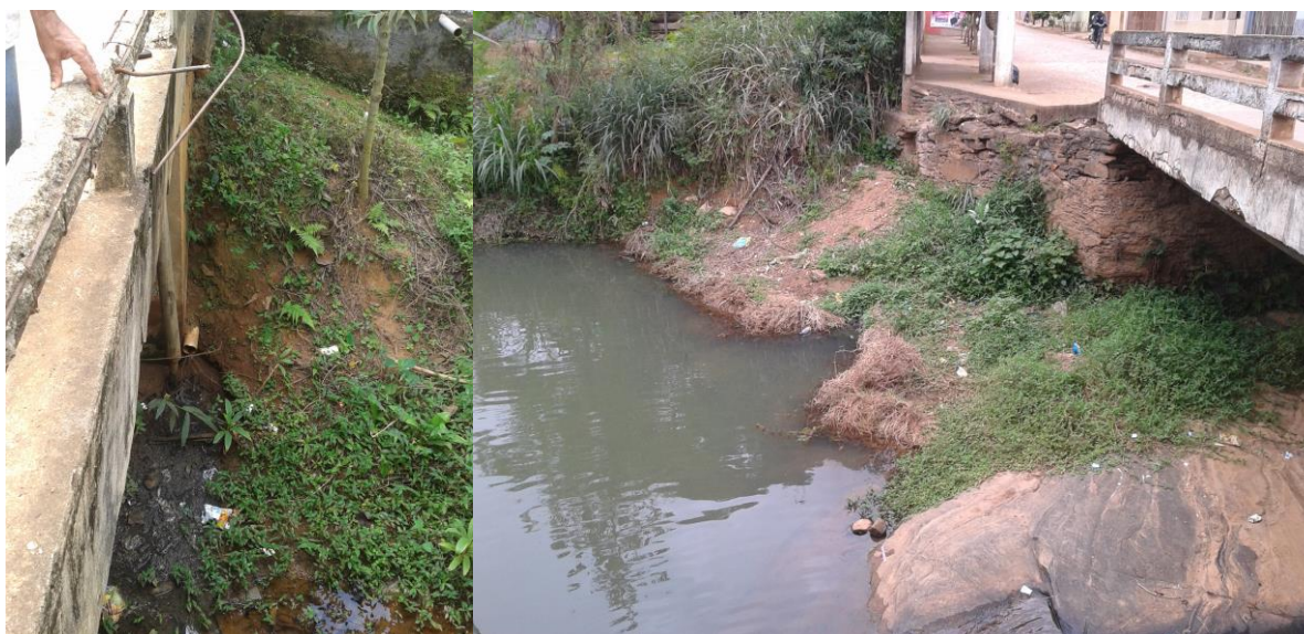
Figura 30 - Lançamento de esgotos 01
