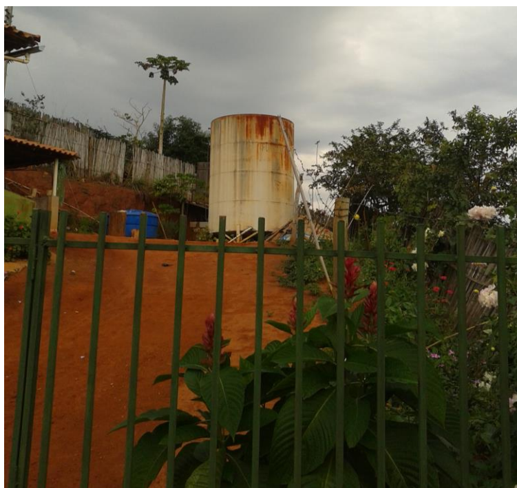
Figura 25 - Reservatório de água de Zito Soares
