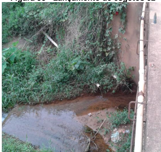
Figura 38 - Lançamento de esgotos 02
