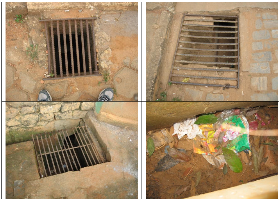
Figura 65 - Caixas coletoras da sede municipal
