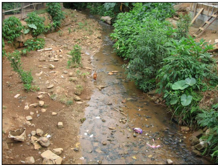
Figura 73 - Exemplo de margens dos corpos d'água sem vegetação nas margens
