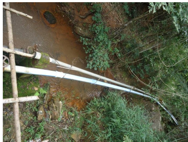
Figura 3 - Adutoras de captação de água
