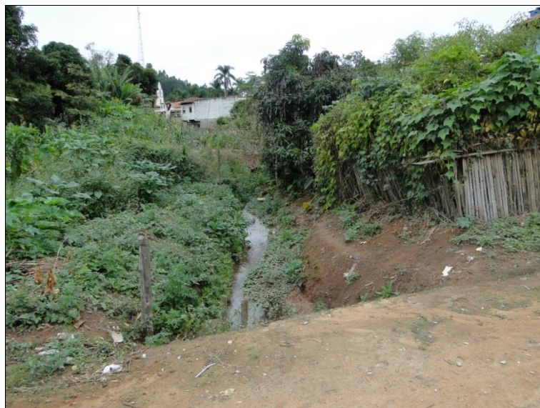
Figura 60 - Ponte sobre o córrego afluente do córrego dos Pintos - vista de jusante para montante
