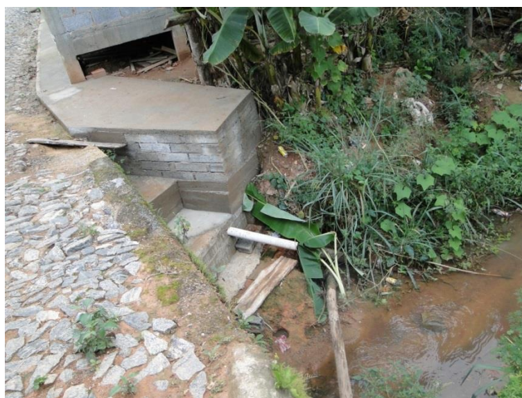
Figura 25 - Lançamento de esgotos in natura - Abreus
