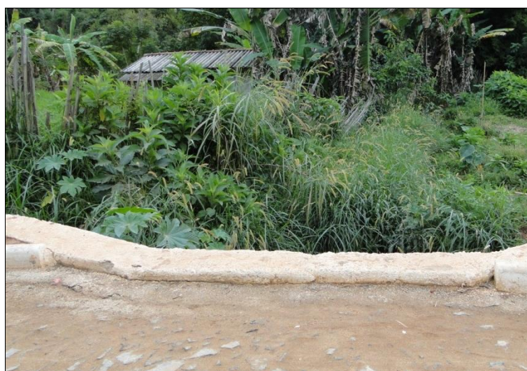
Figura 40 - Ponte sobre córrego afluente do ribeirão Conceição - vista a montante onde ocorre inundação
