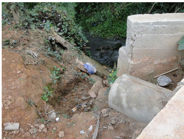
Figura 85 - Ponte sobre o córrego afluente do ribeirão Conceição (tubulação para lançamento de águas pluviais sem dissipação de energia, causando erosão)
