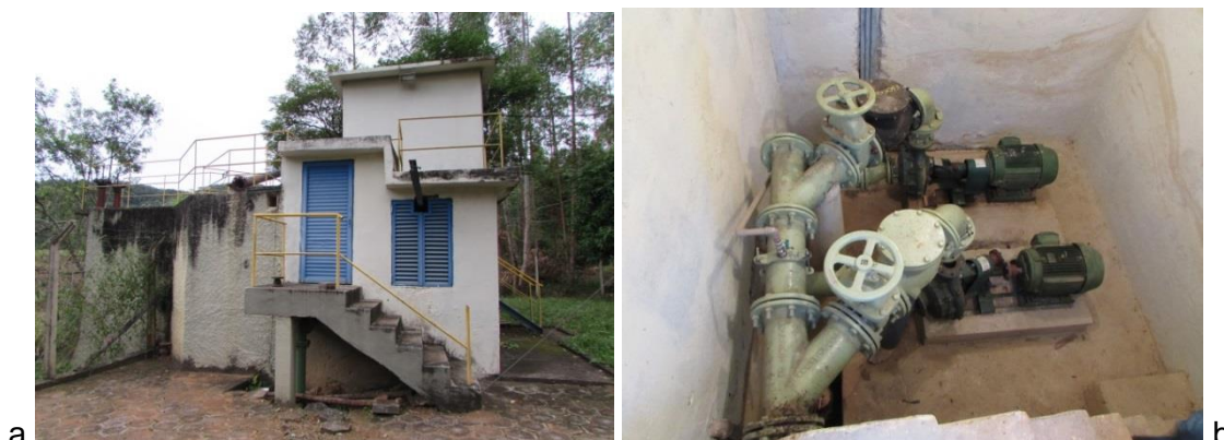
Figura 2 - Estação Elevatória da água bruta
