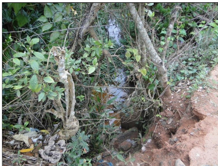
Figura 54 - Ponte sobre córrego afluente do córrego dos Pintos - tubulação de passagem e vista a jusante da ponte
