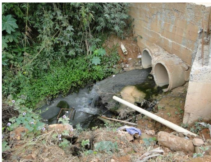
Figura 22 - Lançamento de esgotos in natura (sede)
