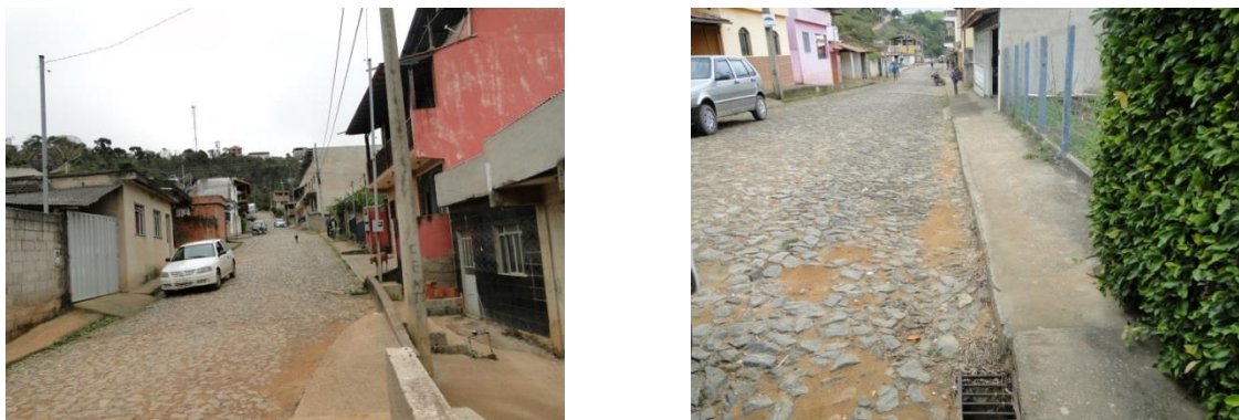
Figura 50 - Ausência de sarjeta
