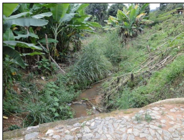
Figura 58 - Ponte sobre o córrego afluente do córrego dos Pintos - vista de montante para jusante
