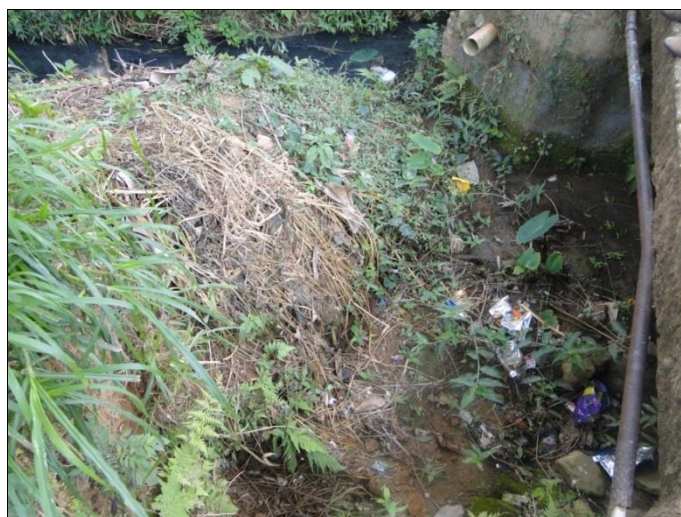
Figura 45 - Ponte sobre o córrego do Alto Rio Doce (vista de jusante para montante)
