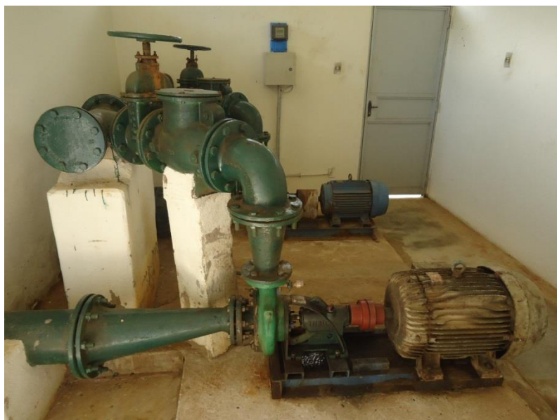
Figura 2 - Estação elevatória de água tratada da ETA da sede
