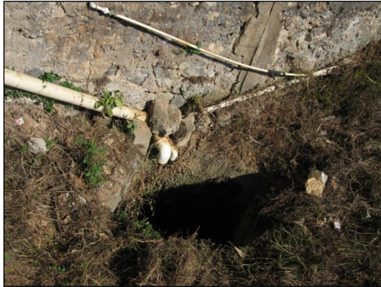
Figura 68 - Lançamento de esgoto na rede de microdrenagem
