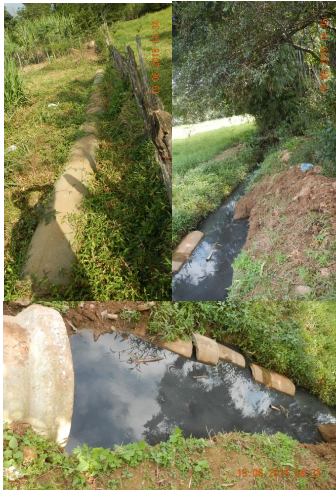
Figura 49 - Rede de esgoto de Fonseca
