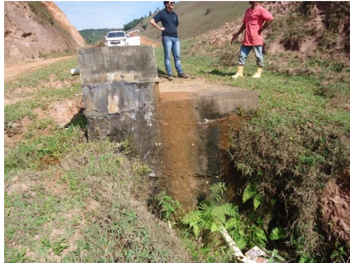
Figura 9 - Reservatório principal de água de Major Ezequiel
