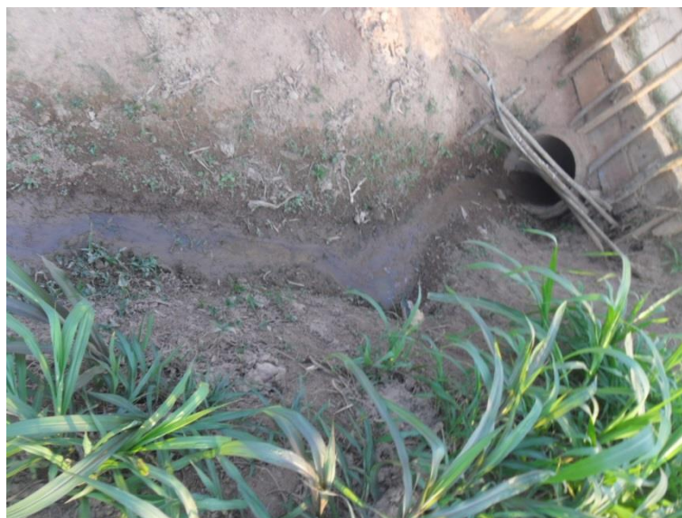
Figura 52 - Lançamento de esgotos de Terras 02
