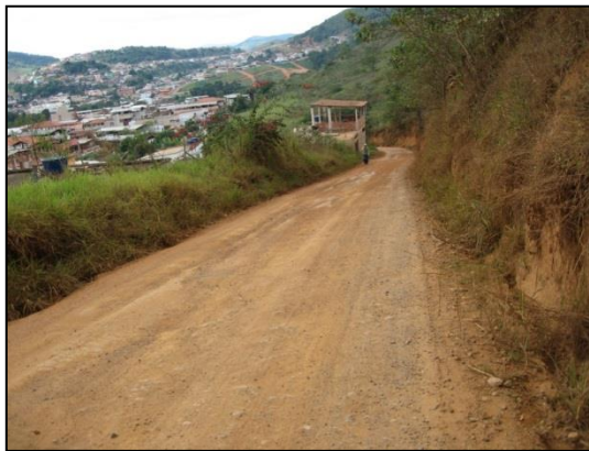
Figura 99 - Pequenas erosões ligadas à falta de pavimentação
