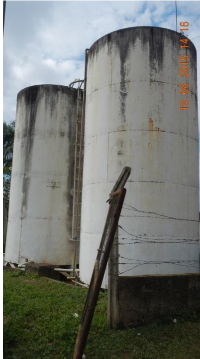
Figura 24 - Reservatório de água das captações superficiais de Fonseca
