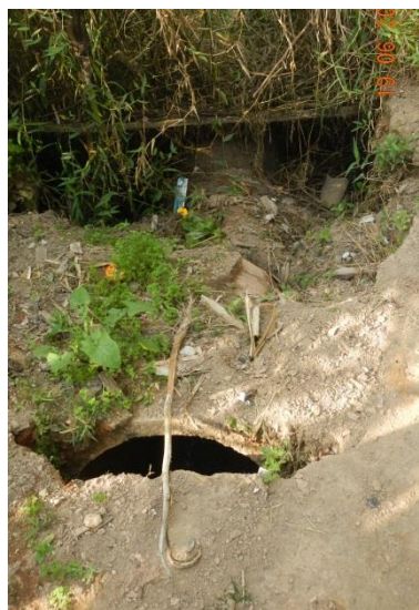
Figura 50 - Rede de esgoto rompida localizada aos fundos de uma residência em Fonseca
