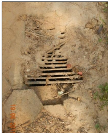
a - Colmatção da rede de microdrenagem
