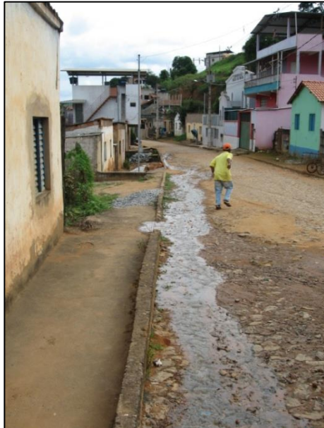
a- Via com poucas bocas de lobo e ausência de sarjetas.
