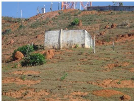
Figura 4 - Reservatório de abastecimento público (capacidade - 30m 3 )
