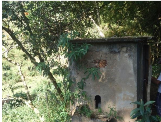
Figura 3 - Casa de bomba (distrito de Padre Felisberto)
