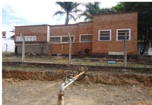
Figura 2 - Poço de captação localizado próximo à ETA
