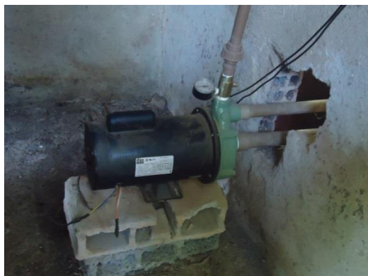
Figura 5 - Conjunto motobomba - Captação de água distrito de Padre Felisberto
