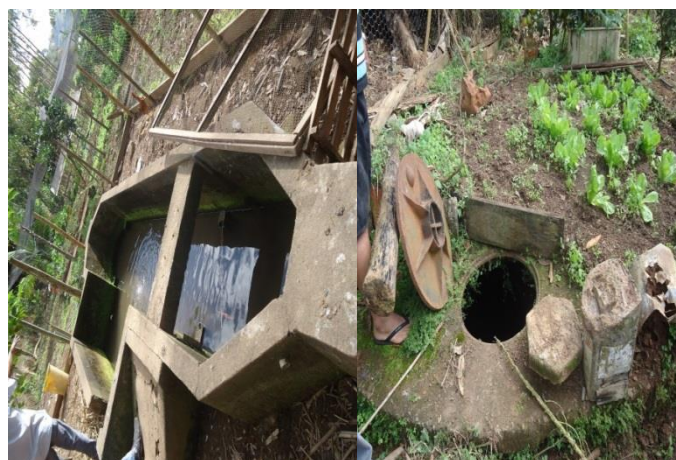
Figura 14 - Local da ETE inoperante (Sede)
