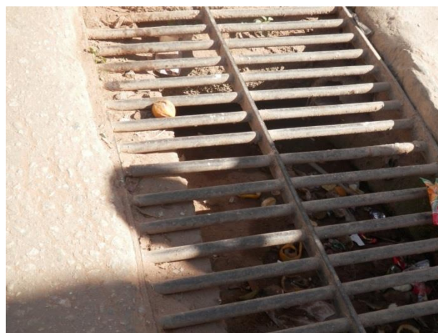
Figura 33 - Detalhe da rede de drenagem
