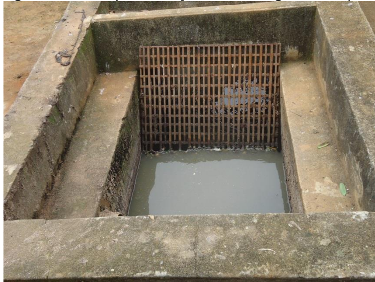
Figura 15 - Grade para retenção de sólidos grosseiros (ETE)
