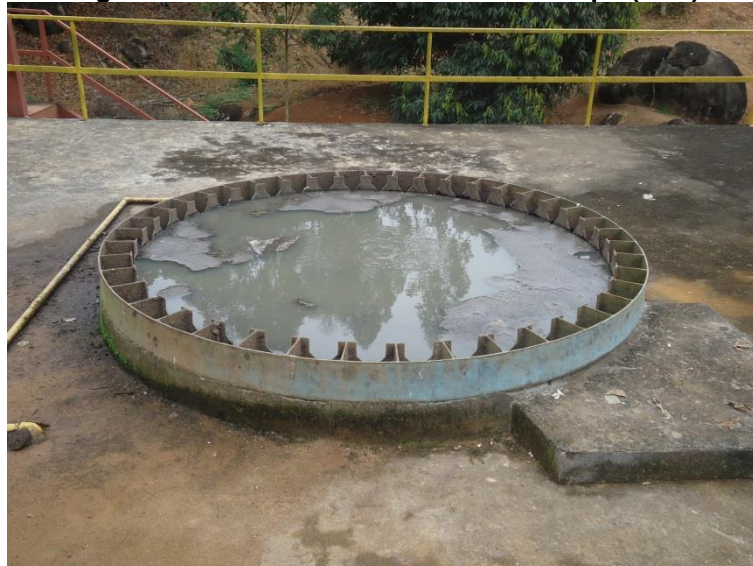
Figura 17 - Reator anaeróbio - vista do topo (ETE)
