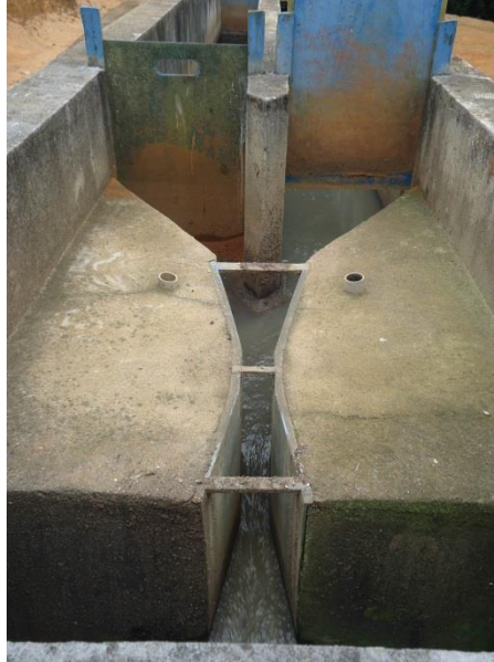
Figura 16 - Calha Parshall (ETE)
