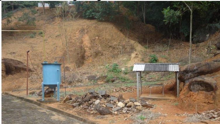
Figura 19 - Coletor de gases gerados no tratamento dos efluentes
