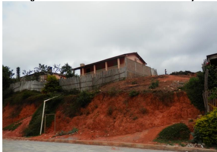
Figura 52 - Erosão no distrito de Estevão Araújo
