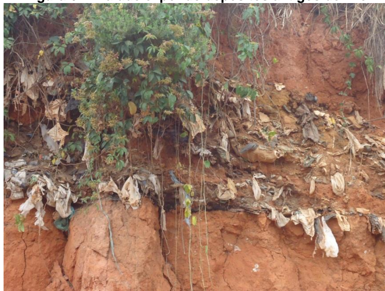
Figura 64 - Talude expondo depósitos antigos de lixo
