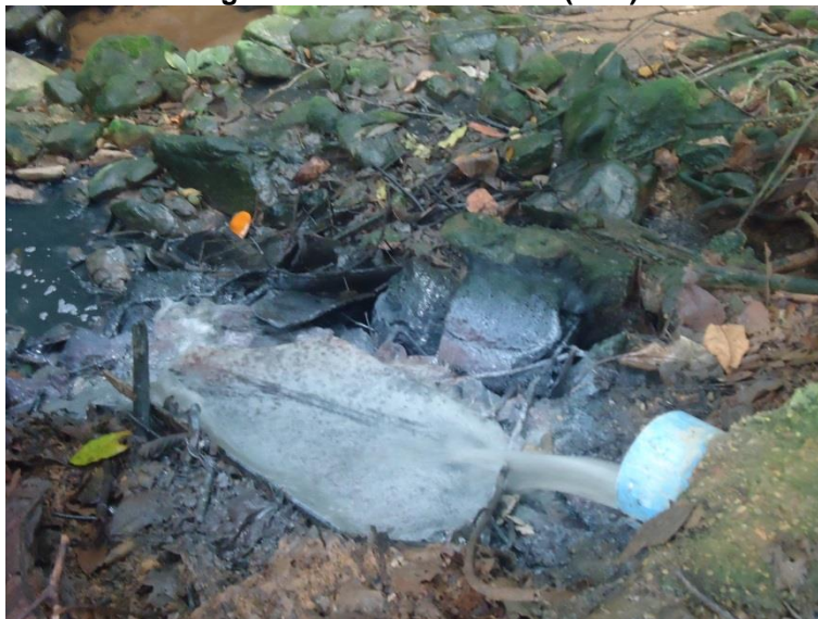
Figura 21 - Emissário final (ETE)
