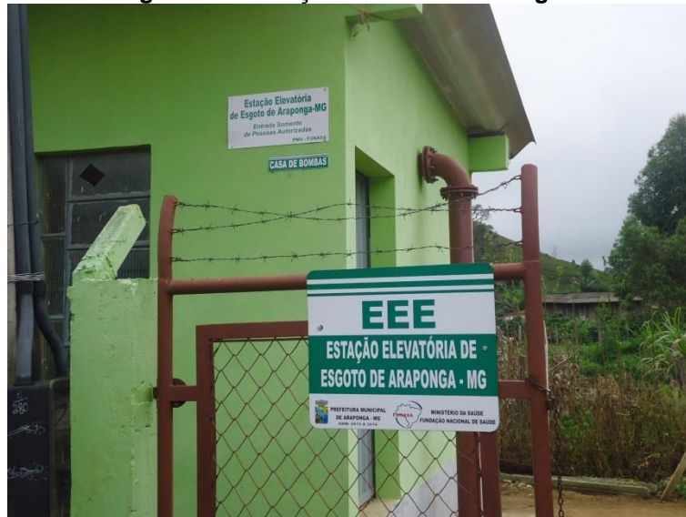
Figura 22 - Estação Elevatória de Esgoto
