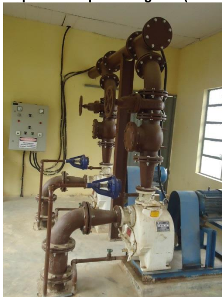
Figura 23 - Bombas para recalque de esgotos (15cv de potência cada)
