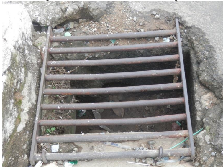
Figura 44 - Detalhe da rede de drenagem
