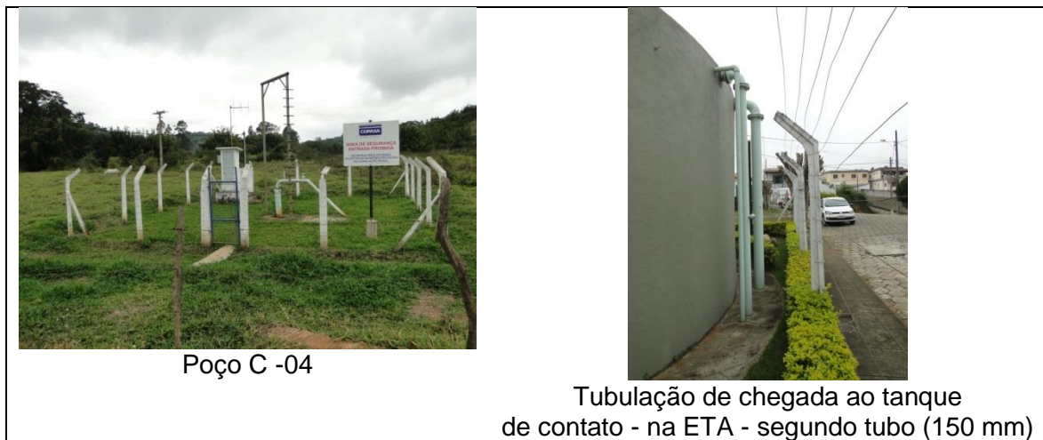
Figura 2 - Captação subterrânea - Poço C04
