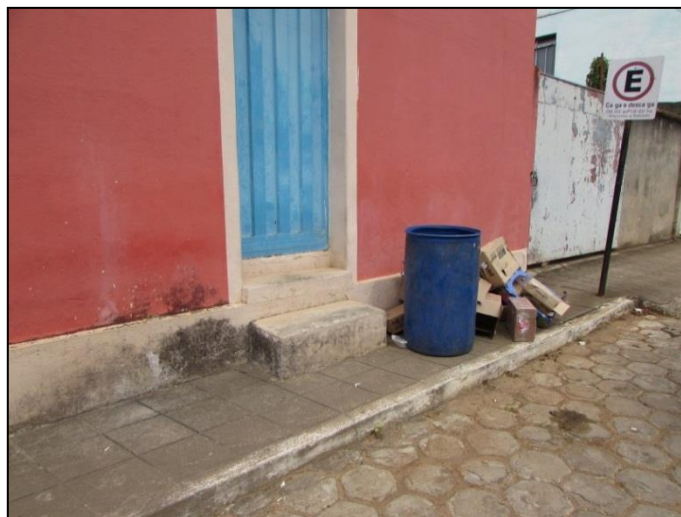
Figura 38 - Ausência de sarjeta
