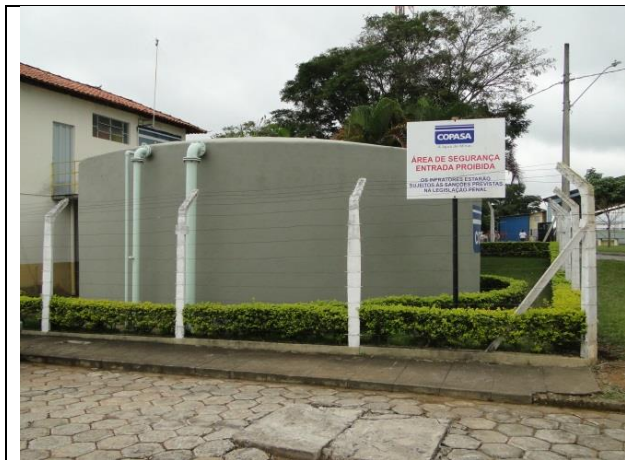
Tanque de contato
