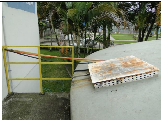
Tubulações para dosagem de cloro e flúor no tanque de contato
