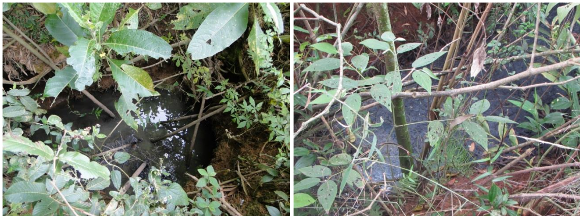
Figura 15 - Lançamentos de esgoto a céu aberto na sede
