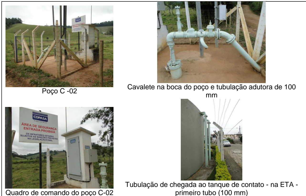
Figura 1 - Captação subterrânea - Poço C02
