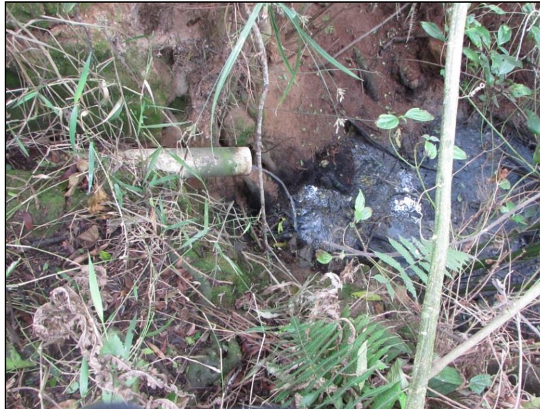
Figura 40 - Lançamento de esgoto sem tratamento no córrego Caiçara
