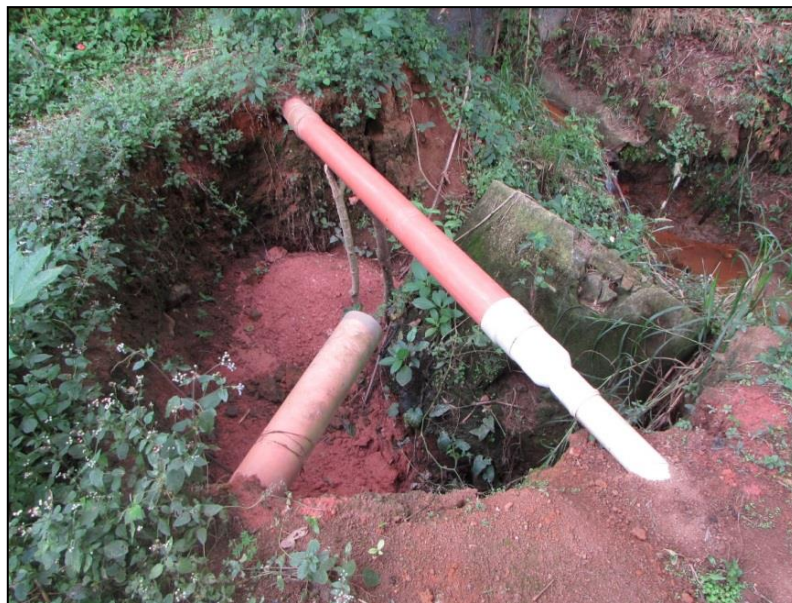
Figura 43 - Erosão causada pelo lançamento de águas pluviais sem dissipação de energia
