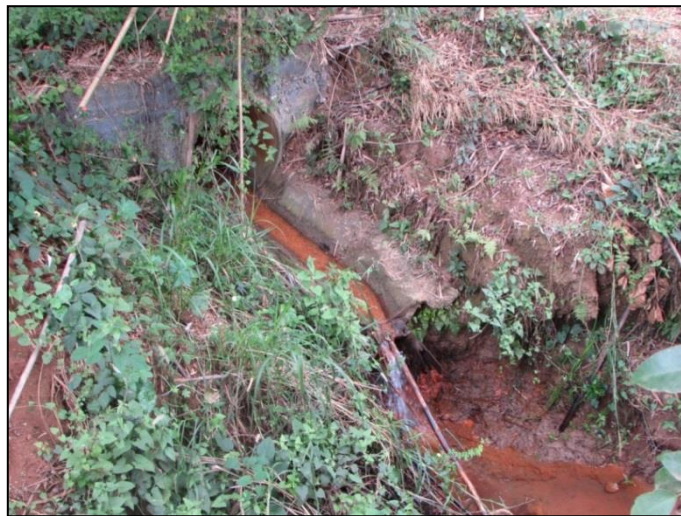
Figura 39 - Lançamento de águas pluviais sem dissipador de energia
