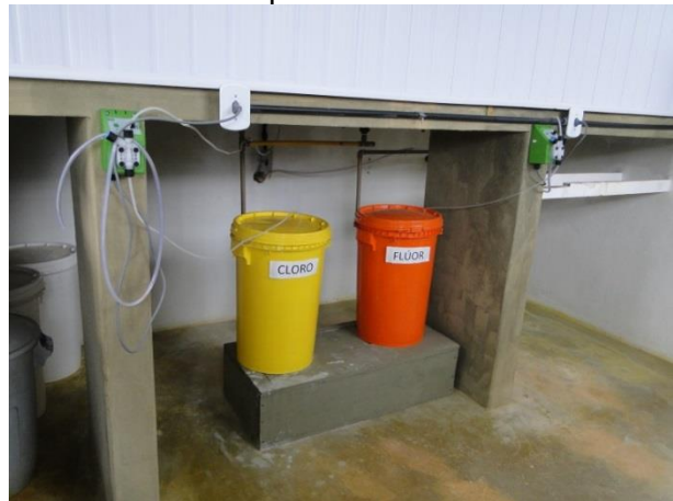
Bombas dosadoras de cloro e flúor
