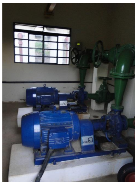
Figura 3 - Estação Elevatória de água tratada
