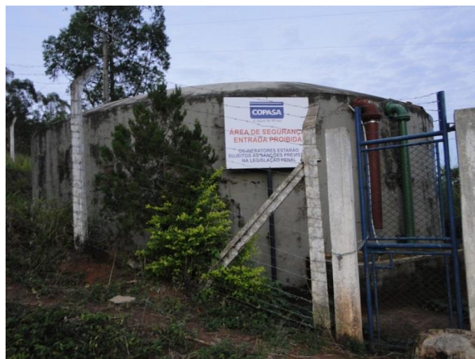
Figura 2 - Reservatório de água tratada
