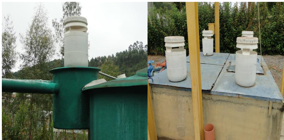
Figura 15 - Filtros de ar (ETE e EEE)
