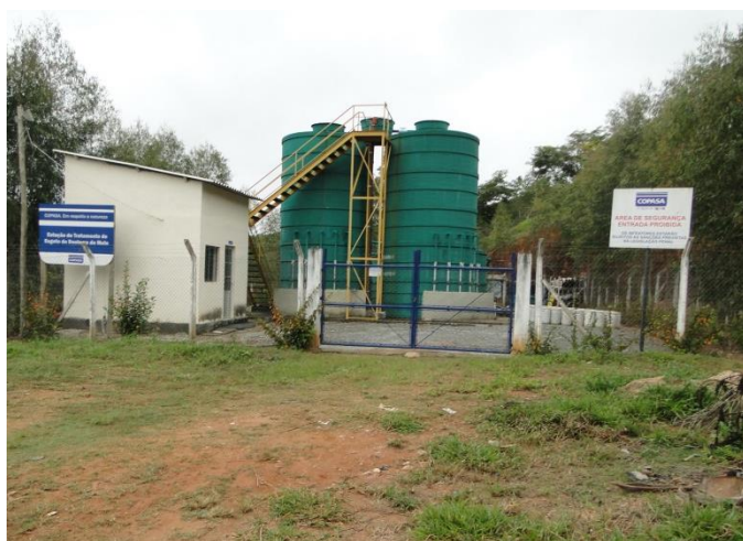
Figura 12 - Estação de Tratamento de Esgotos
