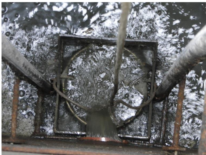
Figura 11 - Estação Elevatória de Esgotos (EEE)
