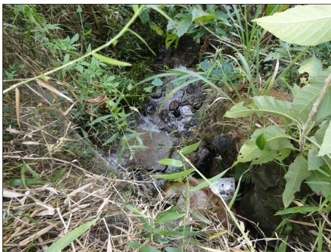
Figura 36 - Ponto onde o curso d'água deixa de ser canalizado - sem dissipação de energia
