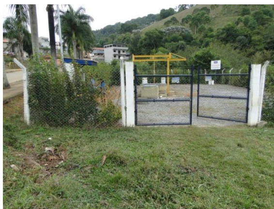
Figura 10 - Estação Elevatória de Esgotos (EEE)
