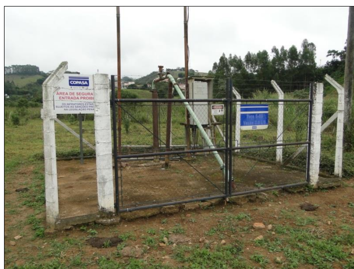
Figura 1 - Poço tubular fundo C-05
