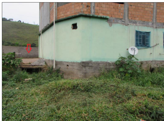
Figura 32 - Vista das proximidades da Ponte 4 sobre o córrego água Santa, afluente do rio Xopotó
