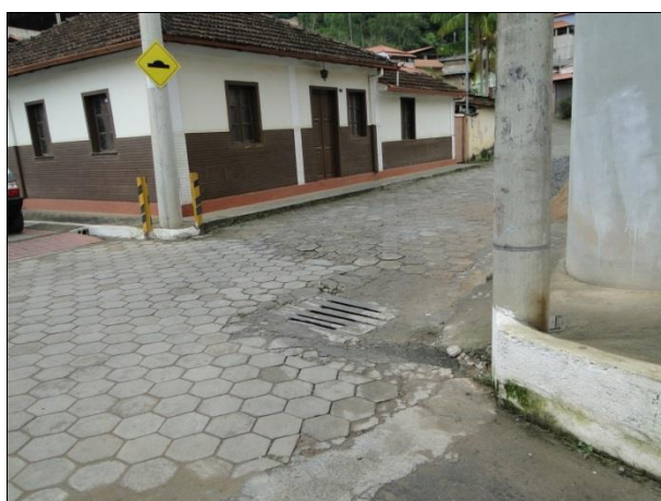
Figura 39 - Ausência de sarjetas
