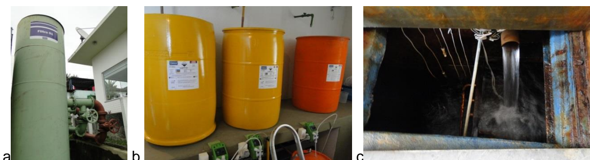
Figura 3 - Equipamentos da unidade de tratamento da água
