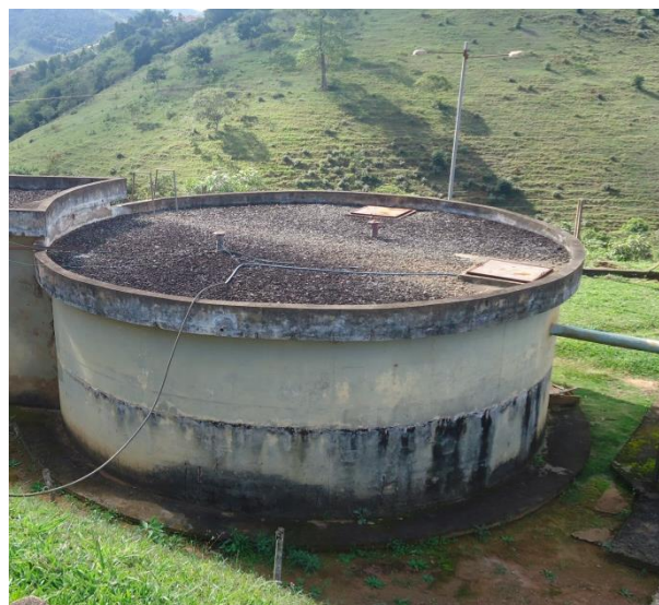
Figura 3 - Reservatório de abastecimento público (capacidade - 100m 3 )
