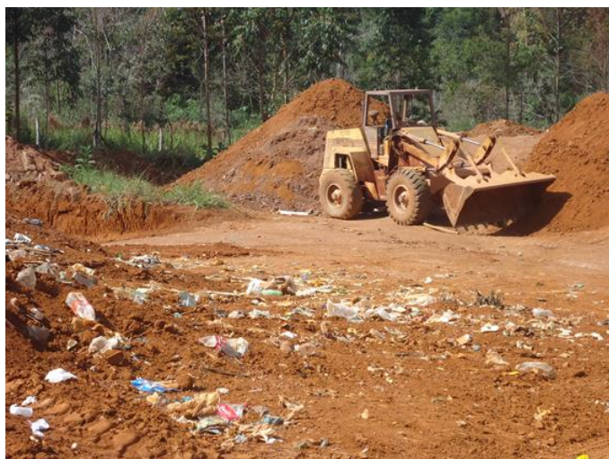
Figura 21 - Vala de disposição de resíduos sólidos
