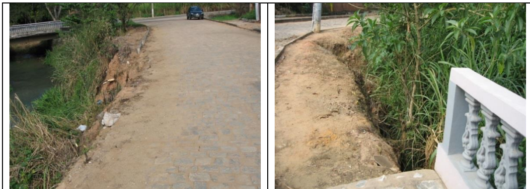
Figura 26 - Desestabilização de talude devido à ausência da infraestrutura de drenagem eficiente
