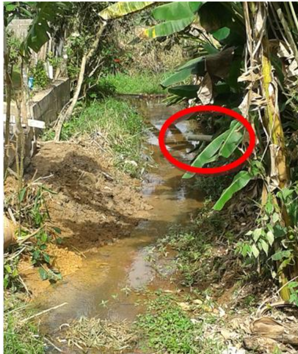
Figura 11 - Lançamentos diretos no córrego da Sidra
