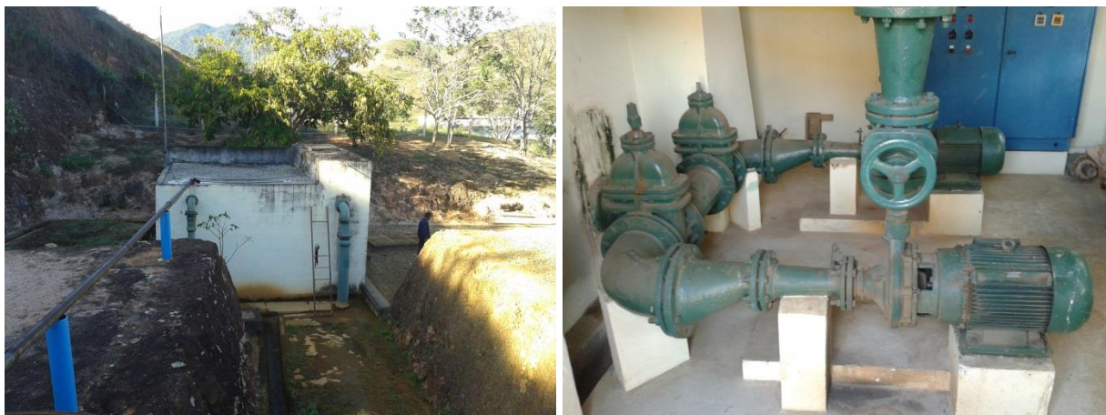
Figura 3 - Estação elevatória de água tratada
