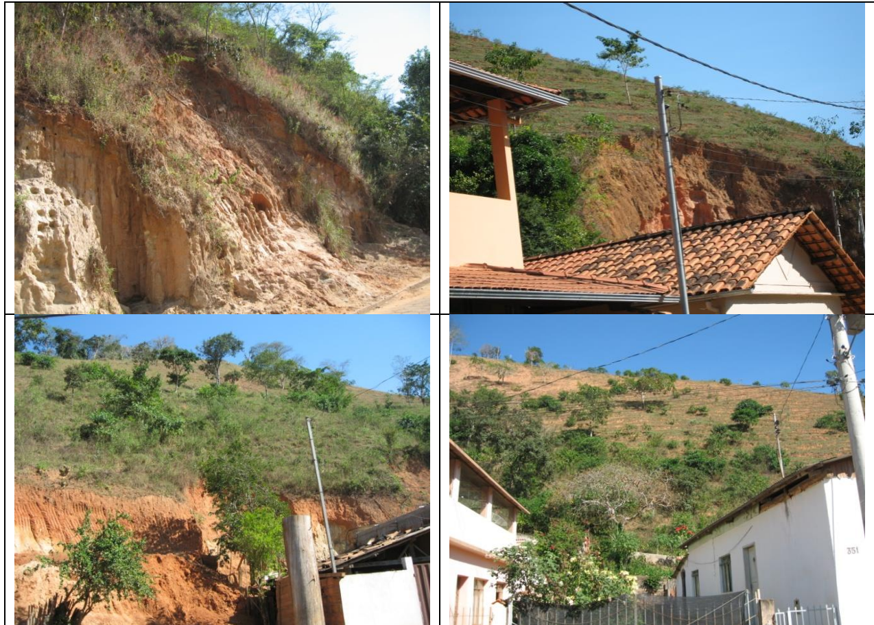
Figura 46 - Ocupação do solo e erosão.
