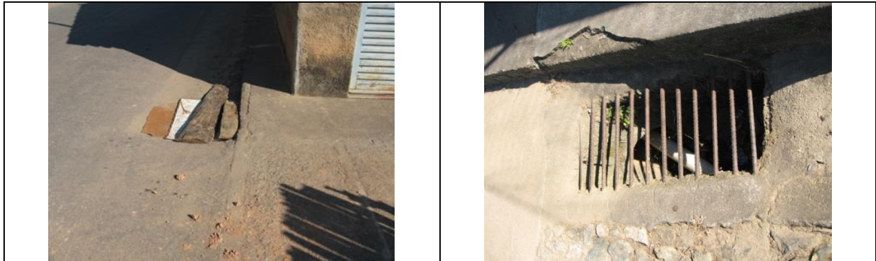
Figura 25 - Subutilização da rede de drenagem com lançamentos de esgoto.
