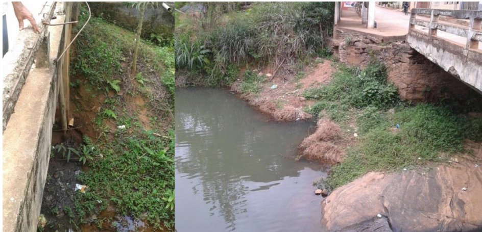
Figura 24 - Lançamento de esgotos 01
