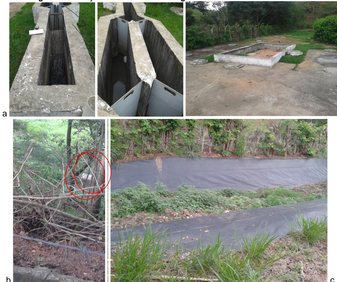
Figura 30 - Estação de Tratamento de Esgoto de São Sebastião do Soberbo
