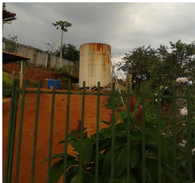
Figura 11 - Reservatório de água de Zito Soares
