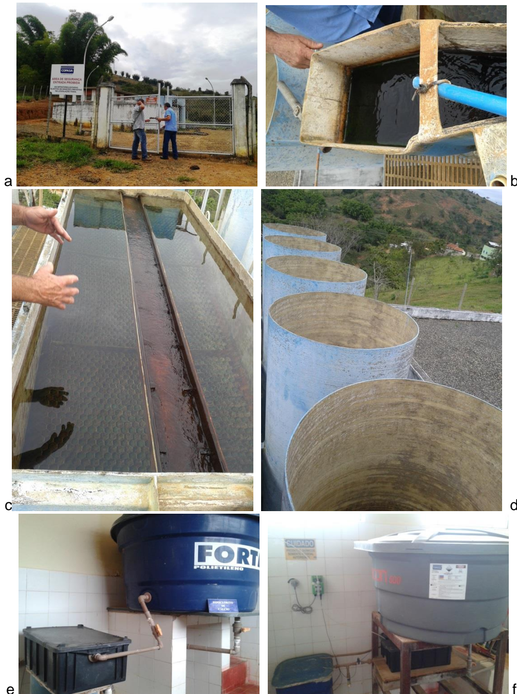
Figura 3 - Estação de Tratamento de Água da sede
