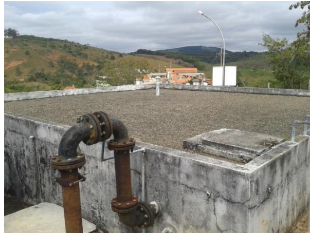
Figura 4 - Reservatório de água tratada
