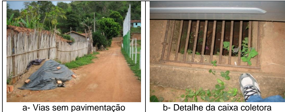
Figura 60 - Bocas coletoras do distrito de Zito Soares
