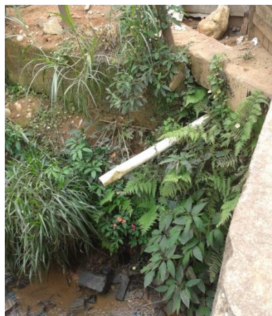
Figura 25 - Lançamento de esgotos 02
