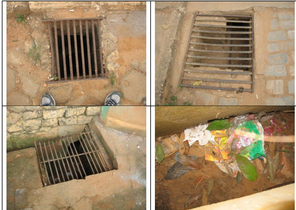
Figura 59 - Caixas coletoras da sede municipal
