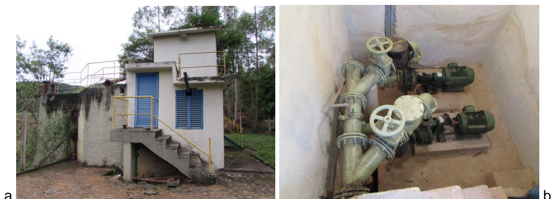
Figura 19 – Estação Elevatória da Água Bruta
