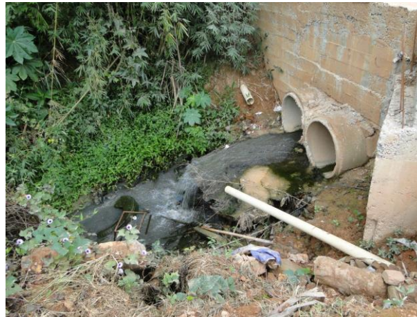
Figura 29 – Lançamento de esgotos in natura (sede)
