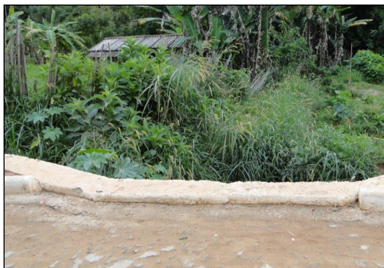
Figura 42 – Ponte sobre córrego afluente do ribeirão Conceição – vista a montante onde ocorre inundação
