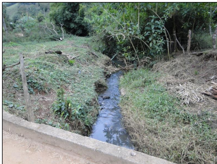
Figura 83 – Ponte sobre o córrego da Vaca – vista de montante para jusante para montante
