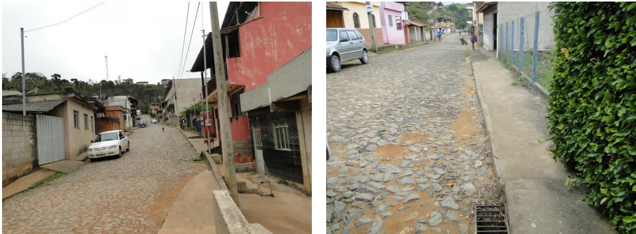
Figura 52 – Ausência de sarjeta
