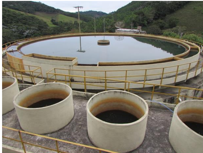
Figura 20 – ETA da sede do município de Alto Rio Doce
