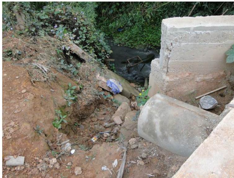
Figura 87 – Ponte sobre o córrego afluente do ribeirão Conceição (tubulação para lançamento de águas pluviais sem dissipação de energia, causando erosão)
