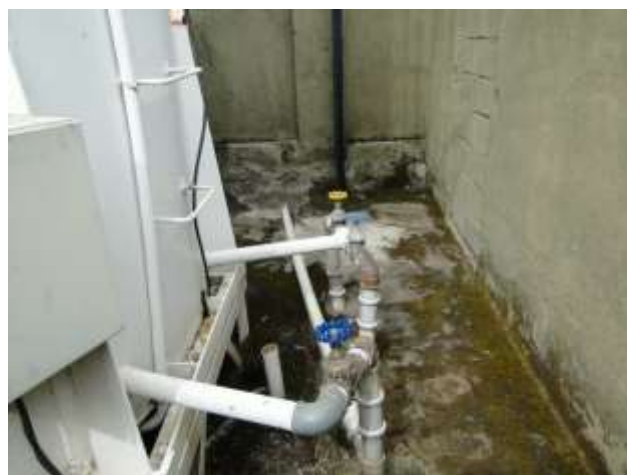
Tubulações de chegada e saída da água do reservatório
