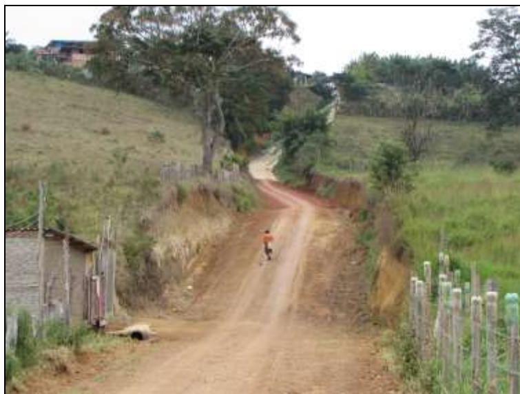
Figura 44 - Via sem pavimentação
