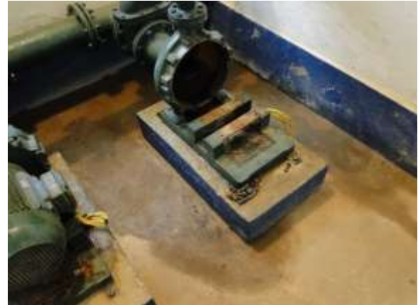
Instalações hidráulicas da bomba reserva
