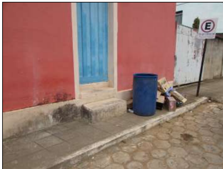
Figura 48 - Ausência de sarjeta
