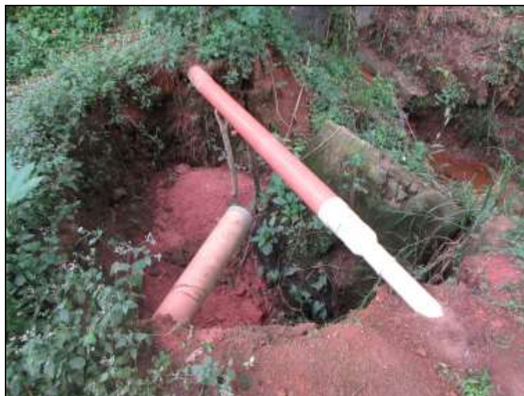
Figura 53 - Erosão causada pelo lançamento de águas pluviais sem dissipação de energia
