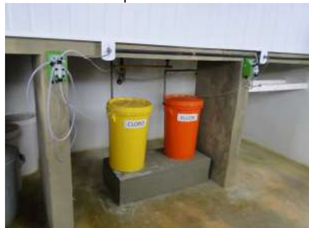
Bombas dosadoras de cloro e flúor
