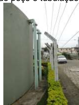
Tubulação de chegada ao tanque de contato – na ETA – primeiro tubo (100 mm)
