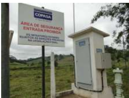
Quadro de comando do poço C-02
