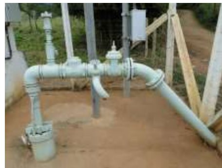
Cavalete na boca do poço e tubulação adutora de 100 mm
