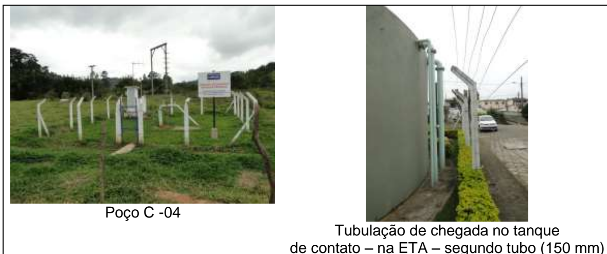
Figura 16 - Captação subterrânea – Poço C04
