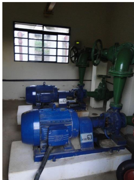
Figura 19 - Estação elevatória de água tratada
