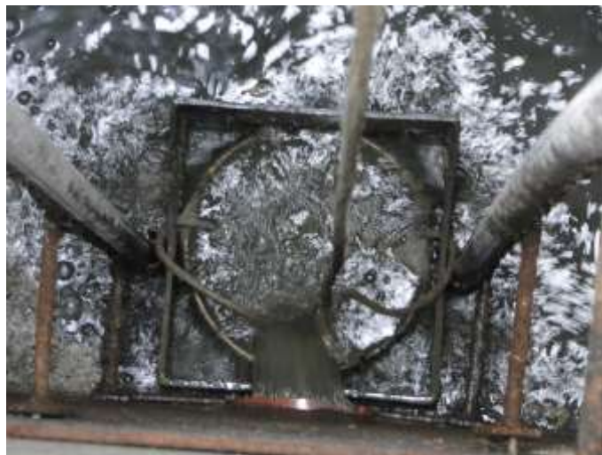
Figura 23 – Estação elevatória de esgotos (EEE)
