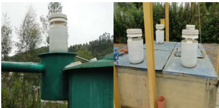
Figura 27 – Filtros de ar (ETE e EEE)
