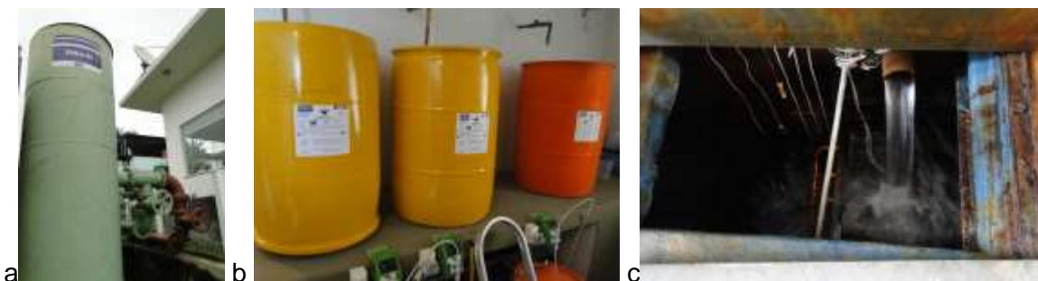
Figura 18 – Equipamentos da unidade de tratamento da água
