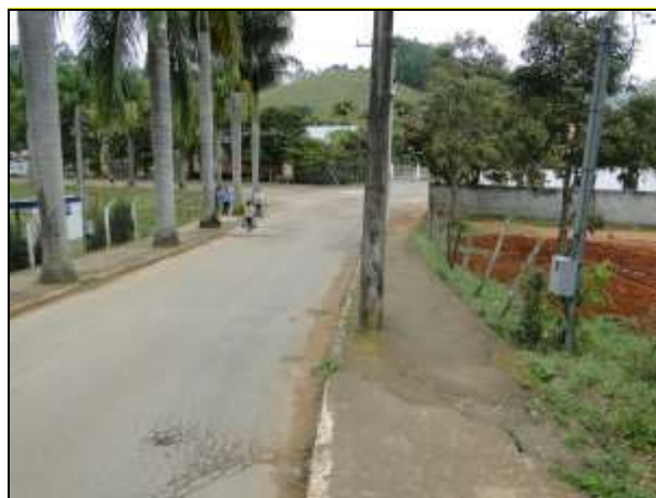
Figura 45 – Rua pavimentada com asfalto – cruzamento entre a Av. Francisco Afonso Filho e Prof. Joaquim Magalhães de Sousa, onde ocorrem alagamentos
