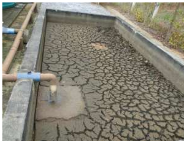
Figura 26 – Leitos de secagem de lodos
