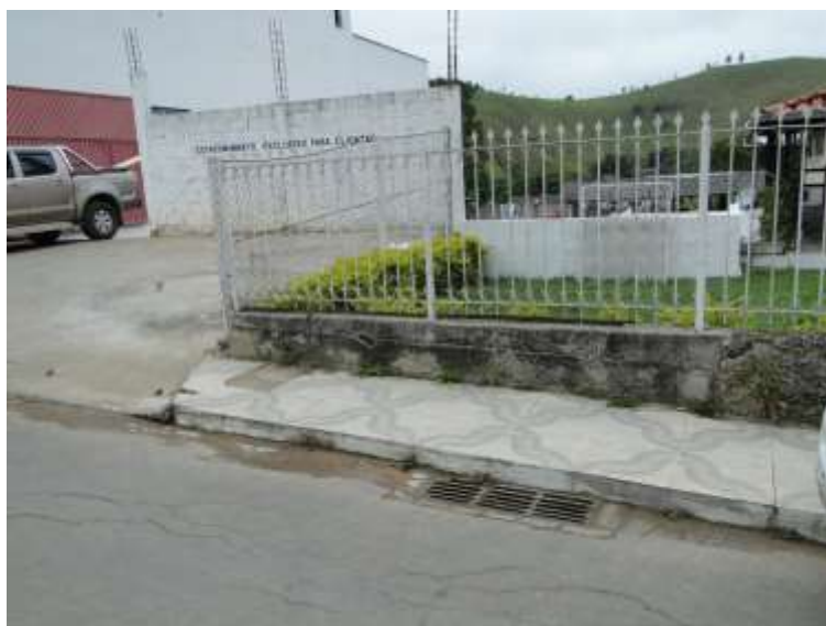
Figura 48 – Detalhe da rede de drenagem
