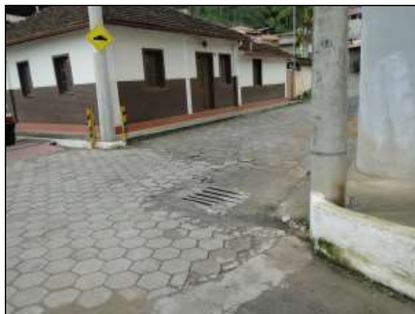
Figura 46 – Ausência de sarjetas
