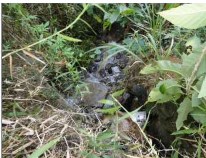
Figura 43 – Ponto onde o curso d'água deixa de ser canalizado – sem dissipação de energia
