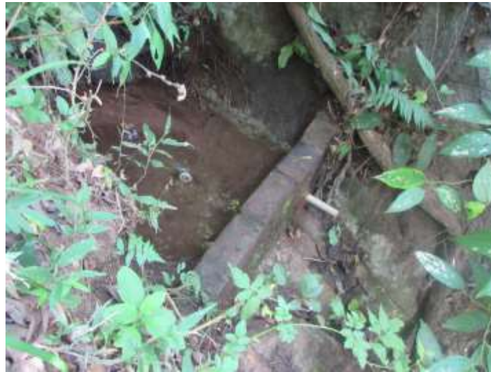
Figura 31 - Captação superficial de água de Japão
