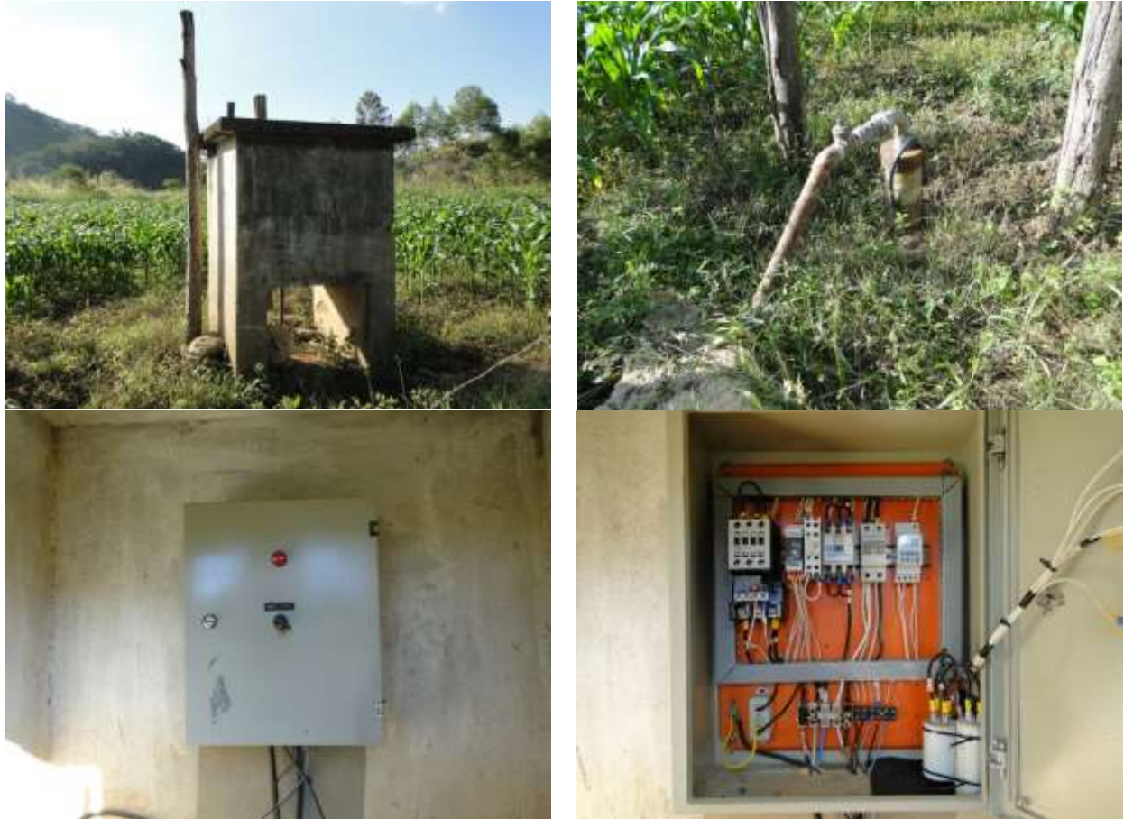
Figura 29 - Captação subterrânea de água de Palmital dos Carvalhos
