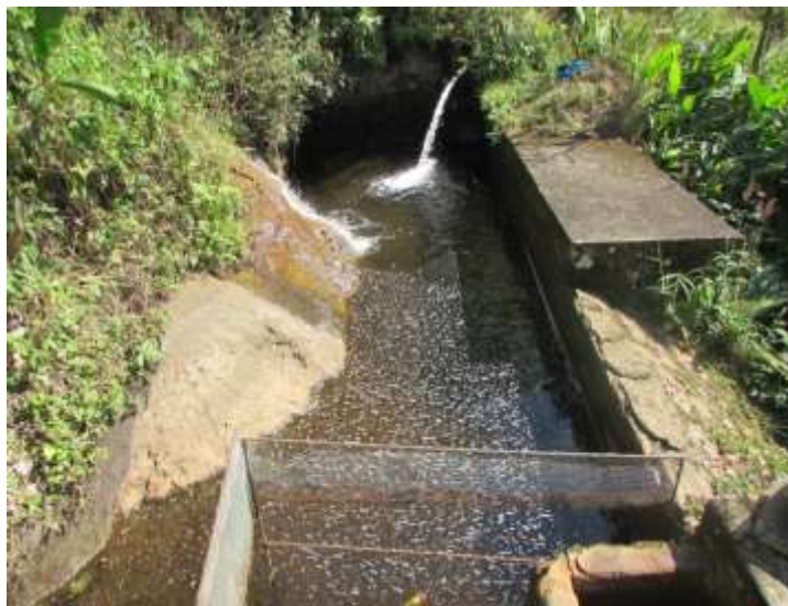
Figura 14 - Captação superficial de água da sede
