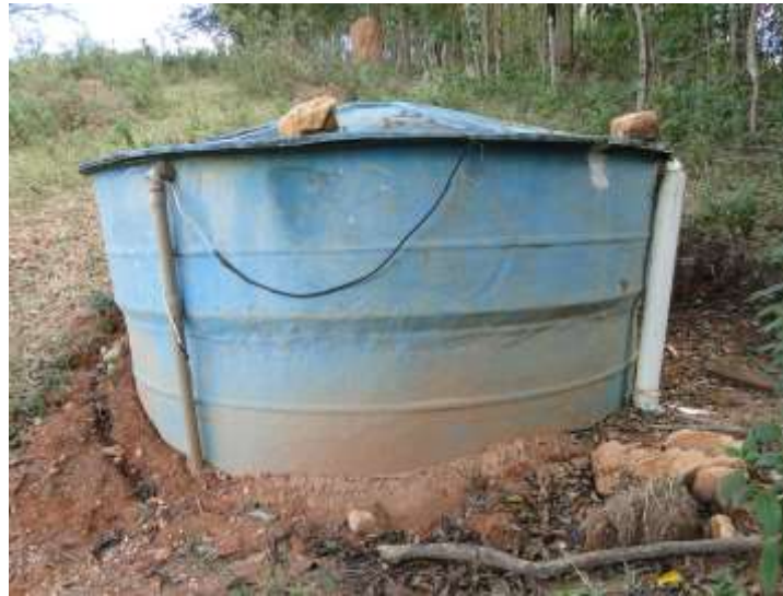
Figura 30 - Reservatório da captação subterrânea de água de Palmital dos Carvalhos
