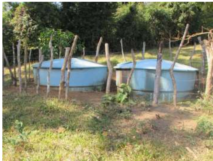
Figura 32 - Reservatório da captação superficial de água de Japão
