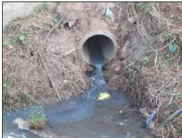
Figura 81 - Lançamento de águas pluviais sem dissipação de energia na sede do município
