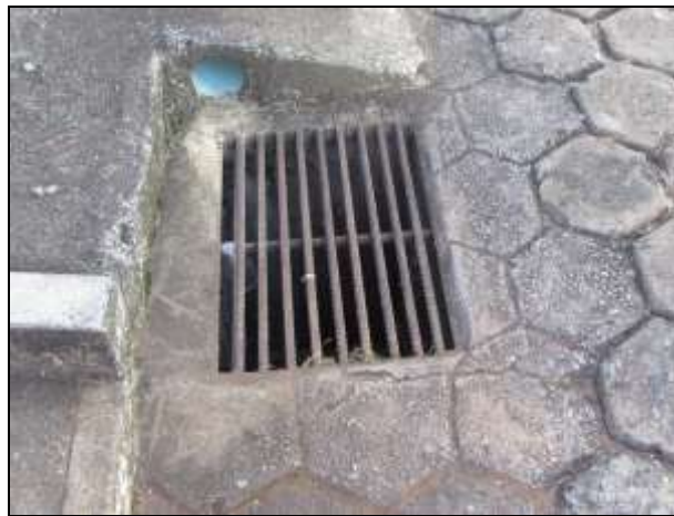
Figura 78 - Boca de lobo na sede do município
