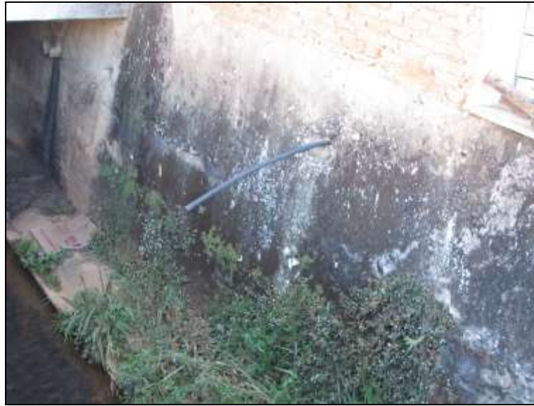
Figura 82 - Lançamento de esgoto in natura no córrego Lava-Pés na sede do município
