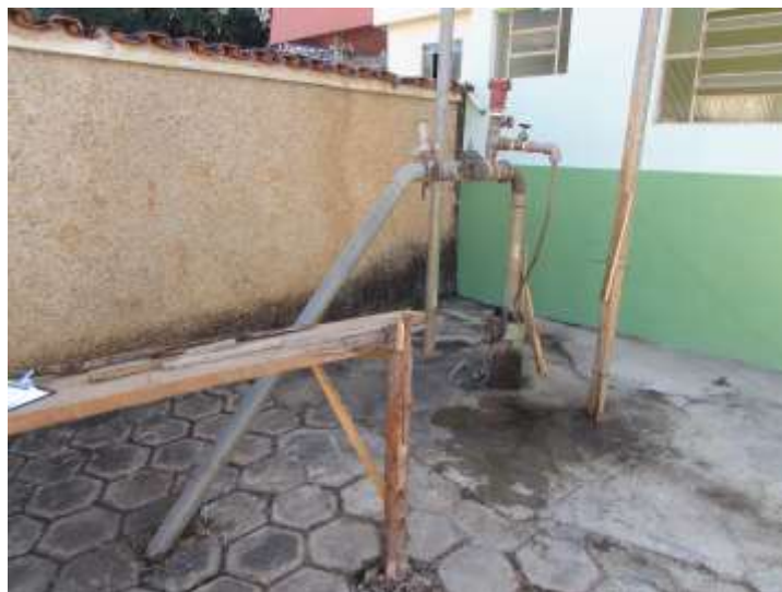
Figura 21 - Captação Superficial de Água da sede
