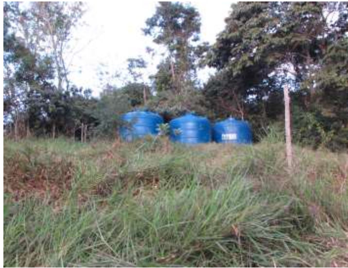
Figura 18 - Reservatórios de água do Poço 01
