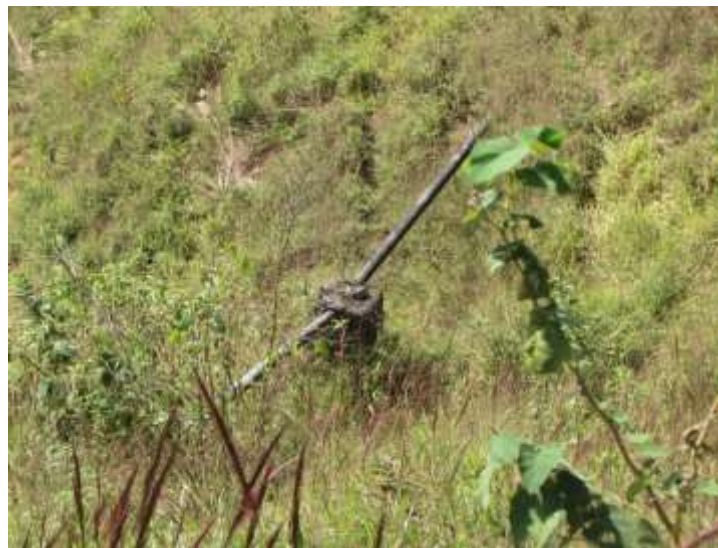
Figura 15 - Adutora de água bruta da captação superficial da sede
