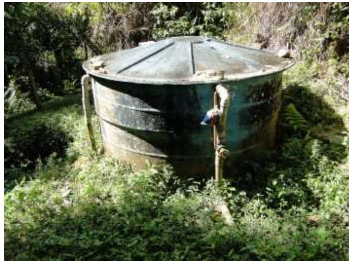
Figura 26 - Reservatório da captação superficial de água de Palmital dos Carvalhos
