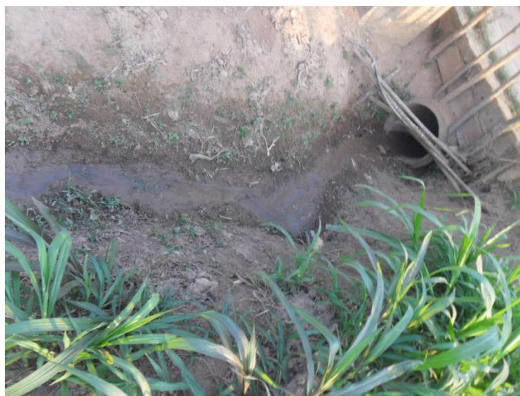
Figura 57 - Lançamento de esgotos de Terras 02
