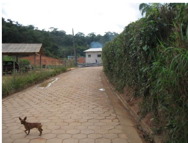
a- Via pavimentada sem microdrenagem
