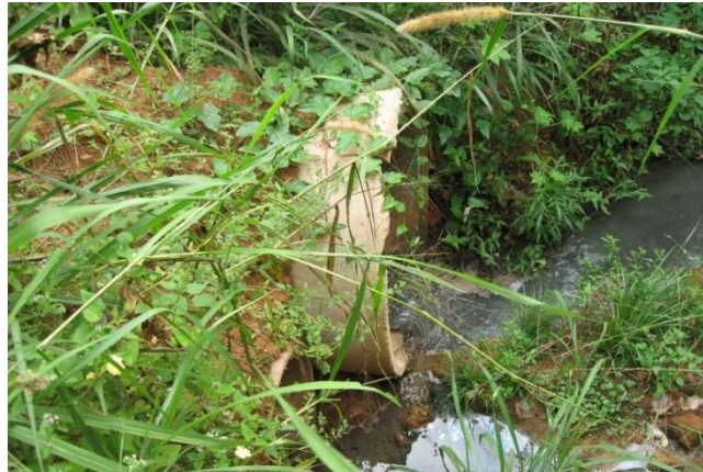
Figura 51 - Lançamento de esgotos 05
