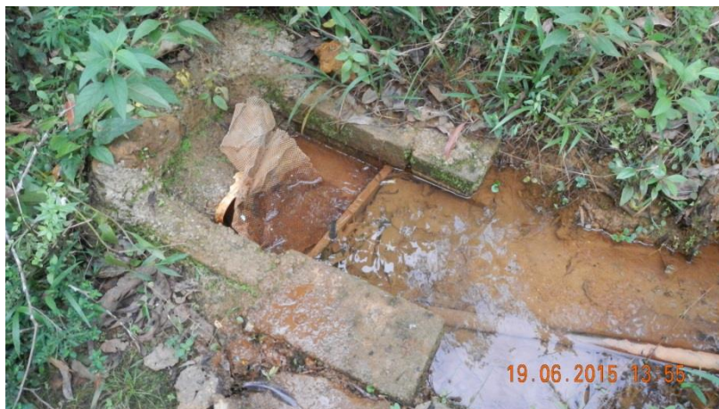
Figura 36 - Captação de água de Fonseca - córrego Togó (Captação 03)
