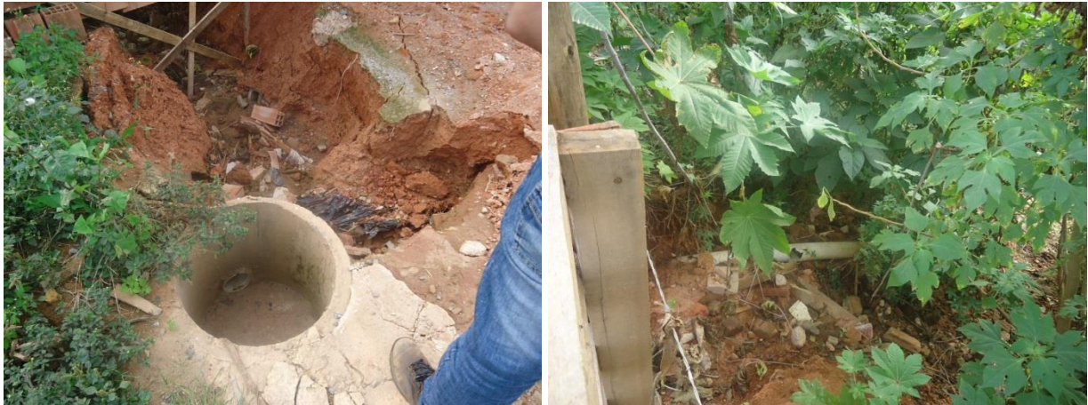
Figura 48 - Lançamento de esgotos 02
