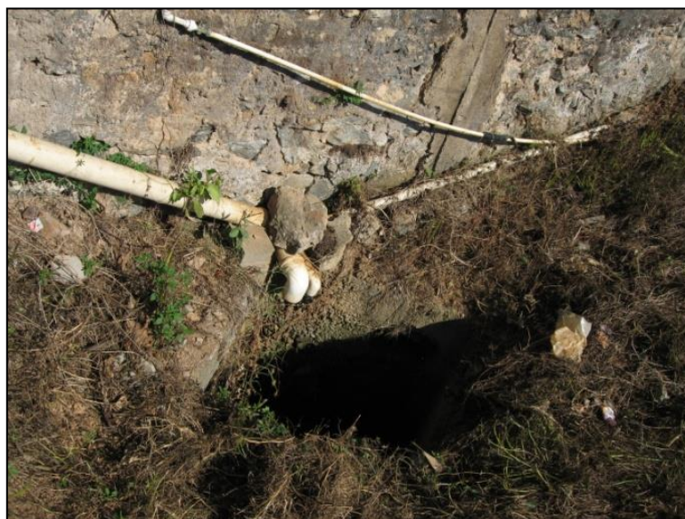
Figura 73 - Lançamento de esgoto na rede de microdrenagem
