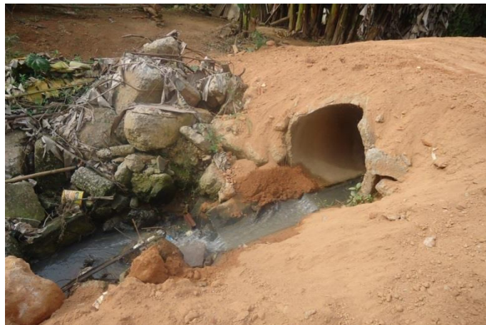
Figura 49 - Lançamento de esgotos 03
