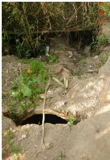
Figura 55 - Rede de esgoto rompida localizada aos fundos de uma residência em Fonseca
