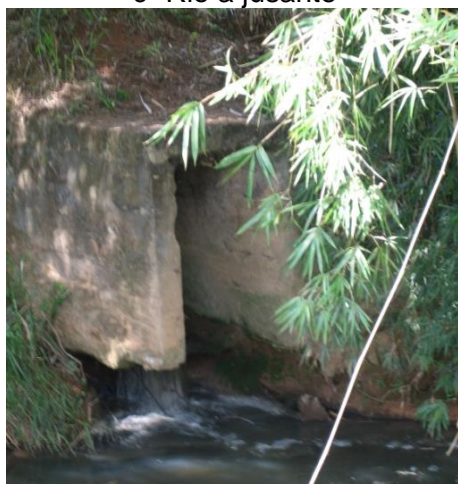
e- Grande descarga de esgoto in natura
