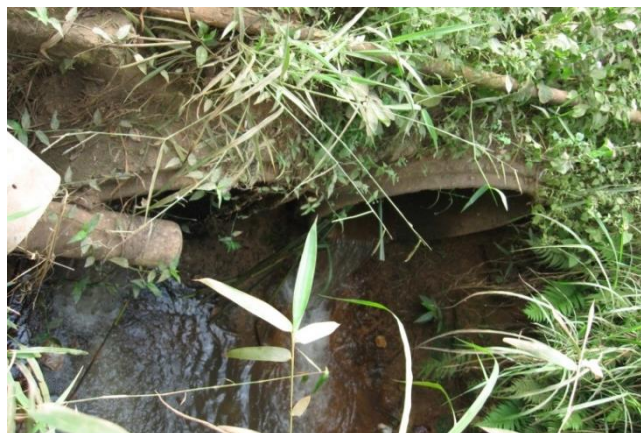
Figura 50 - Lançamento de esgotos 04
