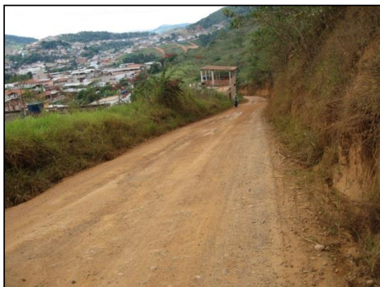
Figura 104 - Pequenas erosões ligadas à falta de pavimentação
