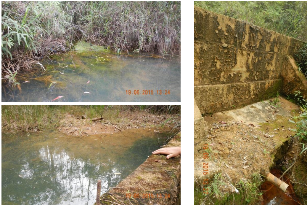
Figura 37 - Captação de água de Fonseca - Nascente represada (Captação 04)
