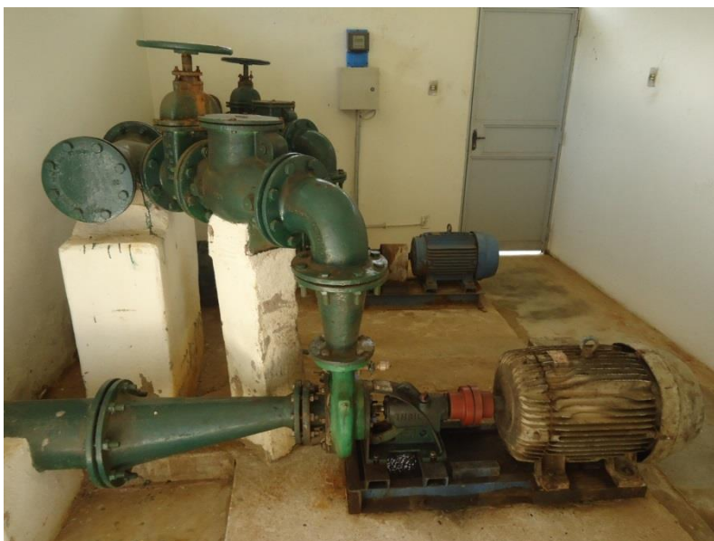
Figura 17 - Estação elevatória de água tratada da ETA da sede
