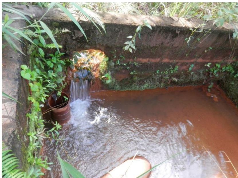
Figura 30 - Caixa de concreto utilizada para captação de Barretos de Alvinópolis
