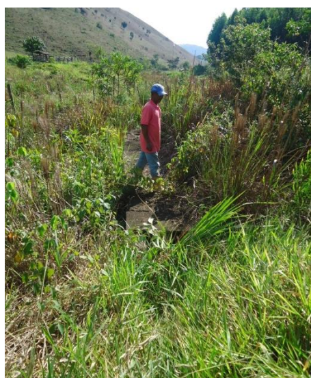
Figura 21 - Caixa de areia do sistema de adução de Major Ezequiel
