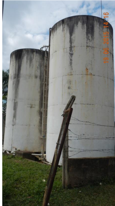
Figura 39 - Reservatório de água das captações superficiais de Fonseca
