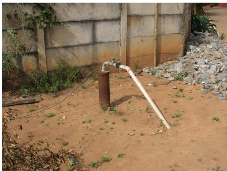
Figura 42 - Captação subterrânea de Gravatá
