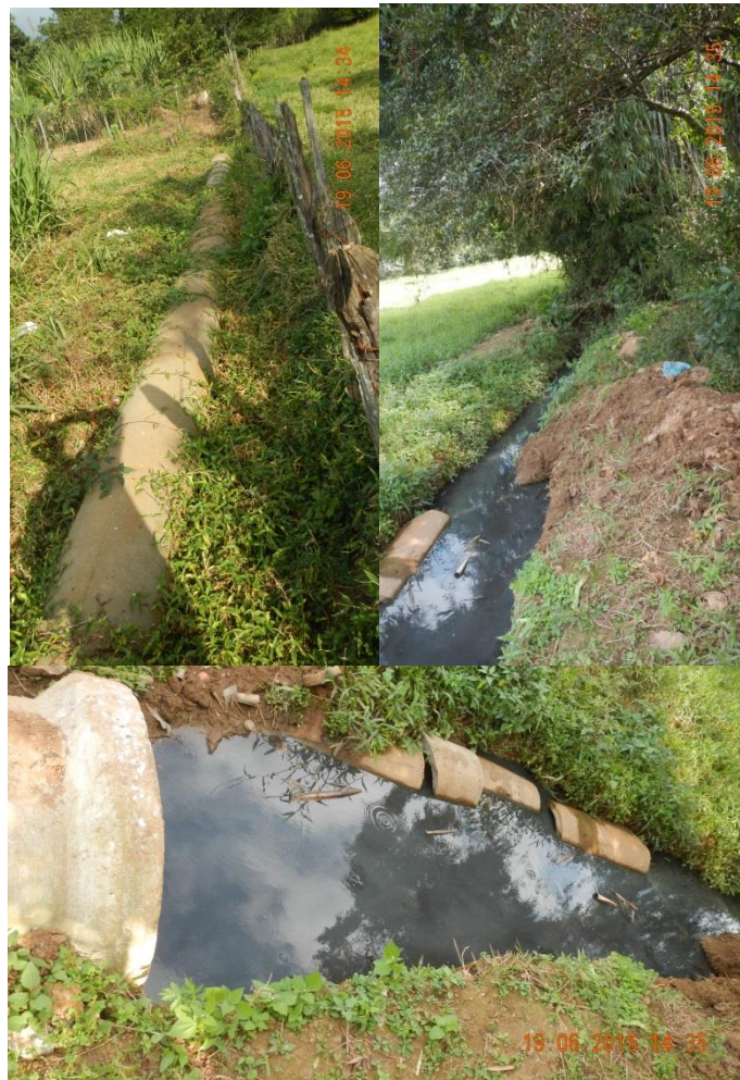
Figura 54 - Rede de esgoto de Fonseca
