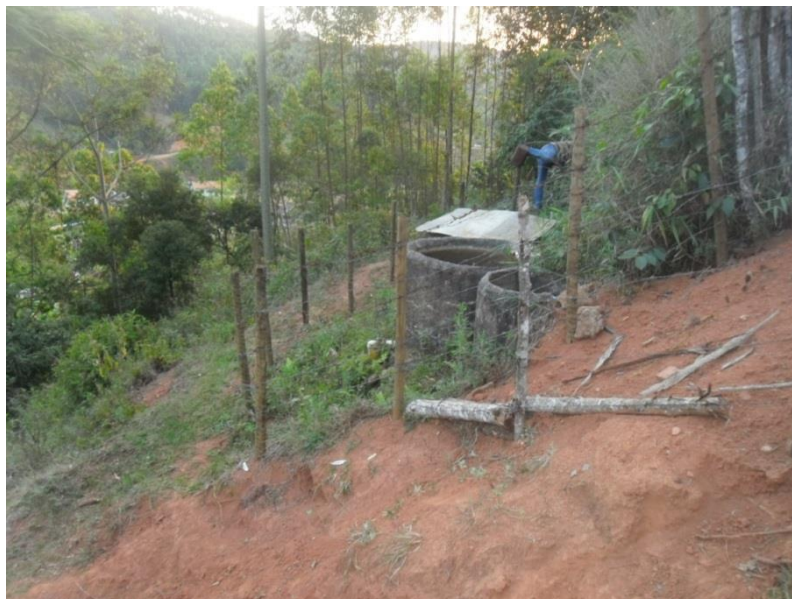
Figura 45 - Reservatório menor de água da captação superficial de Terras
