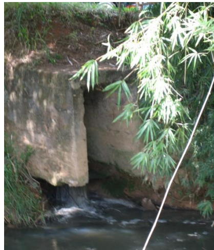
Figura 52 - Lançamento de esgotos 06
