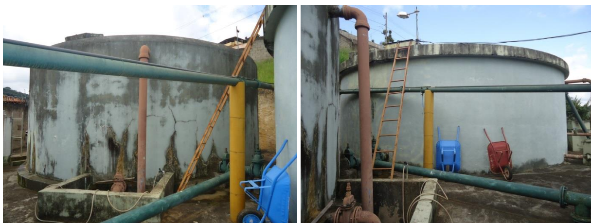
Figura 18 - Reservatórios principais de água tratada
