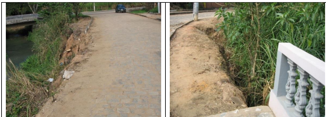
Figura 36 - Desestabilização de talude devido à ausência da infraestrutura de drenagem eficiente
