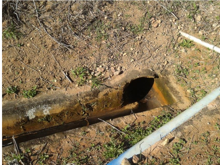
Figura 16 - Canaleta de águas pluviais da ETA, onde são dispostos os efluentes de lavagens
