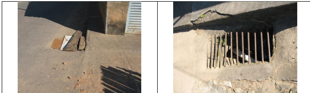
Figura 35 - Subutilização da rede de drenagem com lançamentos de esgoto.
