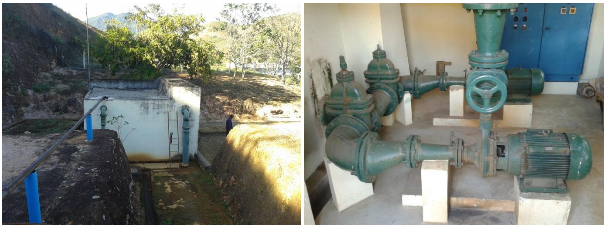
Figura 17 - estação elevatória de água tratada
