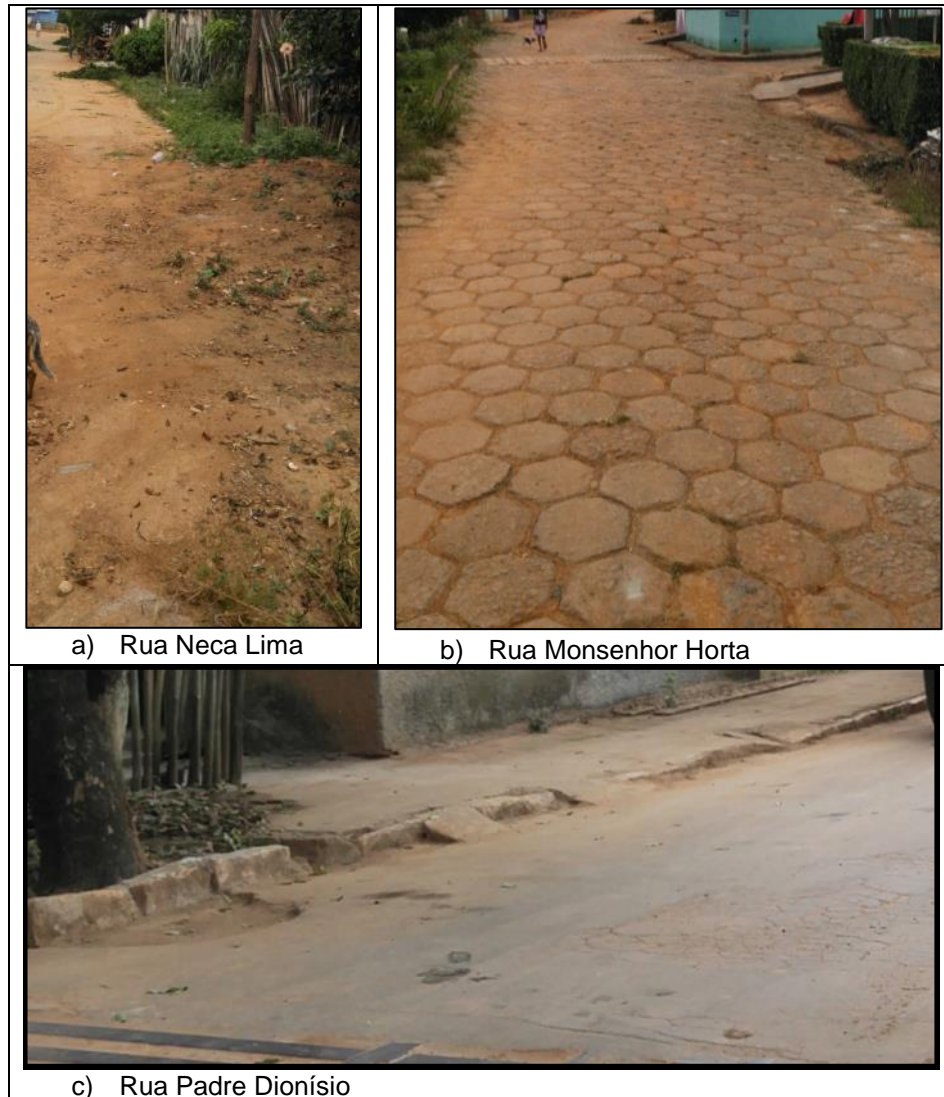
Figura 78 – Pontos com ausência de microdrenagem
