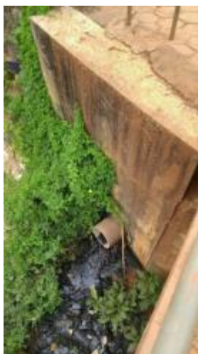
Figura 34 - Lançamento de esgotos no ponto 5
