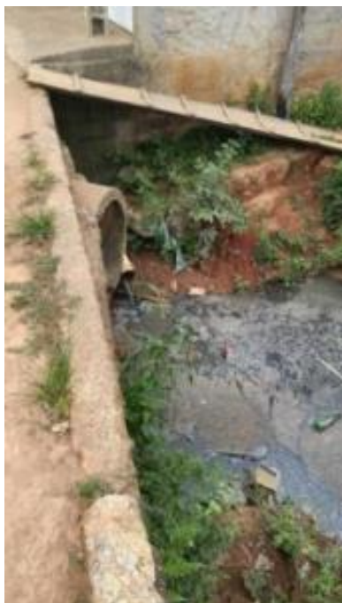
Figura 31 - Lançamento de esgotos no ponto 1
