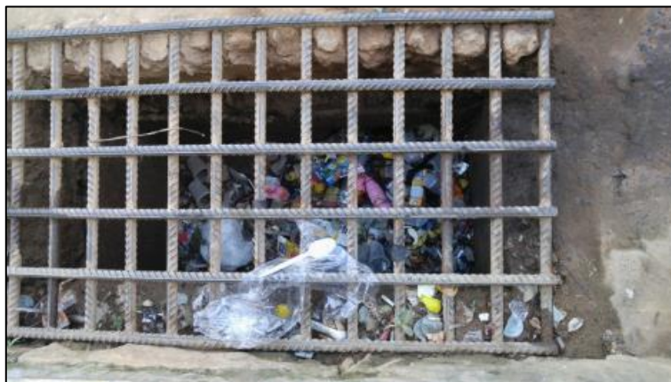
Figura 44 - Boca de lobo existente em Córrego Novo com resíduos sólidos e com grade removível
