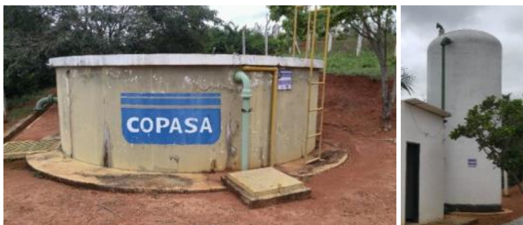
Figura 28 - Reservatórios de água tratada R2 (esq.) e R1 (dir.)
