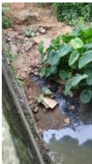
Figura 33 - Lançamento de esgotos no ponto 4
