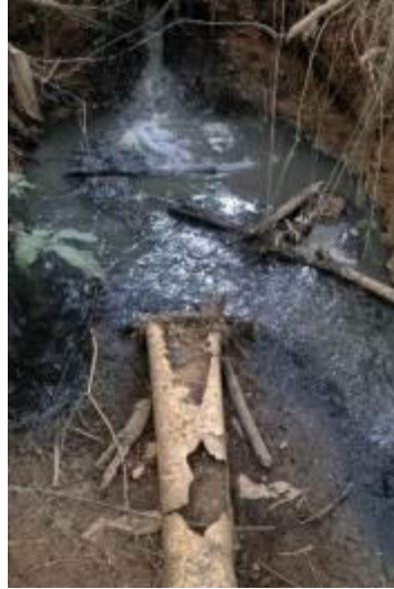
Figura 29 - Tubulação quebrada no ponto 3
