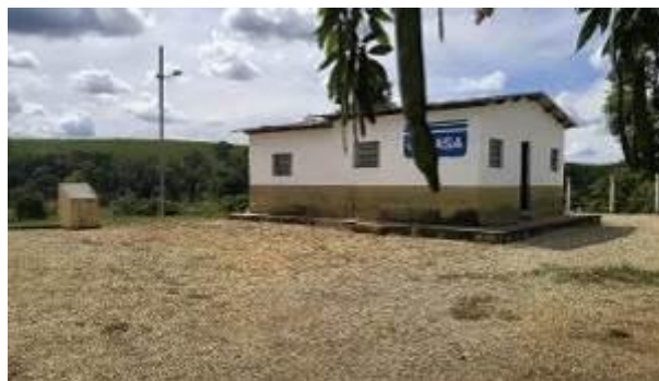
Figura 22 - Estação de Tratamento de Água da sede
