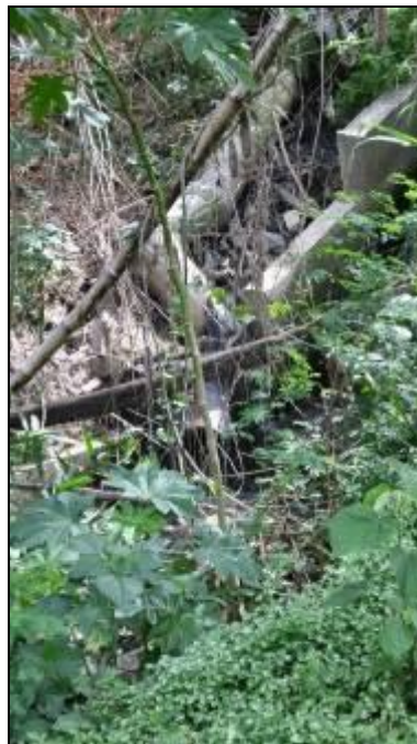
Figura 42 - Ponto de lançamento de águas pluviais 1 em conjunto com lançamento de esgotos
