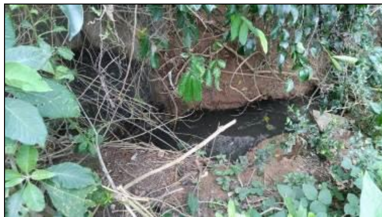
Figura 47 - Rede de drenagem no ponto de lançamento de águas pluviais 2
