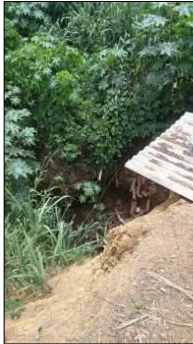
Figura 50 - Lançamento de águas pluviais 4 e processo erosivo
