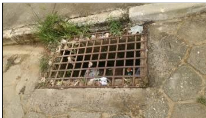
Figura 40 - Boca de lobo existente em Pingo-d'Água com resíduos sólidos
