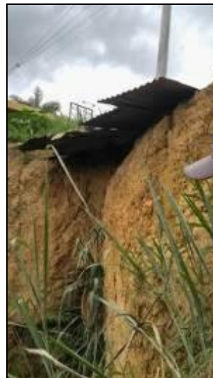
Figura 51 - Lançamento de águas pluviais 4 e processo erosivo
