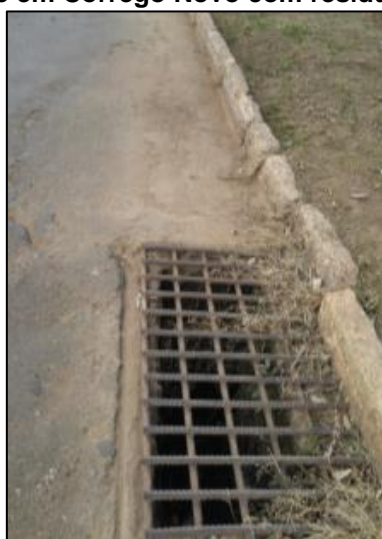
Figura 45 - Boca de lobo existente em Córrego Novo com resíduos sólidos e com grade removível
