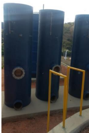
Figura 25 - Filtros recém-instalados na ETA
