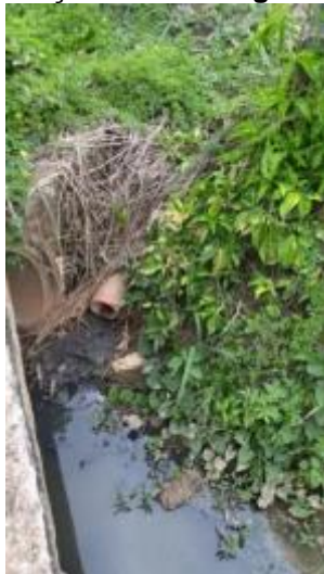
Figura 32 - Lançamento de esgotos no ponto 3
