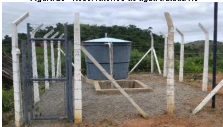
Figura 29 - Reservatórios de água tratada R3
