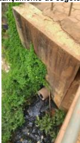
Figura 34 - Lançamento de esgotos no ponto 5
