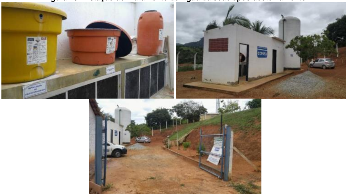
Figura 26 - Estação de Tratamento de Água da sede após destelhamento
