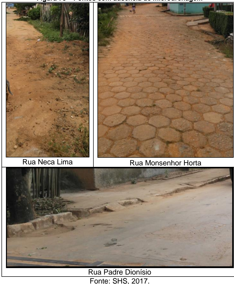
Figura 78 – Pontos com ausência de microdrenagem
