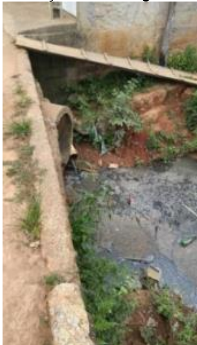
Figura 31 - Lançamento de esgotos no ponto 1
