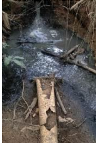
Figura 29 - Tubulação quebrada no ponto 3
