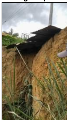
Figura 51 - Lançamento de águas pluviais 4 e processo erosivo
