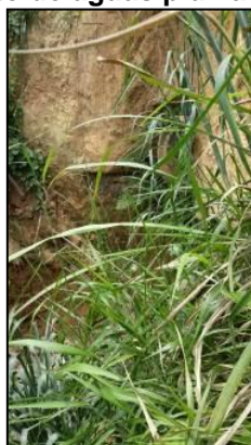
Figura 52 - Lançamento de águas pluviais 4 e processo erosivo
