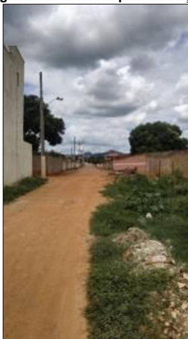
Figura 36 - Rua sem pavimentação
