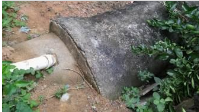
Figura 41 - Lançamento de esgotos na rede de drenagem do município
