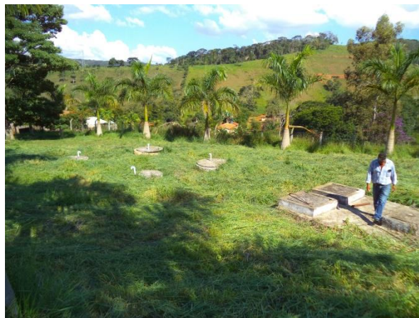
FIGURA 15 - SISTEMA DE TRATAMENTO DO CHORUME (FONTE: ACERVO DO AUTOR, 2014)
